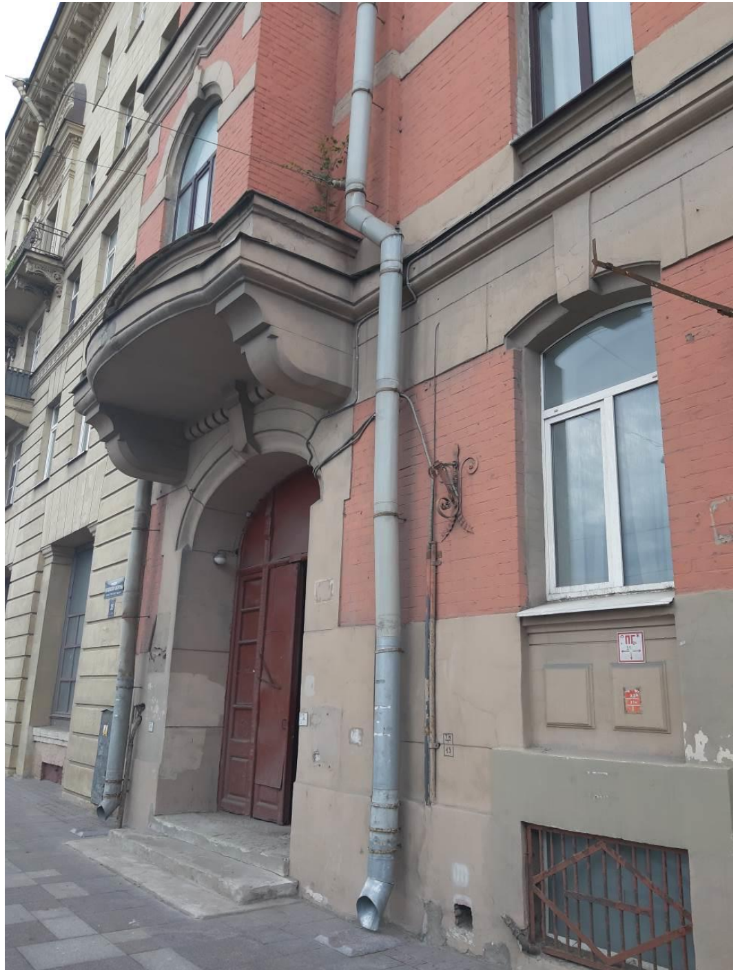
3. Дом причта церкви Божьей Матери Всех Скорбящих Радости. Обуховской Оборонной пр., д.33, лит.А. Фото мест расположения оборудования и размещения кабельных трасс. Штиглиц М.С. 05.06.2022.
