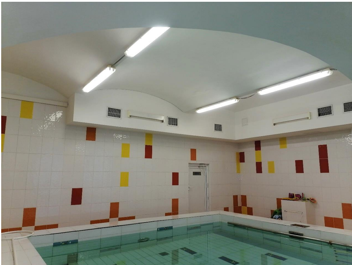
Фото 50. Здание детского отделения городской поликлиники №27. Лечебный бассейн на первом этаже. Пом.23 (1-Н). 12.10.2022г.
