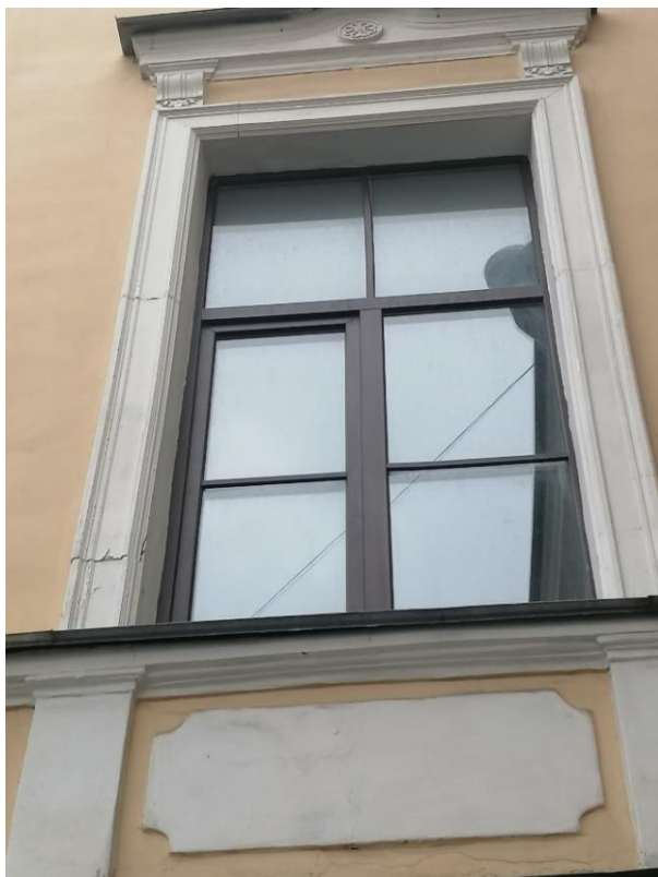
Фото 24. Здание детского отделения городской поликлиники №27. Состояние отделки оконного проема второго этажа западного дворового фасада. 12.10.2022г.
