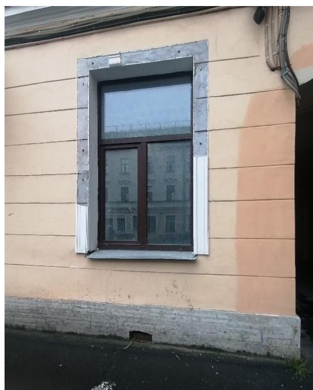
Фото 21. Здание детского отделения городской поликлиники №27. Состояние отделки оконного проема первого этажа западного дворового фасада у воротного проема. 12.10.2022г.
