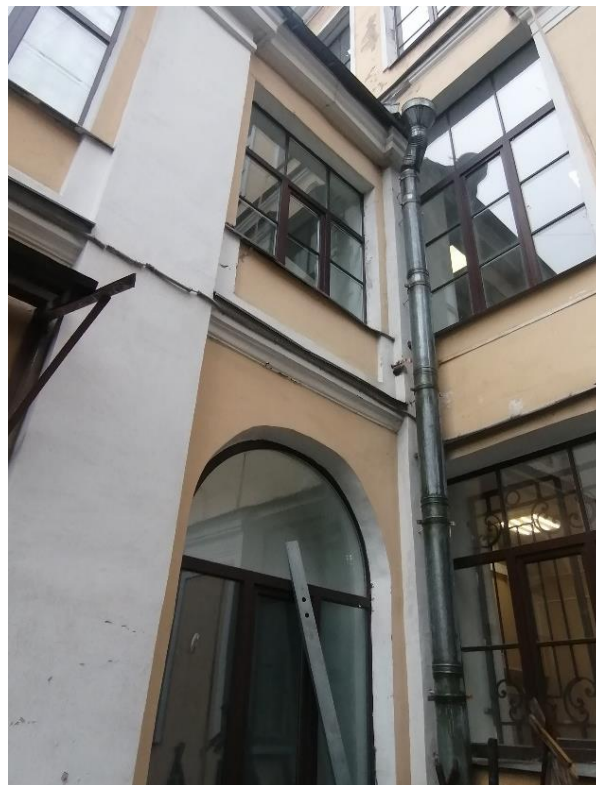
Фото 13. Здание детского отделения городской поликлиники №27. Фрагмент примыкания двух частей здания. 12.10.2022г.
