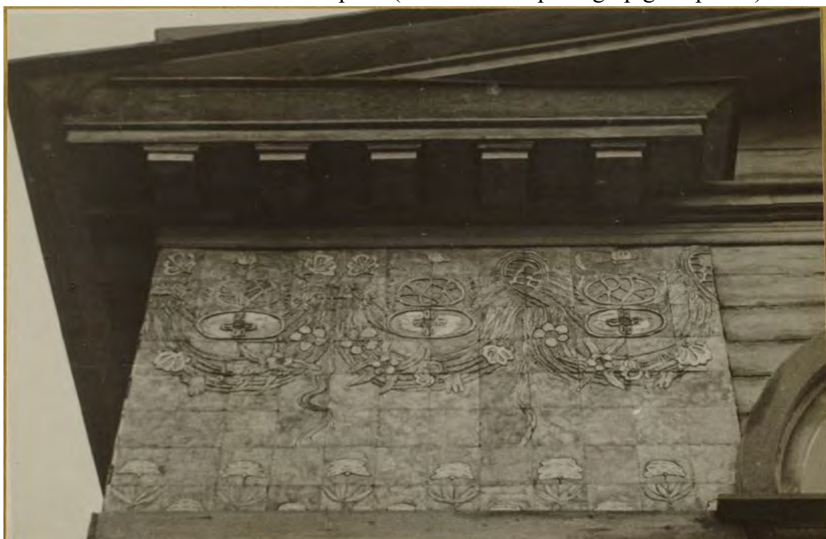
Илл. 87. Вид карниза снизу и керамич. украшение. Обмеры 1942 г. Кроки. Жилой дом № 37 по 12-й линии Васильевского Острова (источник: https://kgior.gov.spb.ru/ ).
