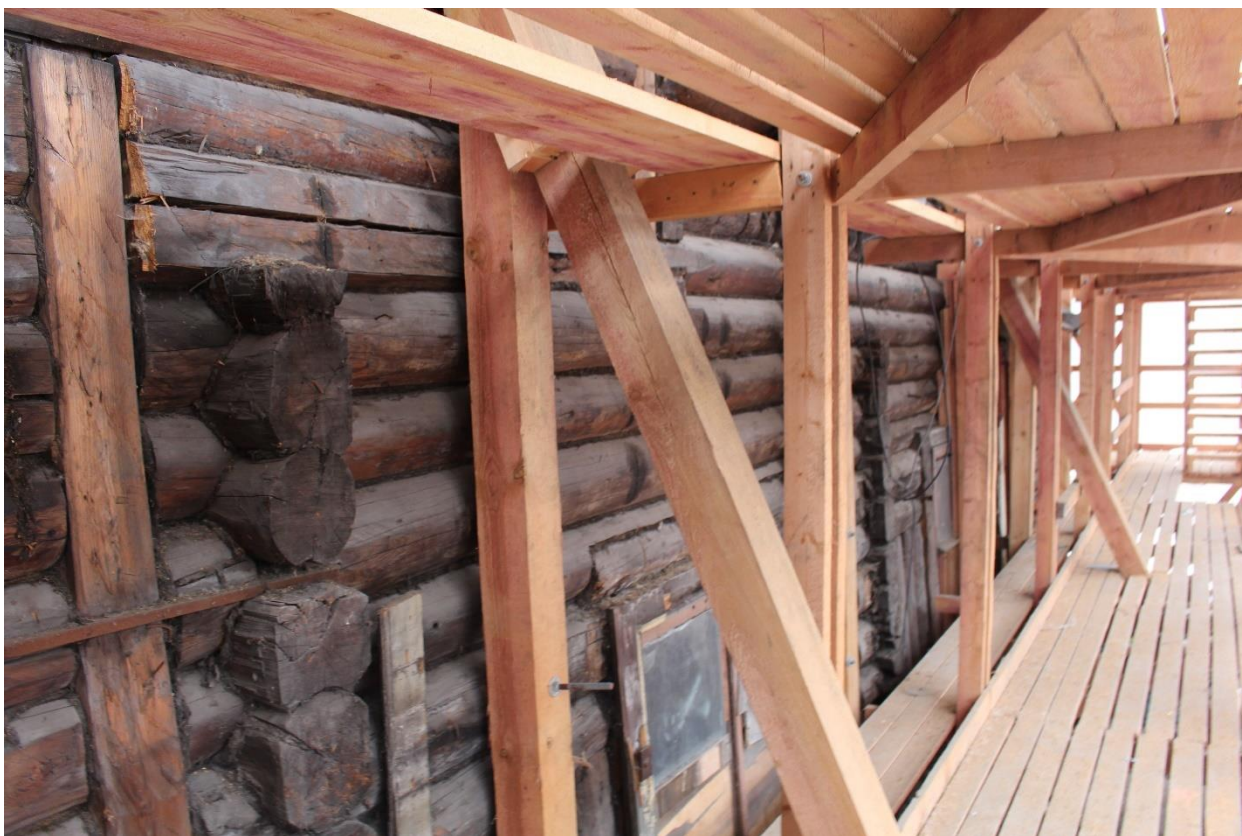
Фото 13. Вид на северо-восточный фасад объекта культурного наследия регионального значения «Особняк Э.Э. Бремме».
