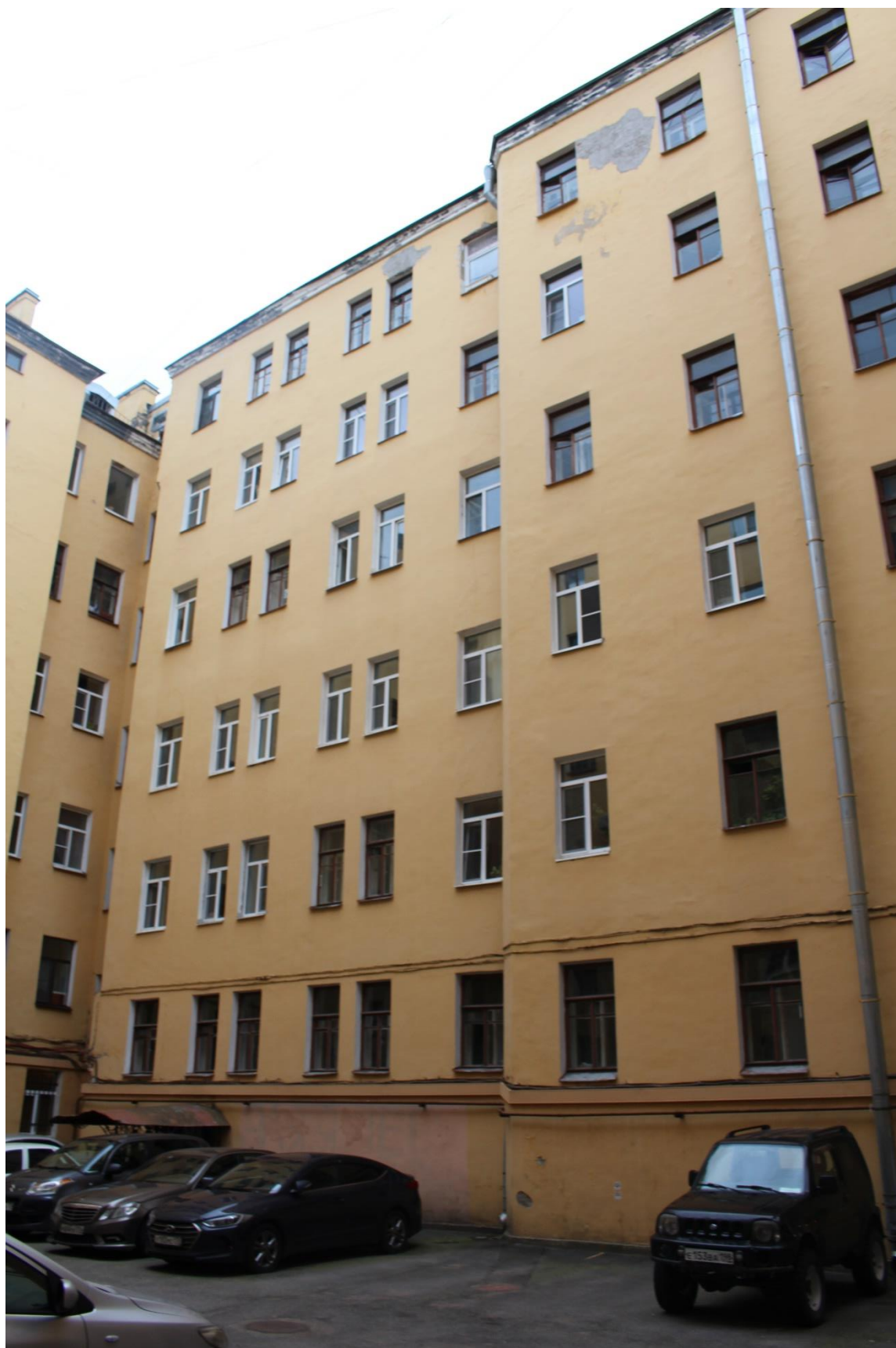
Фото 25. Вид на фасад южного дворового корпуса объекта культурного наследия регионального значения «Дом И.Д. Коробкова, В.Н. Самоцветовой».
