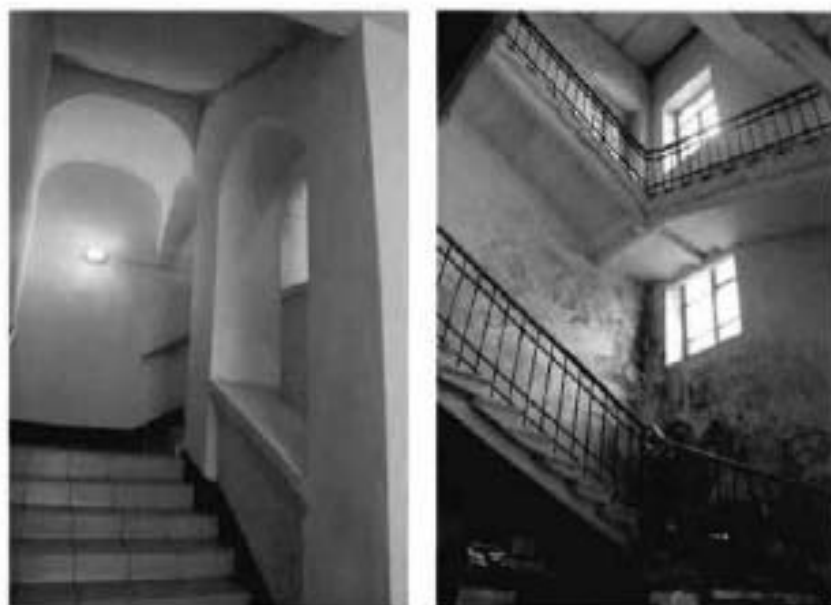
Фото №7, 8. Лестничные марши пом. 1-Н.
