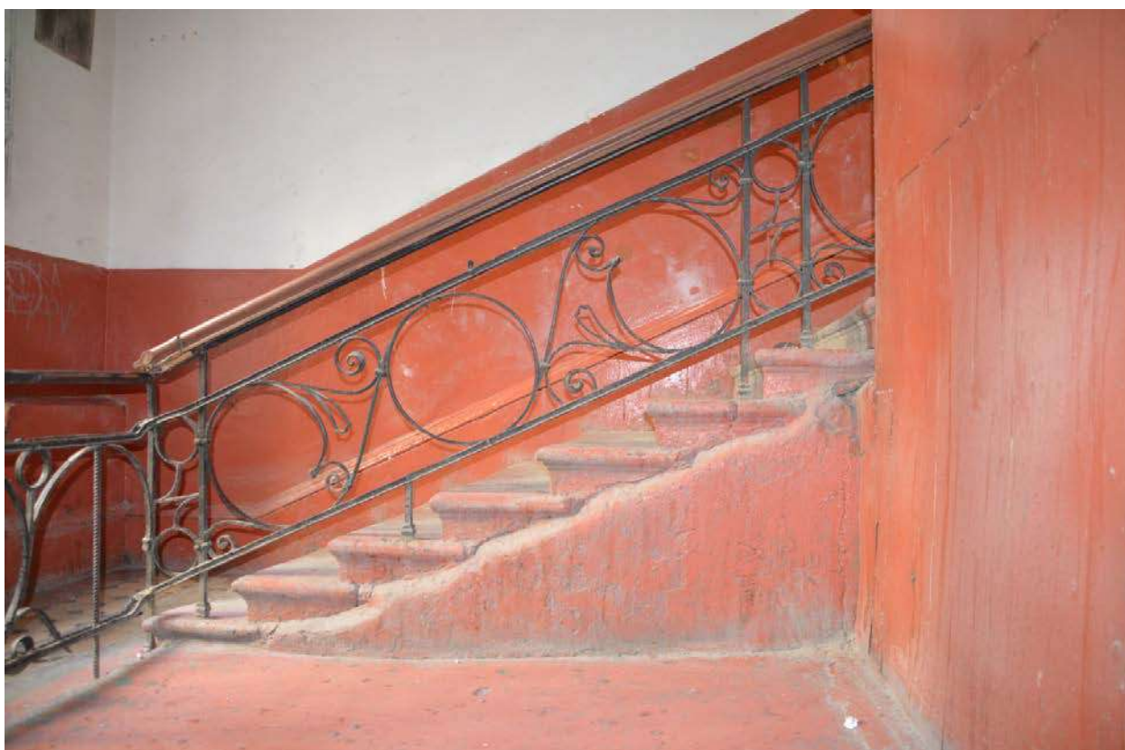
Фото 52. Выявленный объект культурного наследия «Дом П. М. Станового», расположенный по адресу Санкт-Петербург, 8-я Советская улица, д. 48, литера А. Ограждение лестницы. Съемка 26.04.2021. Егорова Т. Г.
