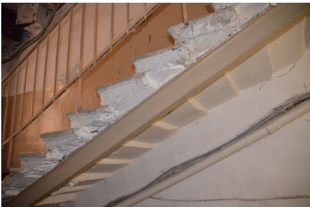
Фото 68. Выявленный объект культурного наследия «Дом П. М. Станового», расположенный по адресу Санкт-Петербург, 8-я Советская улица, д. 48, литера А. Вид конструкции черной лестницы. Съемка 26.04.2021.Егорова Т. Г.
