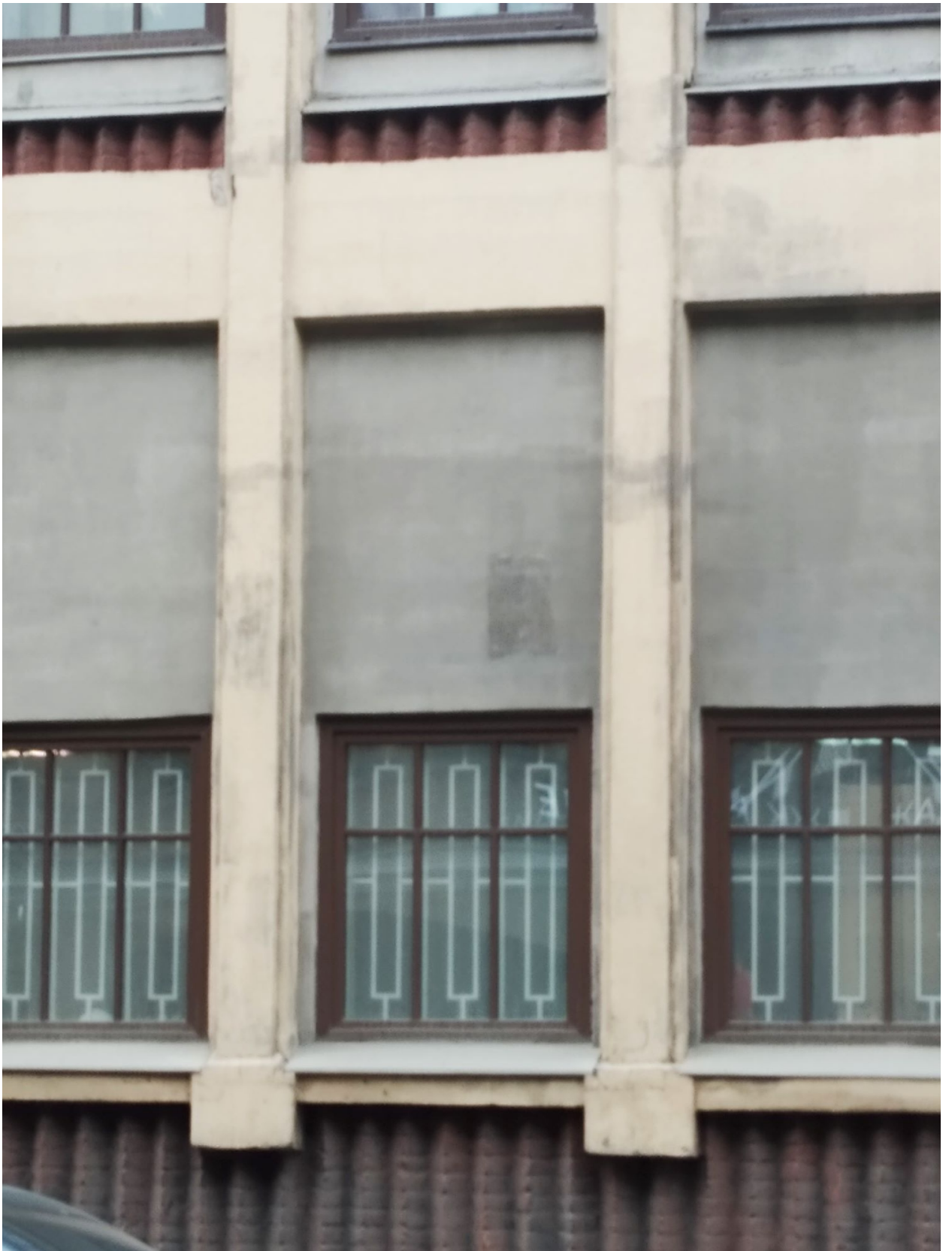
Фото 5. Фрагмент восточного фасада по Б. Сампсониевскому пр. Частично заложенные витражные заполнения 1-го этажа.
