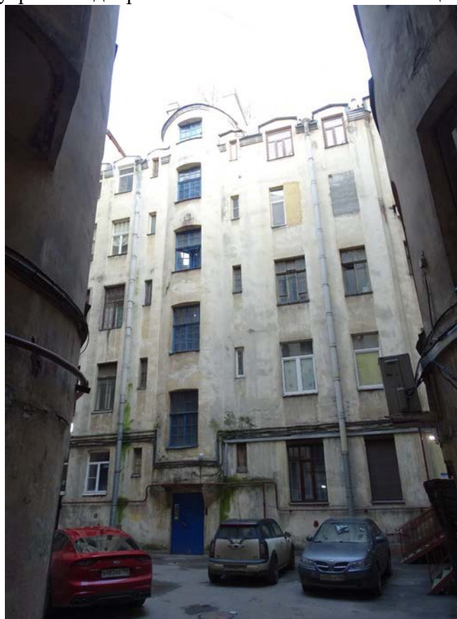
Фото 27. Здание по адресу: г. Санкт-Петербург, Большая Посадская, дом 1/10, литера А. Внутренний двор. Съемка 19.04.2021 г. Штиглиц М. С.
