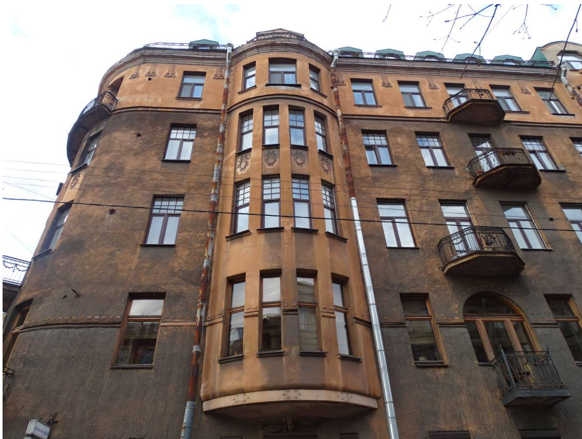
Фото 11. Здание по адресу: г. Санкт-Петербург, Большая Посадская, дом 1/10, литера А. Лицевой фасад по Малой Посадской ул. Фрагмент. Съемка 19.04.2021 г. Штиглиц М. С.
