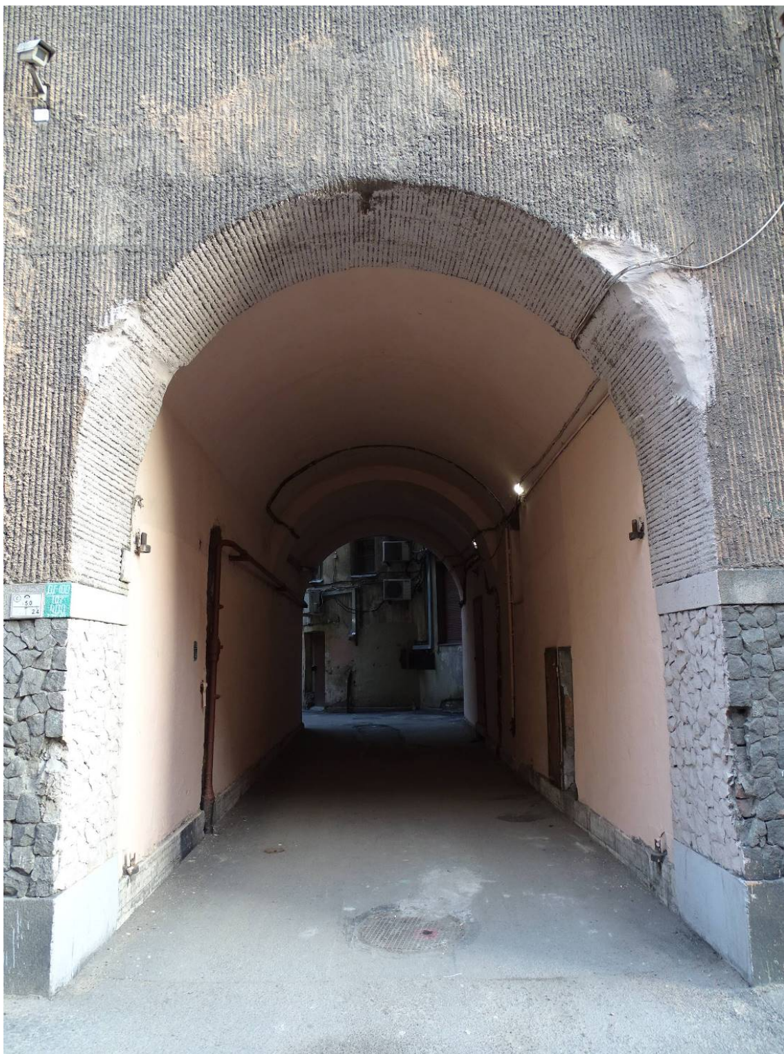
Фото 21. Здание по адресу: г. Санкт-Петербург, Большая Посадская, дом 1/10, литера А. Въездная арка с Большой Посадской ул. Съемка 19.04.2021 г. Штиглиц М. С.
