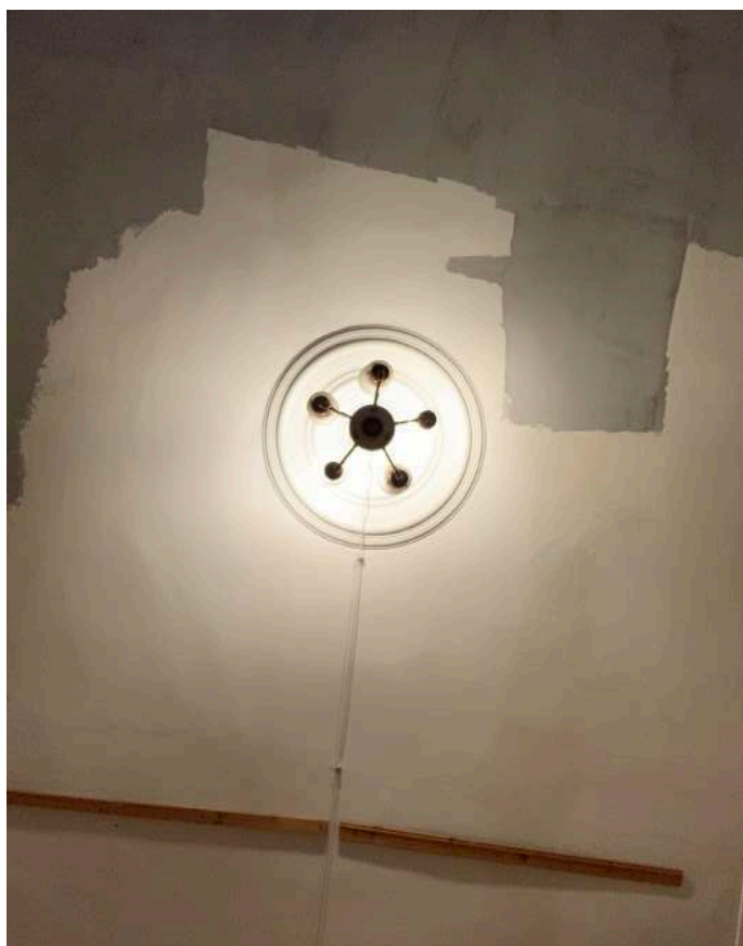
Фото №22. Фрагмент потолка помещения. Разетка (пом.№3 согласно плану ПИБ)
