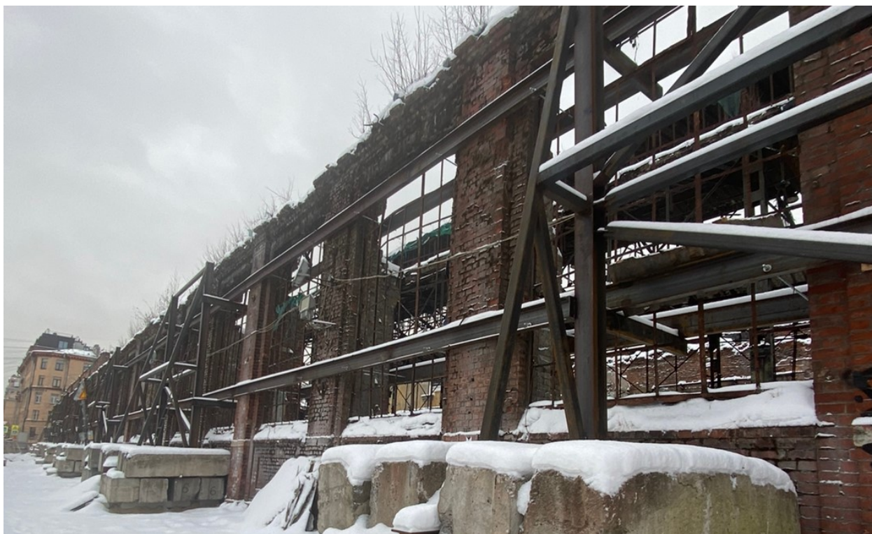
Фото 2. Лицевой (северный) фасад по ул. Фокина, вид в сторону Большого Сампсониевского пр. Обзор фасада затруднен из-за строительного забора. Покрытие кровли и световой фонарь демонтированы, ввиду аварийного состояния здания.
