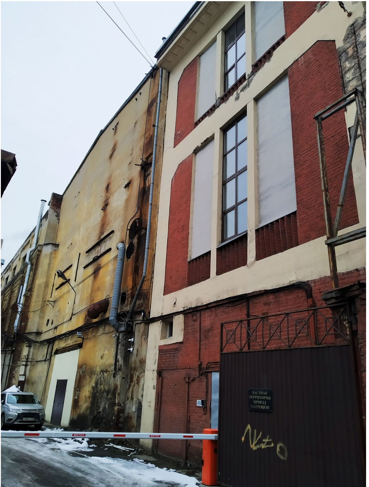
Фото 4. Южный фасад. Железобетонный каркас, заполнения межкаркасного пространства красным кирпичем и витражными проемами, частично заложеными.
