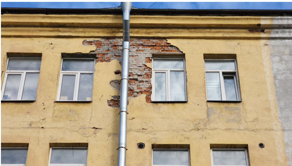
Фото 5. Литера А со стороны заднего двора. Утрата штукатурки в уровне 4-го этажа.
