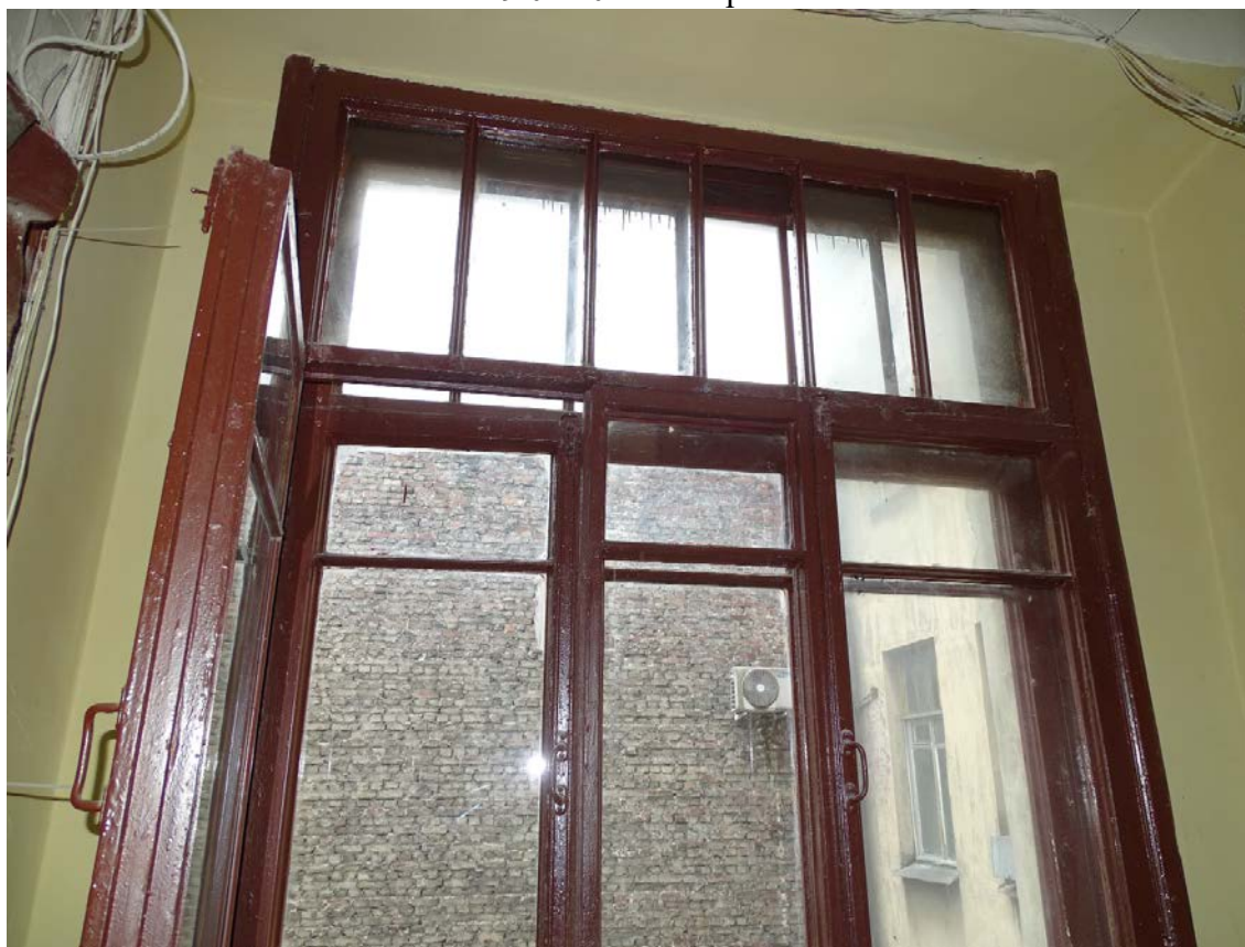
Фото 53. Лестница № 2. 5 этаж. Оконное заполнение. Съемка 19.04.2021 г. Кириков Б. М.
