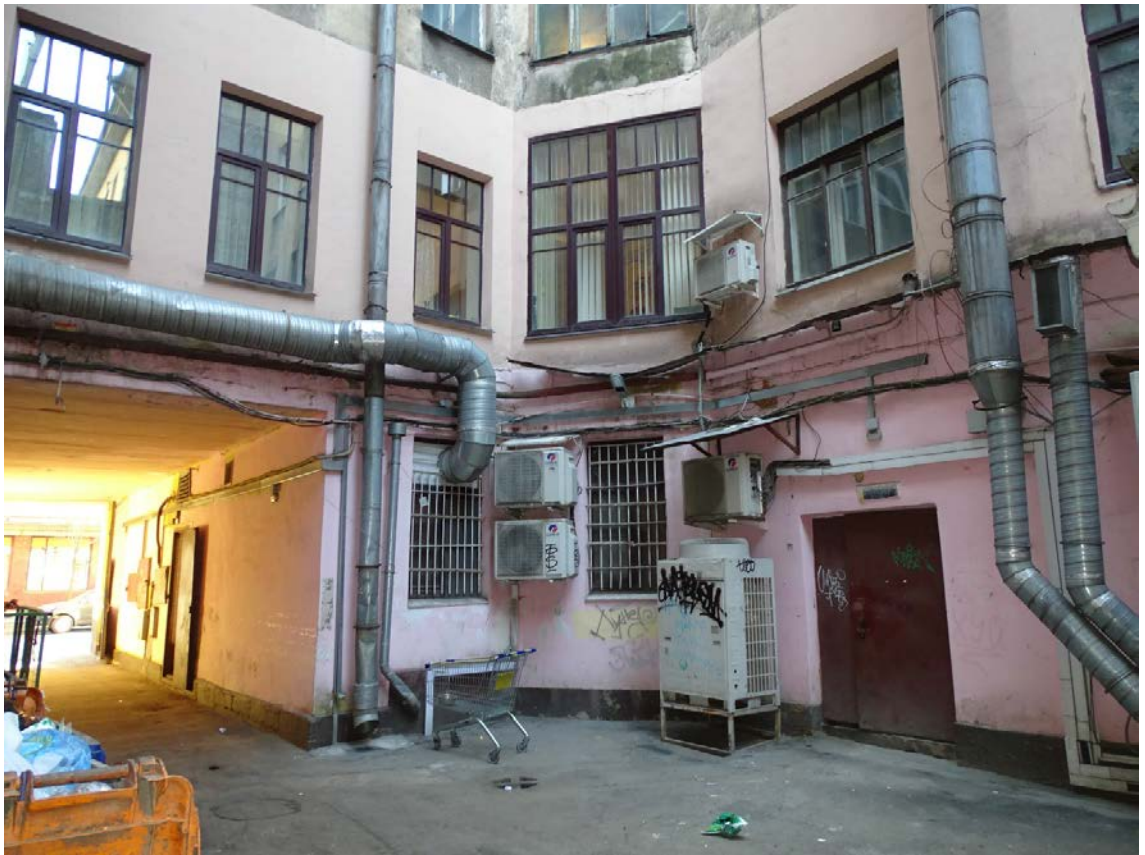
Фото 31. Здание по адресу: г. Санкт-Петербург, Средний пр. В. О., д. 56, литера А. Фрагмент дворового фасада. Съемка 19.04.2021 г. Кириков Б. М.
