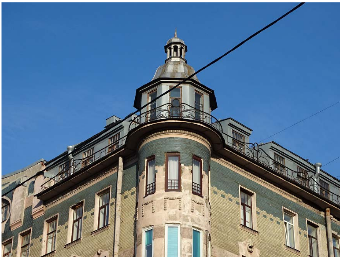
Фото 3. Здание по адресу: г. Санкт-Петербург, Средний пр. В. О., д. 56, литера А. Вид с пересечения 14-й линии и Среднего пр. Фрагмент. Съемка 19.04.2021 г. Кириков Б. М.
