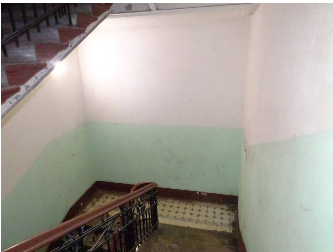
Фото 26. Лестница № 1. Площадка между 5-м и 6-м этажом. Съемка 19.04.2021 г. Кириков Б. М.,
