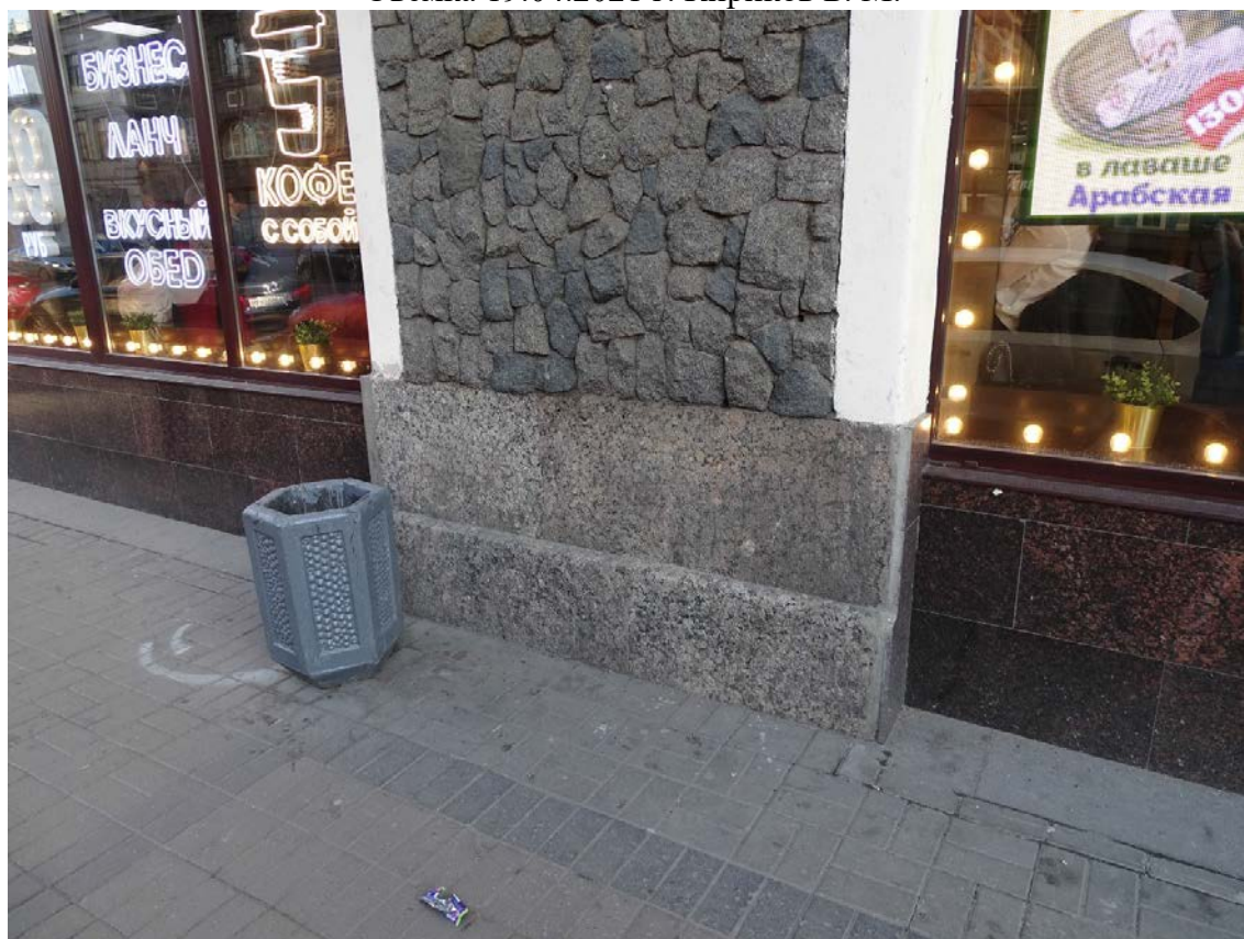
Фото 16. Здание по адресу: г. Санкт-Петербург, Средний пр. В. О., д. 56, литера А. Фрагмент лицевого фасада по 14-й линии. Гранитный цоколь. Съемка 19.04.2021 г. Кириков Б. М.
