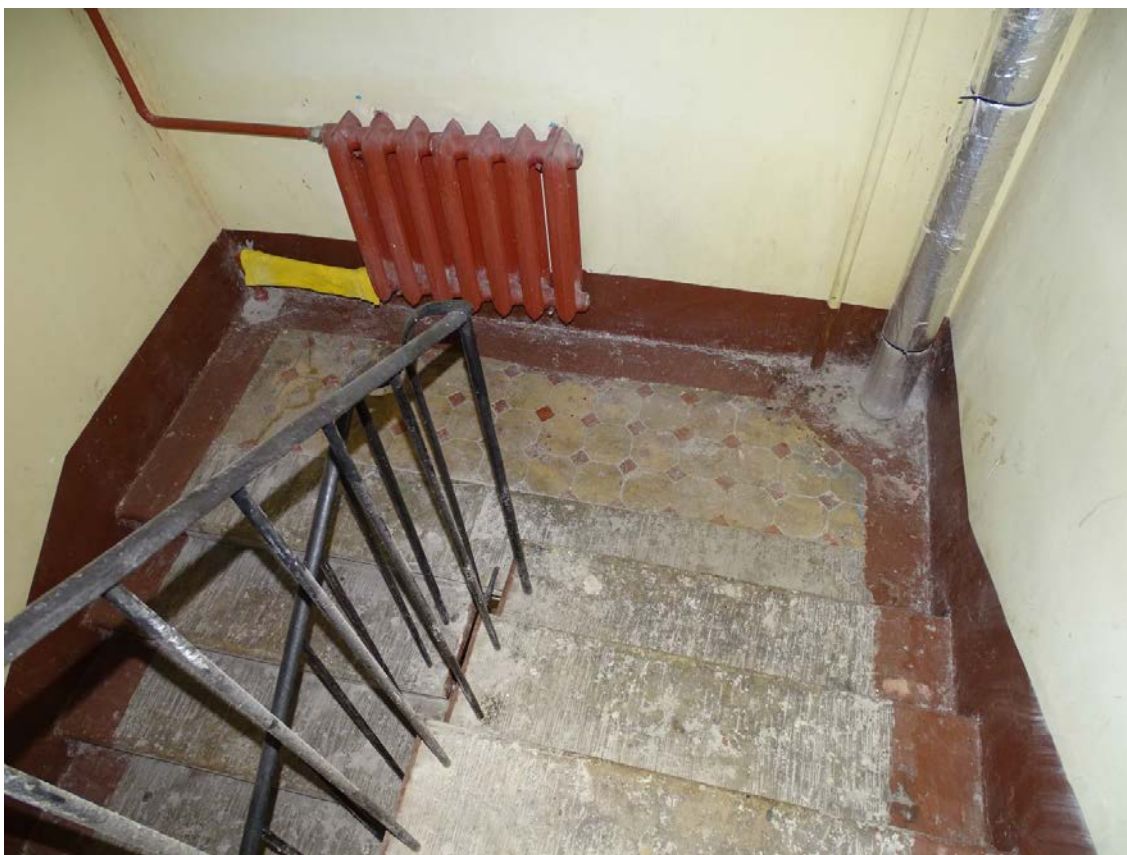
Фото 57. Лестница № 2. Площадка между 5-м и 6-м этажом. Съемка 19.04.2021 г. Кириков Б. М.
