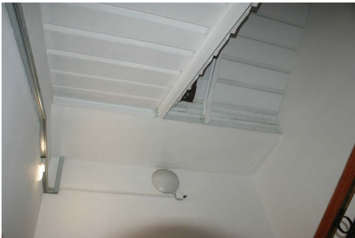
Фото 9. Лестница № 1. Площадка между 1-м и 2-м этажом. Оформление потолка. Съемка 19.04.2021 г. Кириков Б. М.
