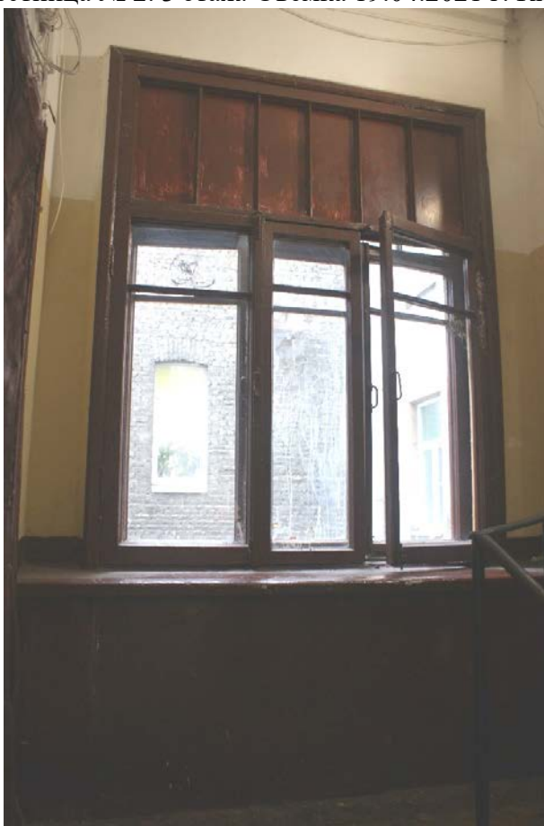
Фото 45. Лестница № 2. 3 этаж. Оконное заполнение. Съемка 19.04.2021 г. Кириков Б. М.
