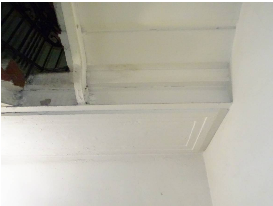
Фото 25. Лестница № 1. Площадка между 5-м и 6-м этажом. Оформление потолка. Съемка 19.04.2021 г. Кириков Б. М.
