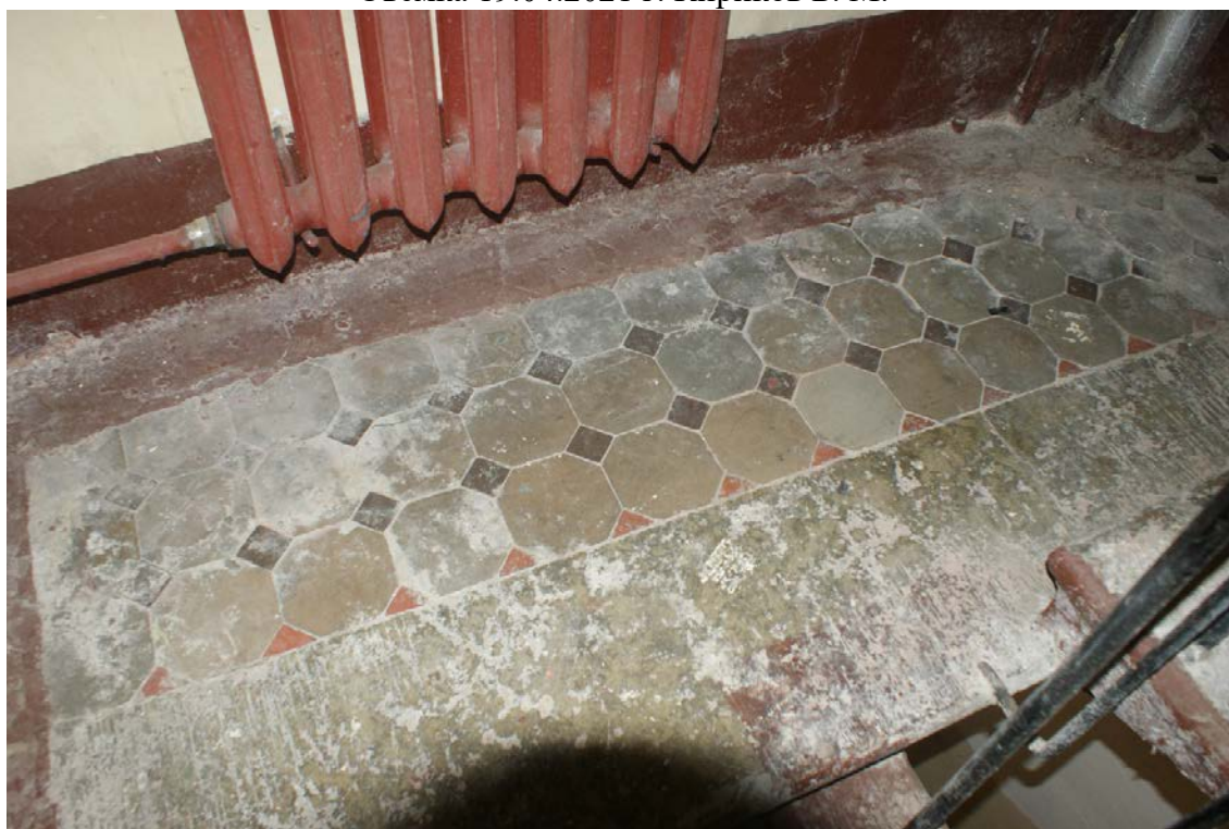
Фото 43. Лестница № 2. Площадка между 2-м и 3-м этажом. Оформление пола. Съемка 19.04.2021 г. Кириков Б. М.
