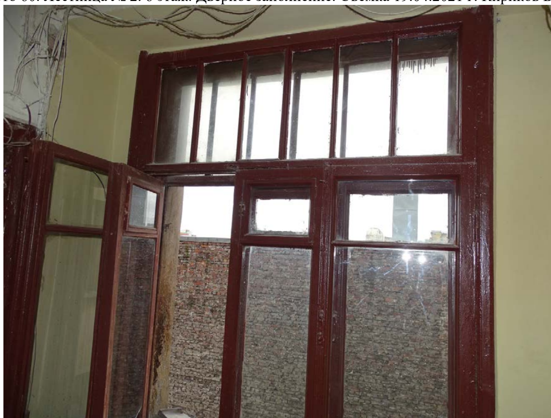
Фото 61. Лестница № 2. 6 этаж. Оконное заполнение. Съемка 19.04.2021 г. Кириков Б. М.
