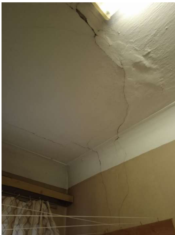
Фото 40 Помещение 14 Постирочная. Трещины по потолку и перегородке
