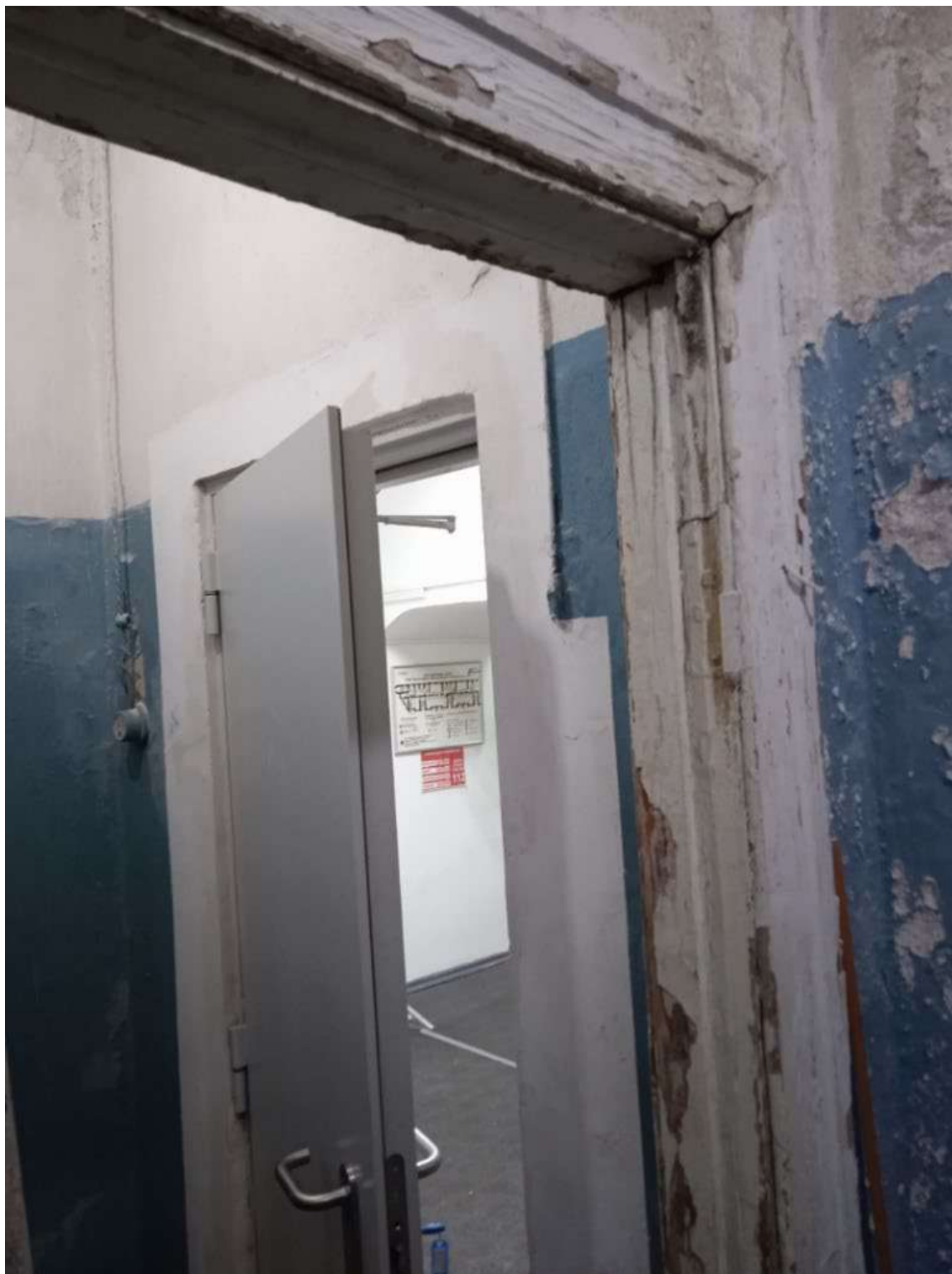
Фото 24. Помещение 8 и 9 Деструкция штукатурки, шелушение и отслоение окрасочных слоев.
