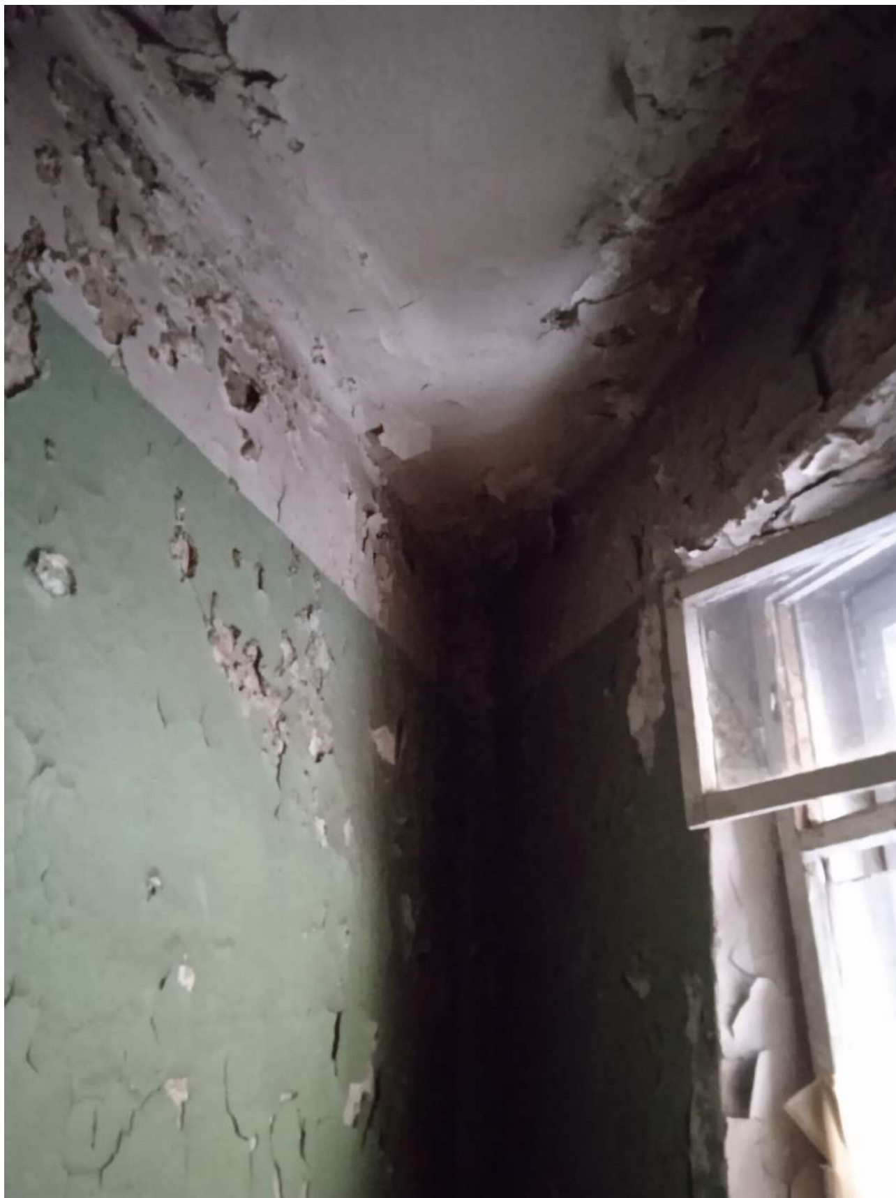
Фото 55 Помещение 22 Биопоражение, деструкция окрасочного и штукатурного слоя
