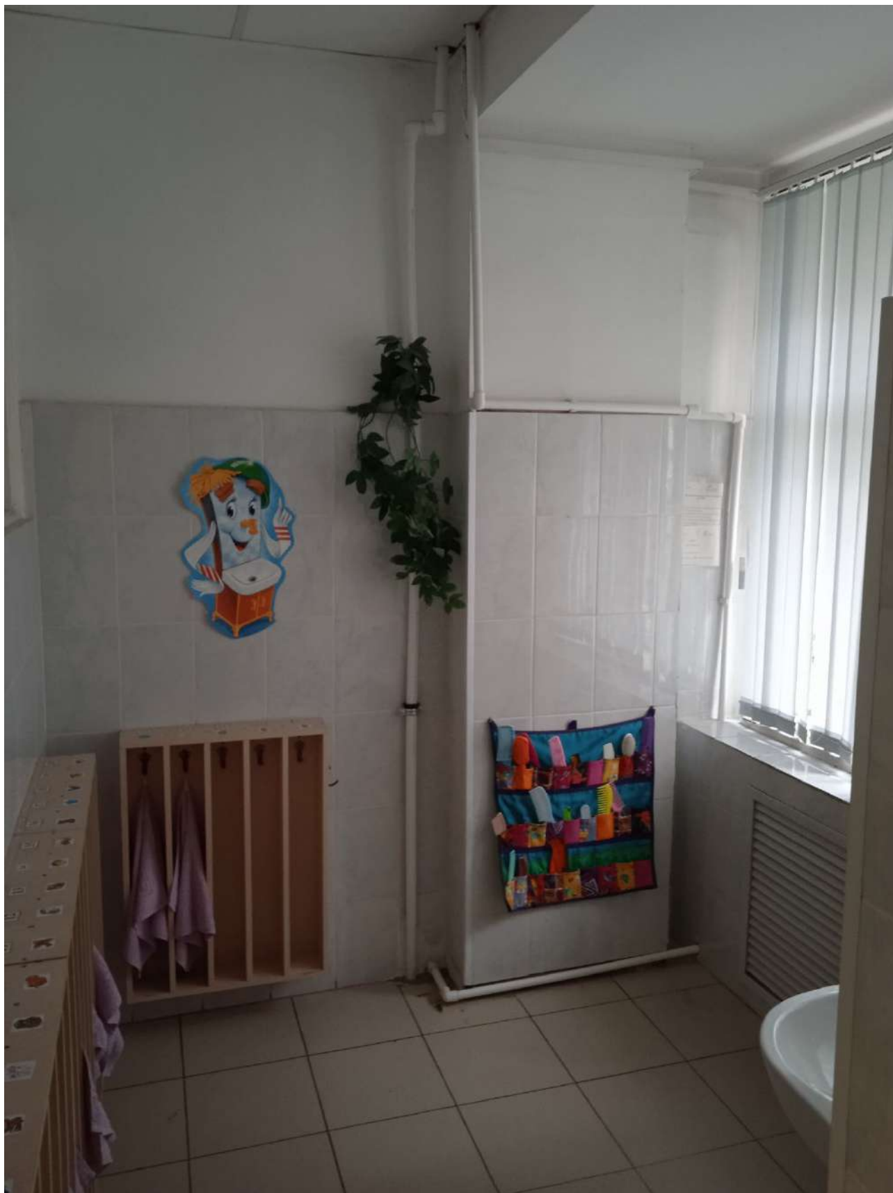
Фото 14. Помещение 4. Санузел. Следы протечек на подвесном потолке.
