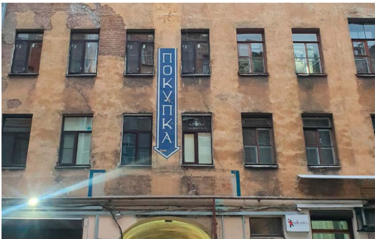
2. Дворовые оконные заполнения в уровне 3-го этажа выявленного объекта культурного наследия «Дом И.И. Антонова», расположенного по адресу: г. Санкт-Петербург, Литейный пр., д. 61, лит. А. 20.12.2020.
