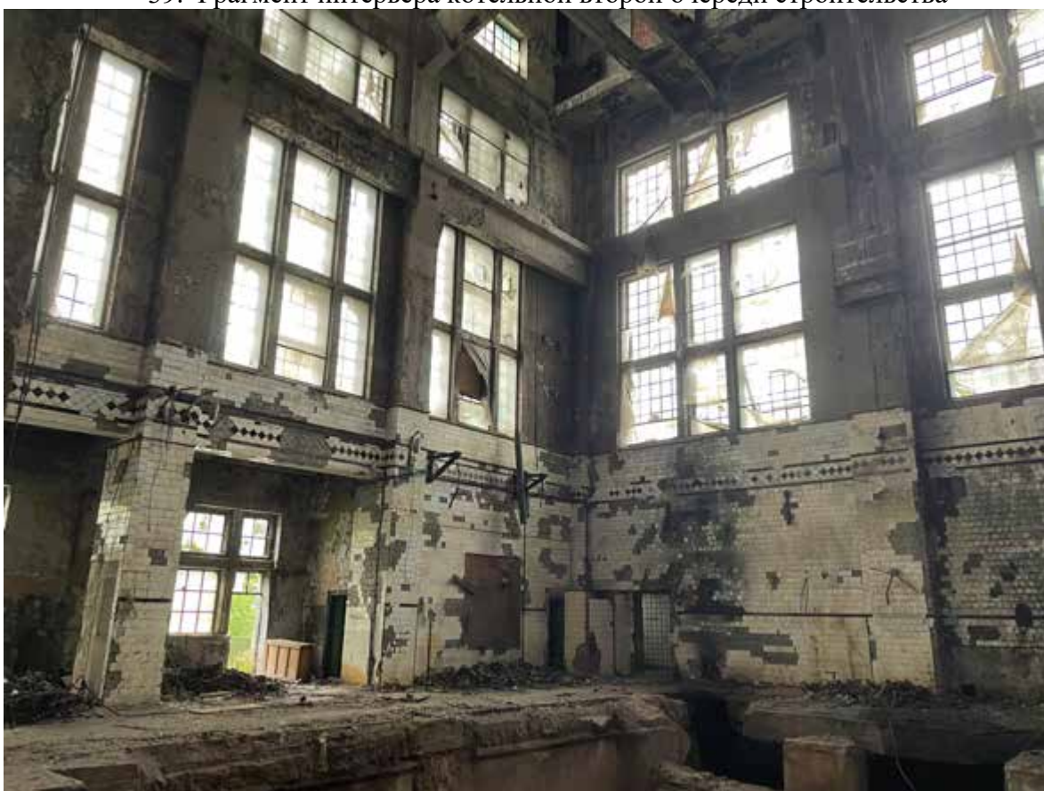
40. Фрагмент интерьера котельной второй очереди строительства
