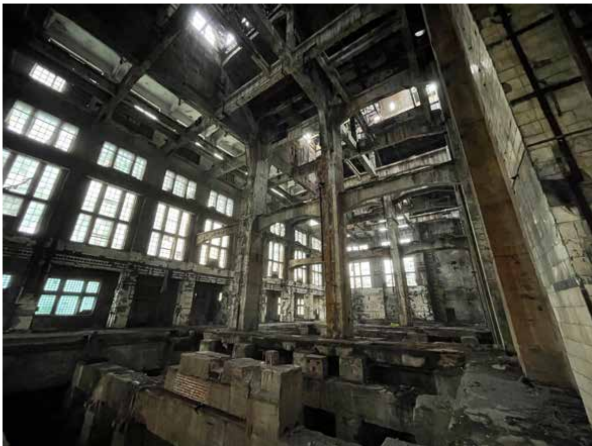
37. Фрагмент интерьера котельной второй очереди строительства
