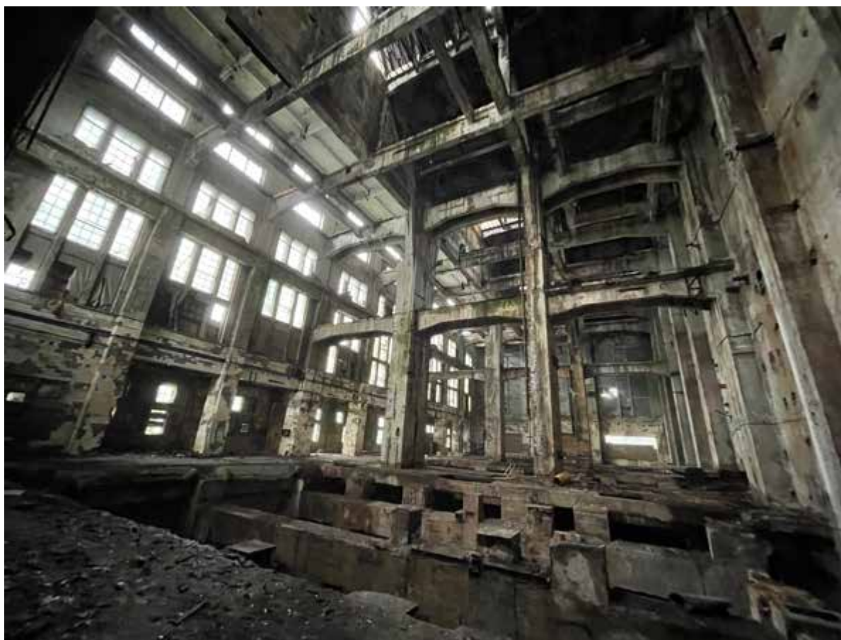
31. Фрагмент интерьера котельной второй очереди строительства
