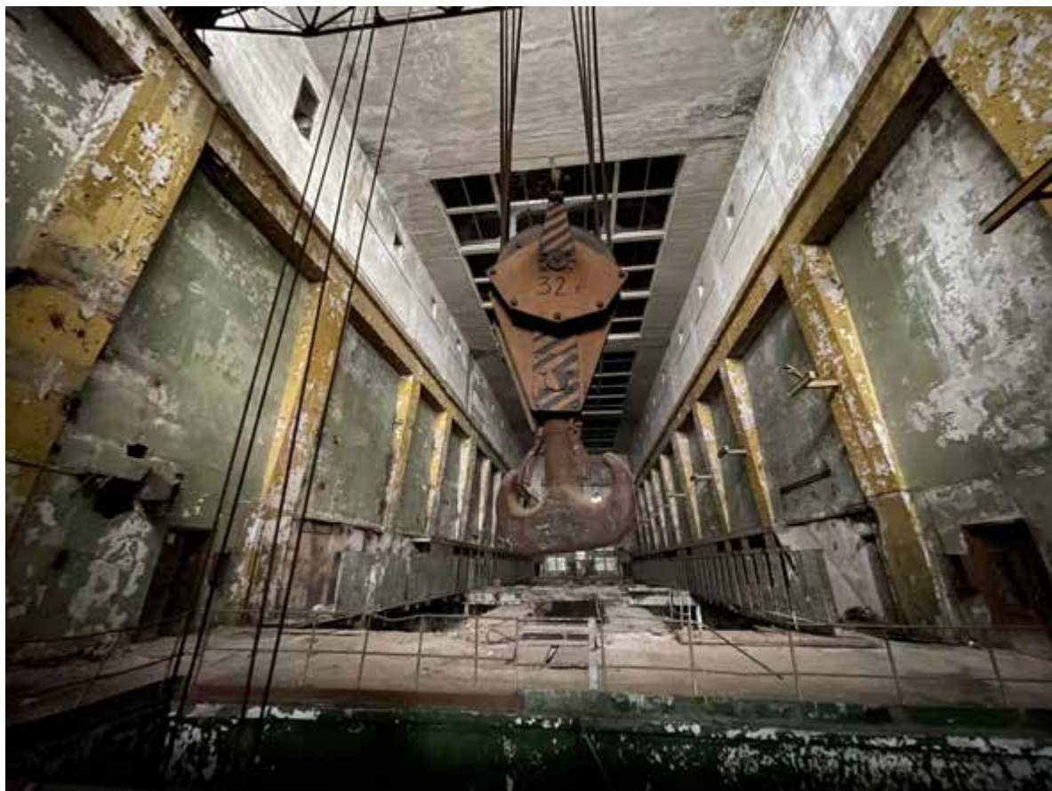
35. Фрагмент интерьера машинного зала
