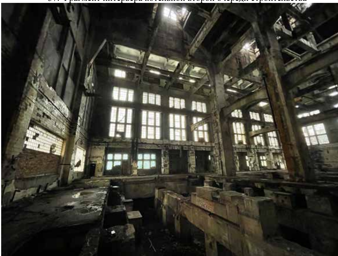
38. Фрагмент интерьера котельной второй очереди строительства
