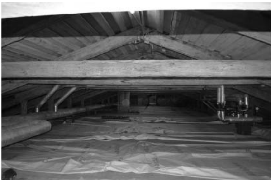
Фото 12. ОКН федерального значения «Монетный двор». Корпус № 5. Чердак. Стропильная система. Общий вид. Съёмка 24.11.2022 г.
