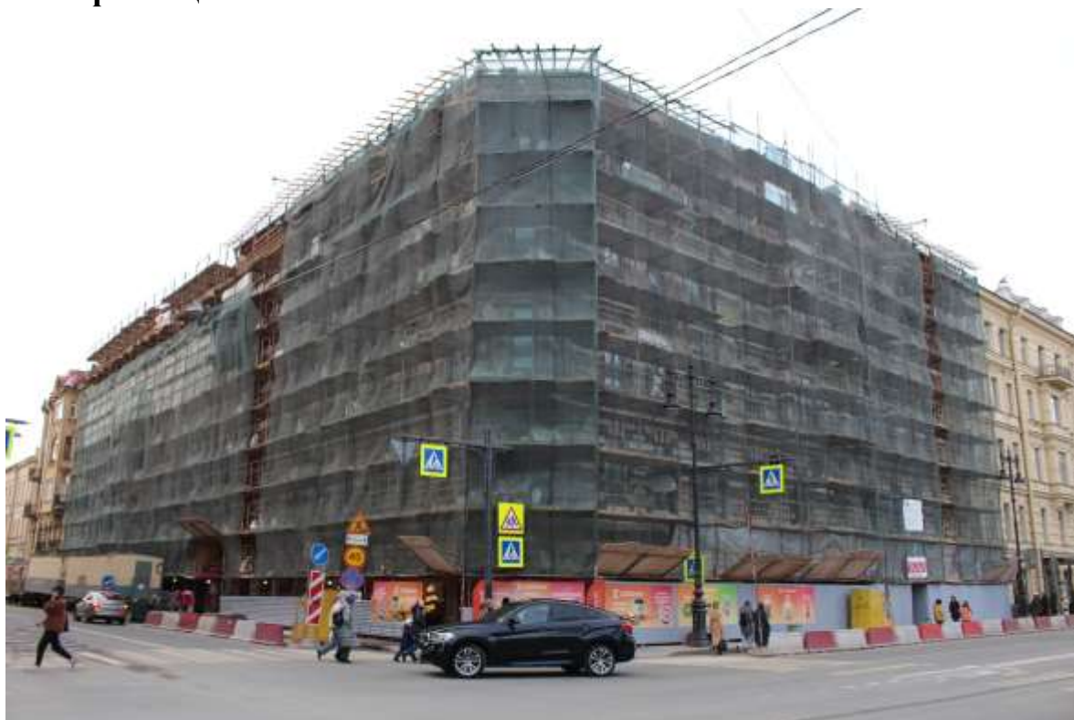
1. Общий вид объекта культурного наследия федерального значения «Дом, где в 1904-1905 гг. жил писатель Горький А.М. и в ноябре-декабре 1905 г. состоялись совещания ЦК РСДРП(б) о вооруженном восстании в Москве».
