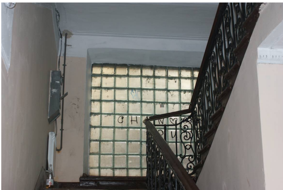
Фото 47. Лестница № 2. Площадка м/у 1-м и 2-м этажом. Съемка 19.04.2021 г. Кириков Б. М.
