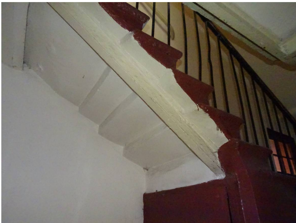
Фото 75. Лестница № 3. 1-й этаж. Пространство под лестничным маршем. Съемка 19.04.2021 г. Кириков Б. М.
