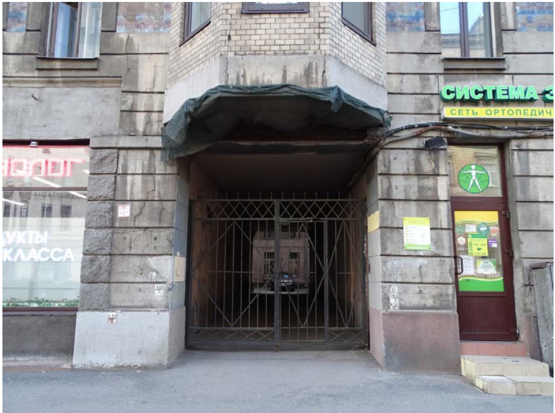
Фото 9. Здание по адресу: г. Санкт-Петербург, 11-я линия В. О., 34/47, литера А. Воротный проезд. Фасад по 11-й линии. Съемка 19.04.2021 г. Кириков Б. М.
