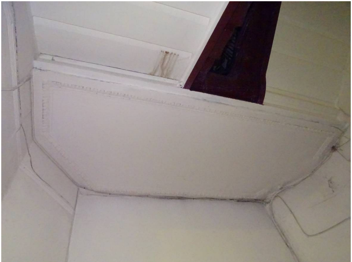
Фото 17. Лестница № 1. Площадка м/у 1-м и 2-м этажом. Оформление потолка. Съемка 19.04.2021 г. Кириков Б. М.
