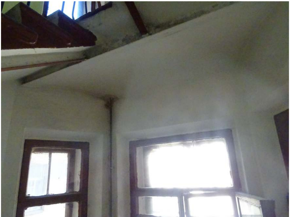
Фото 140. Лестница № 4. Площадка м/у 4-м и 5-м этажом. Свод. Съемка 19.04.2021 г. Кириков Б. М.
