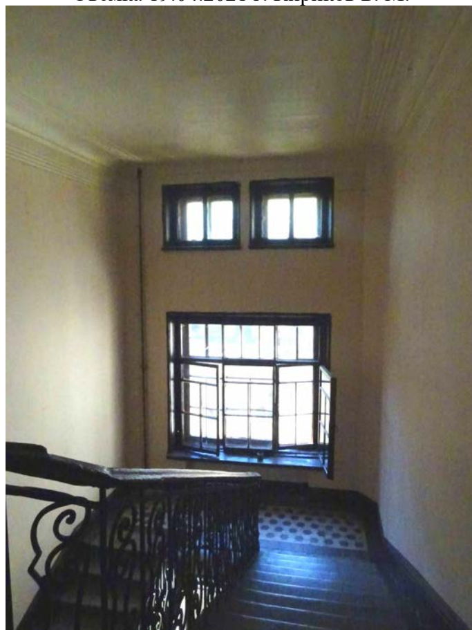
Фото 63. Лестница № 2. Площадка м/у 5-м и 6-м этажом. Съемка 19.04.2021 г. Кириков Б. М.
