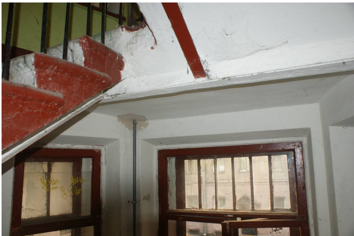
Фото 125. Лестница № 4. Площадка м/у 1-м и 2-м этажом. Съемка 19.04.2021 г. Кириков Б. М.
