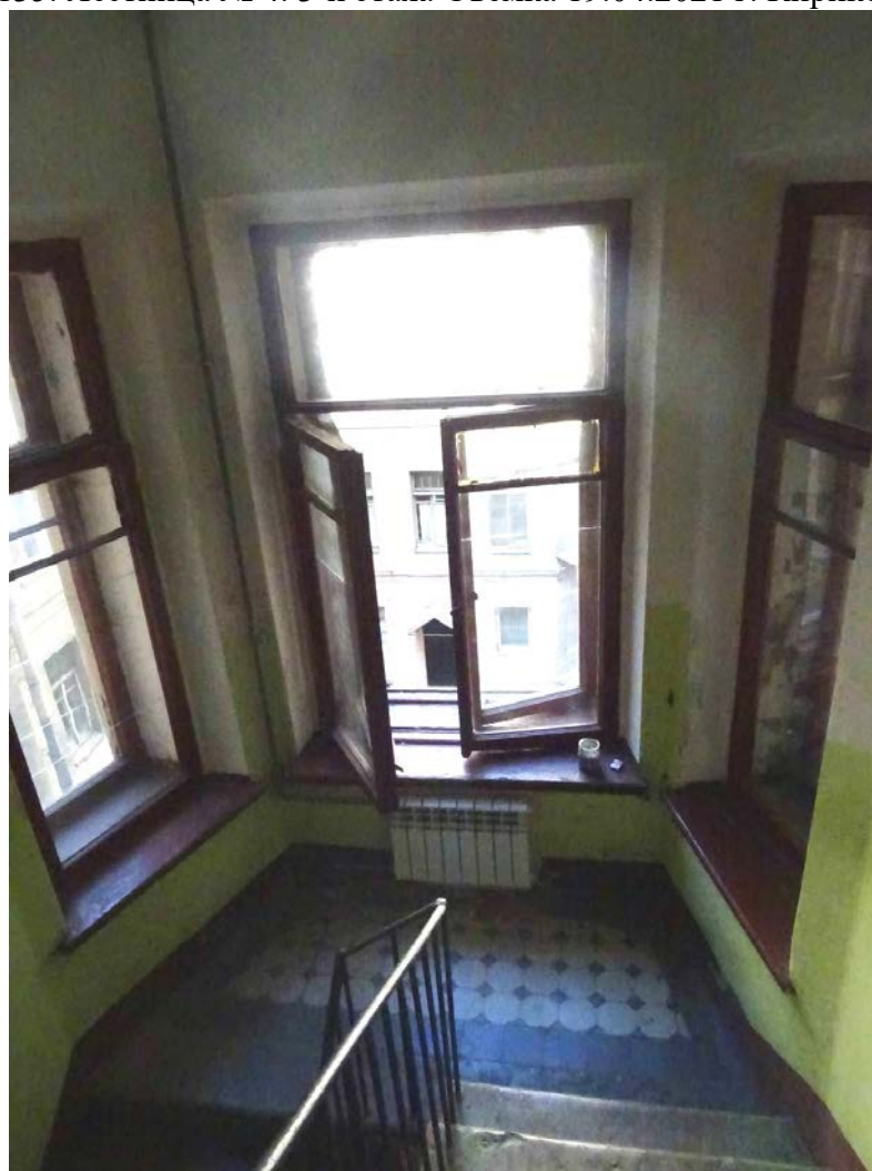
Фото 136. Лестница № 4. Площадка м/у 3-м и 4-м этажом. Съемка 19.04.2021 г. Кириков Б. М.
