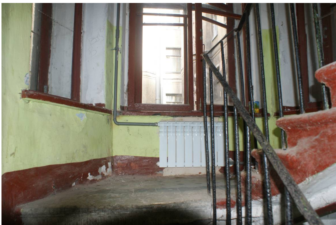
Фото 124. Лестница № 4. Площадка м/у 1-м и 2-м этажом. Съемка 19.04.2021 г. Кириков Б. М.
