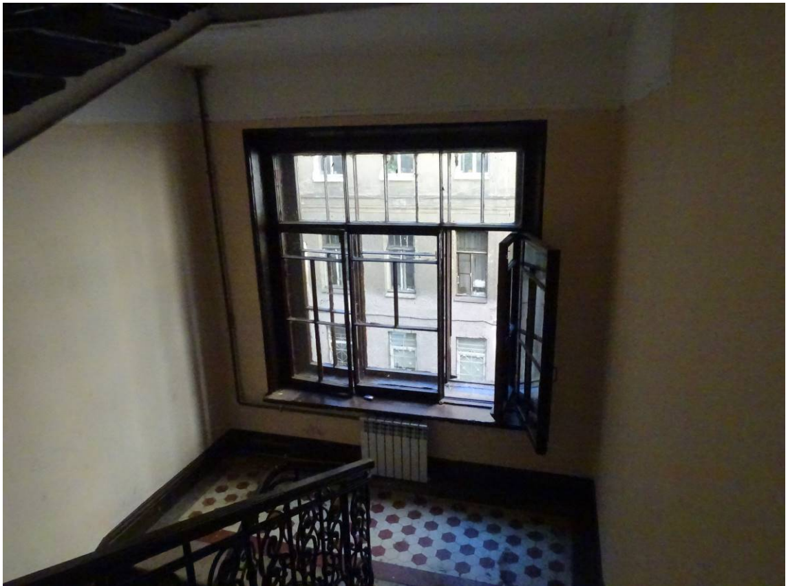
Фото 52. Лестница № 2. Площадка м/у 2-м и 3-м этажом. Съемка 19.04.2021 г. Кириков Б. М.
