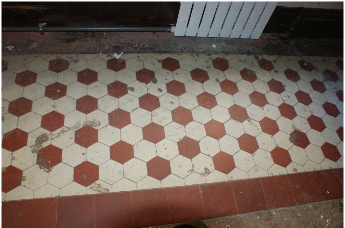
Фото 53. Лестница № 2. Площадка м/у 2-м и 3-м этажом. Покрытие пола. Съемка 19.04.2021 г. Кириков Б. М.
