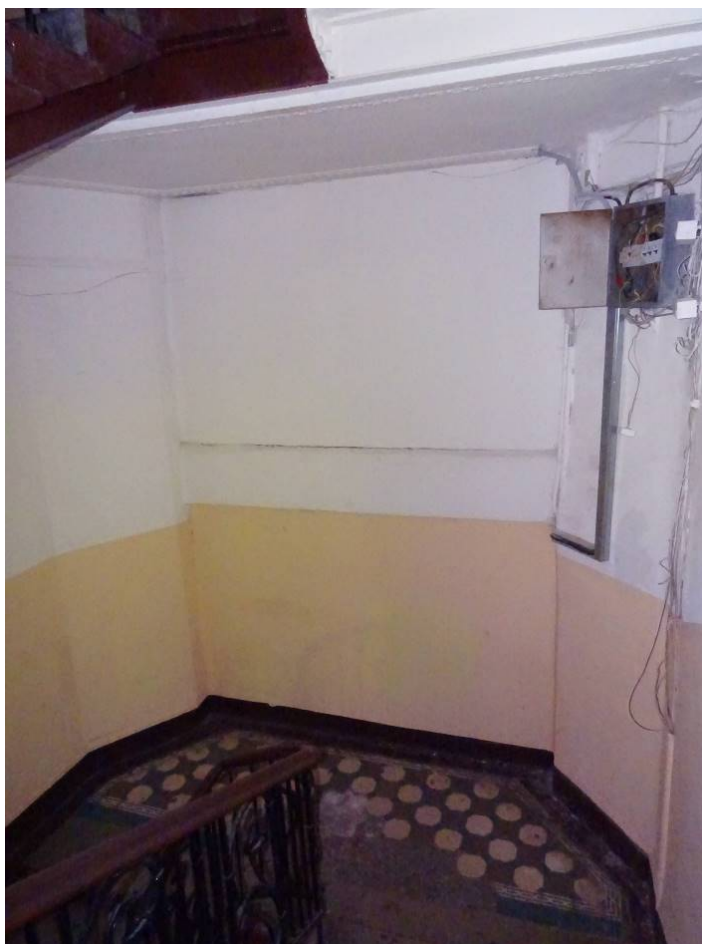
Фото 23. Лестница № 1. Площадка м/у 2-м и 3-м этажом. Съемка 19.04.2021 г. Кириков Б. М.
