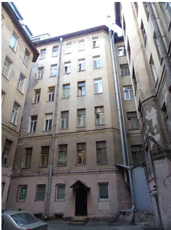
Фото 33. Здание по адресу: г. Санкт-Петербург, 11-я линия В. О., 34/47, литера А. Северный дворовой фасад. Съемка 19.04.2021 г. Кириков Б. М.
