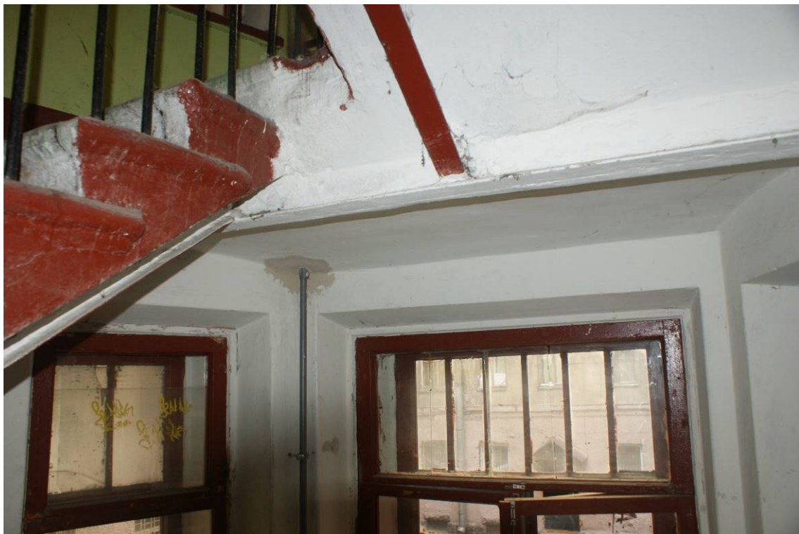
Фото 131. Лестница № 4. Площадка м/у 2-м и 3-м этажом. Съемка 19.04.2021 г. Кириков Б. М.
