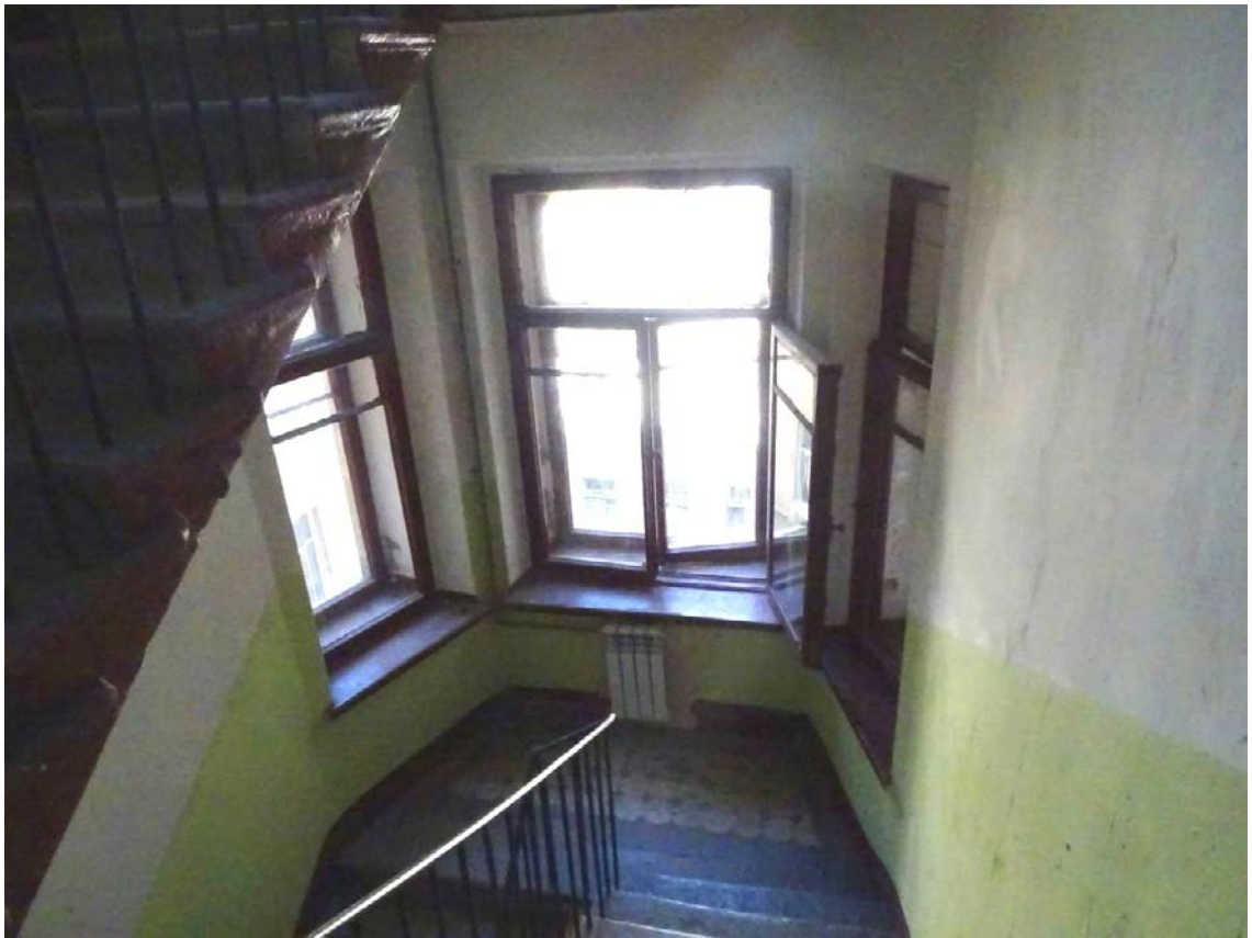
Фото 139. Лестница № 4. Площадка м/у 4-м и 5-м этажом. Съемка 19.04.2021 г. Кириков Б. М.
