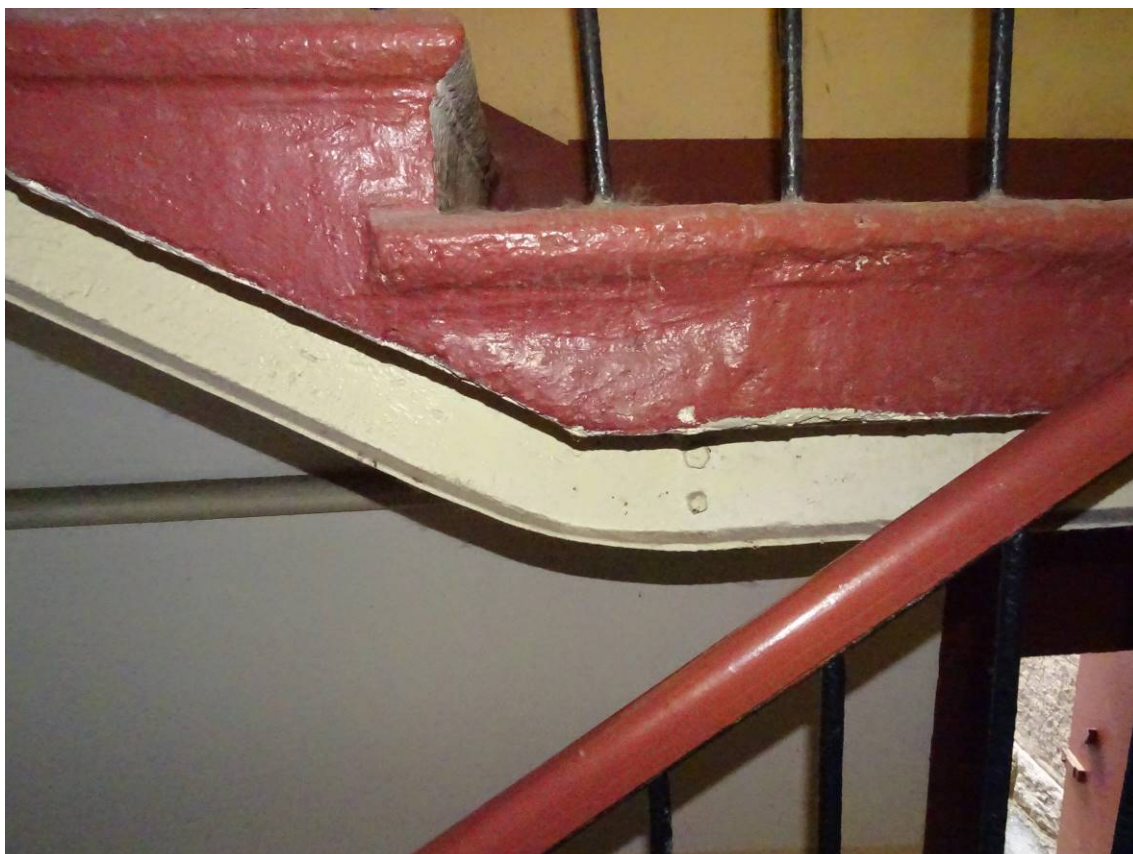
Фото 81. Лестница № 3. Фрагмент лестничного марша. Съемка 19.04.2021 г. Кириков Б. М.
