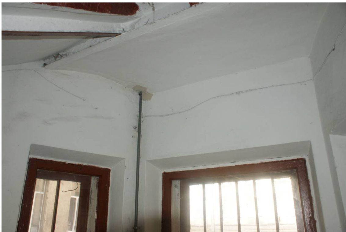
Фото 133. Лестница № 4. Площадка м/у 2-м и 3-м этажом. Съемка 19.04.2021 г. Кириков Б. М.
