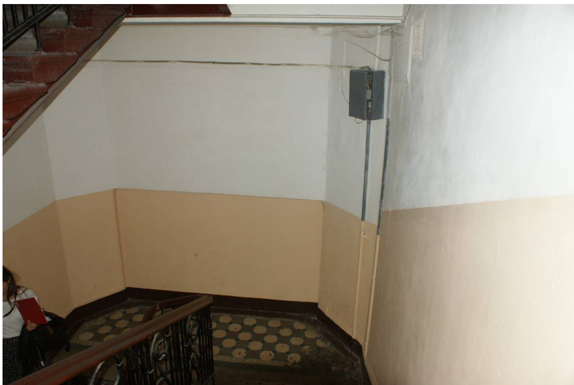
Фото 31. Лестница № 1. Площадка м/у 5-м и 6-м этажом. Съемка 19.04.2021 г. Кириков Б. М.
