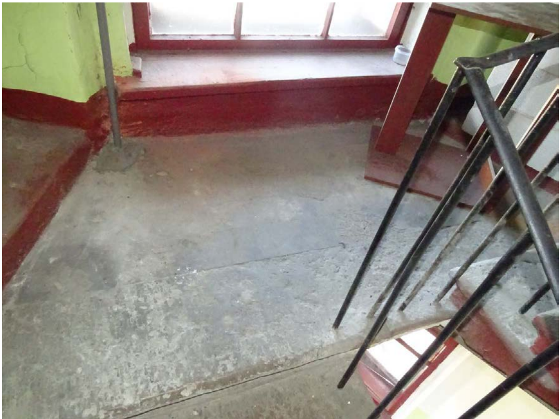
Фото 146. Лестница № 4. Площадка м/у 6-м и чердачным этажом. Съемка 19.04.2021 г. Кириков Б. М.
