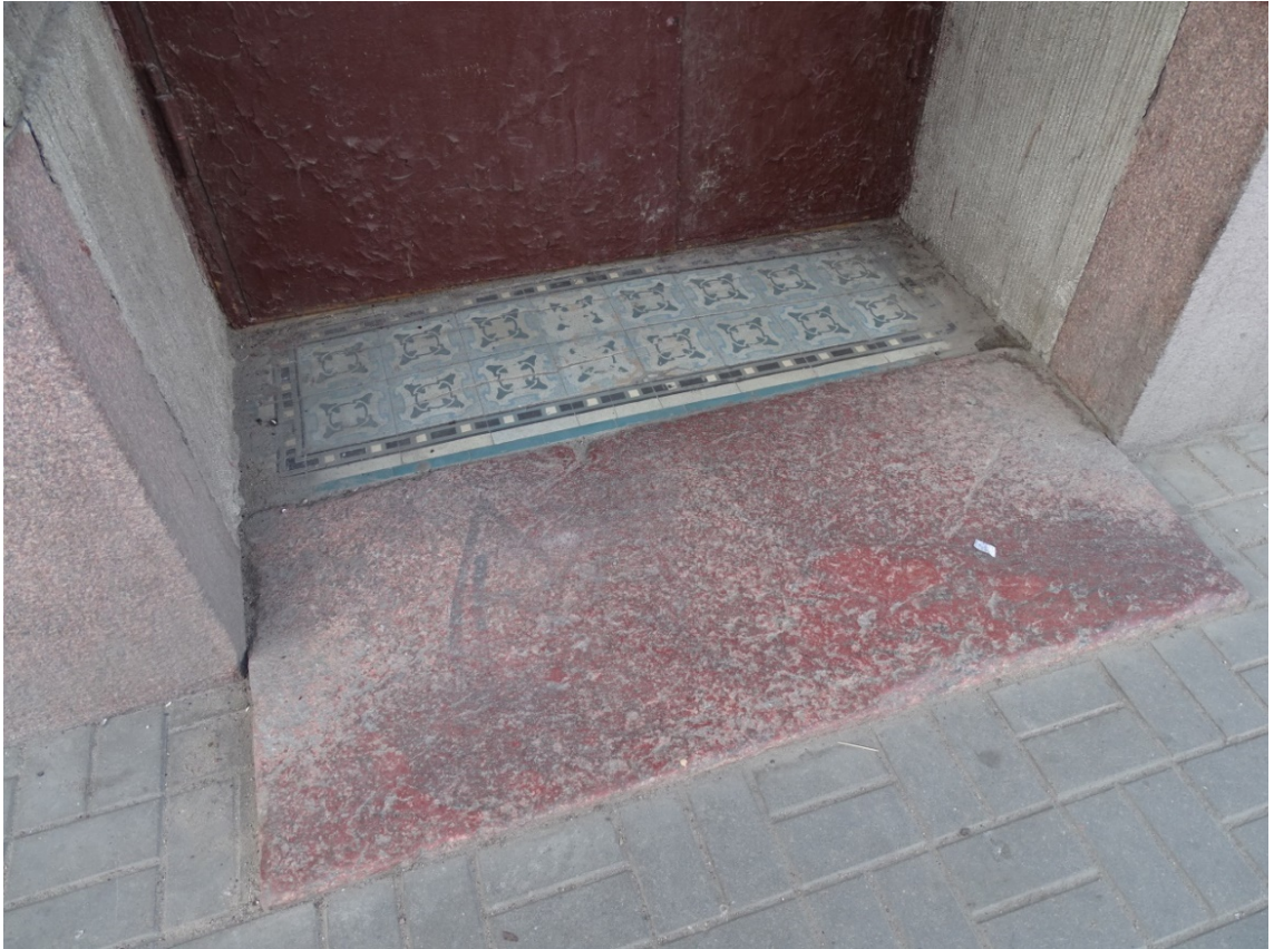
Фото 47. Здание по адресу: г. Санкт-Петербург, 11-я линия В. О., 34/47, литера А. Покрытие пола дверного проема. Съемка 19.04.2021 г. Кириков Б. М.
