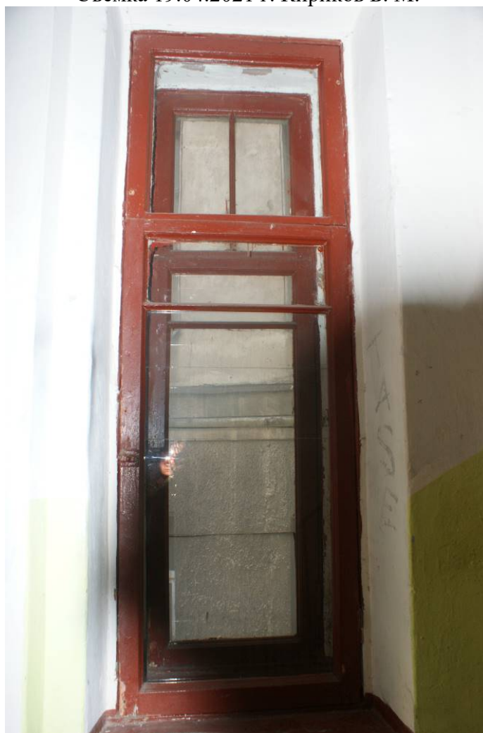
Фото 132. Лестница № 4. Площадка м/у 2-м и 3-м этажом. Съемка 19.04.2021 г. Кириков Б. М.
