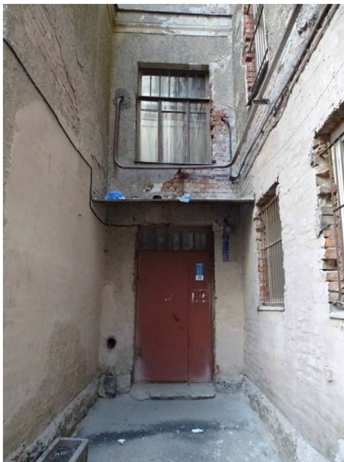
Фото 43. Здание по адресу: г. Санкт-Петербург, 11-я линия В. О., 34/47, литера А. Фрагмент дворового фасада. Входная дверь. Съемка 19.04.2021 г. Кириков Б. М.
