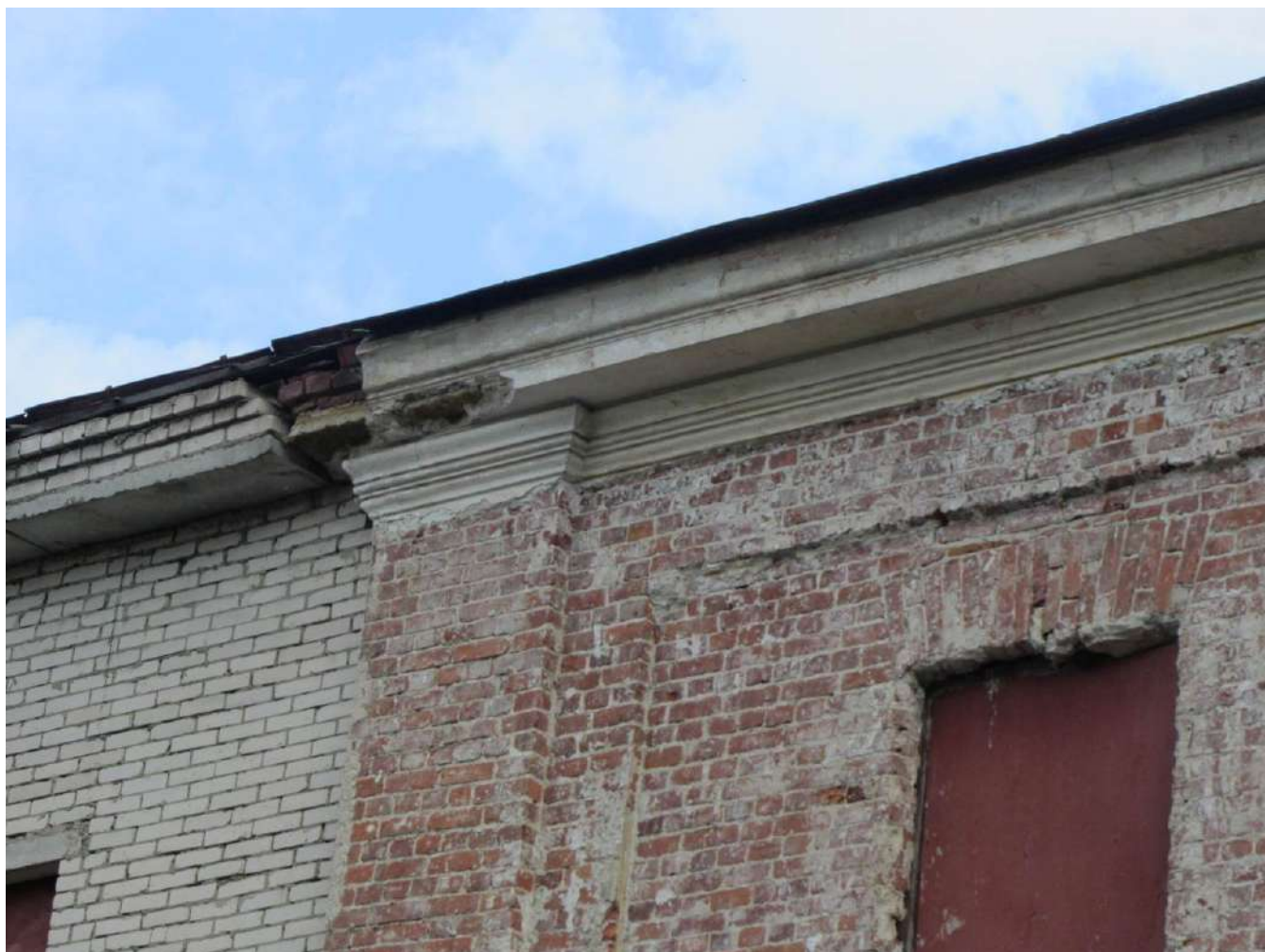
8. Казарма Офицерской стрелковой школы по адресу: г. Ломоносов, Владимирская ул., 10. Фрагмент западного лицевого фасада. Карнизная часть. Фото 01.06.2022.
