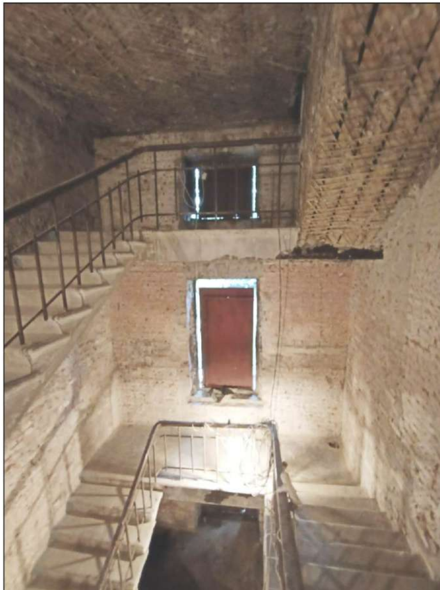
20. Казарма Офицерской стрелковой школы по адресу: г. Ломоносов, Владимирская ул., 15 Фрагмент интерьера. Общий вид лестницы. Фото 01.06.2022.
