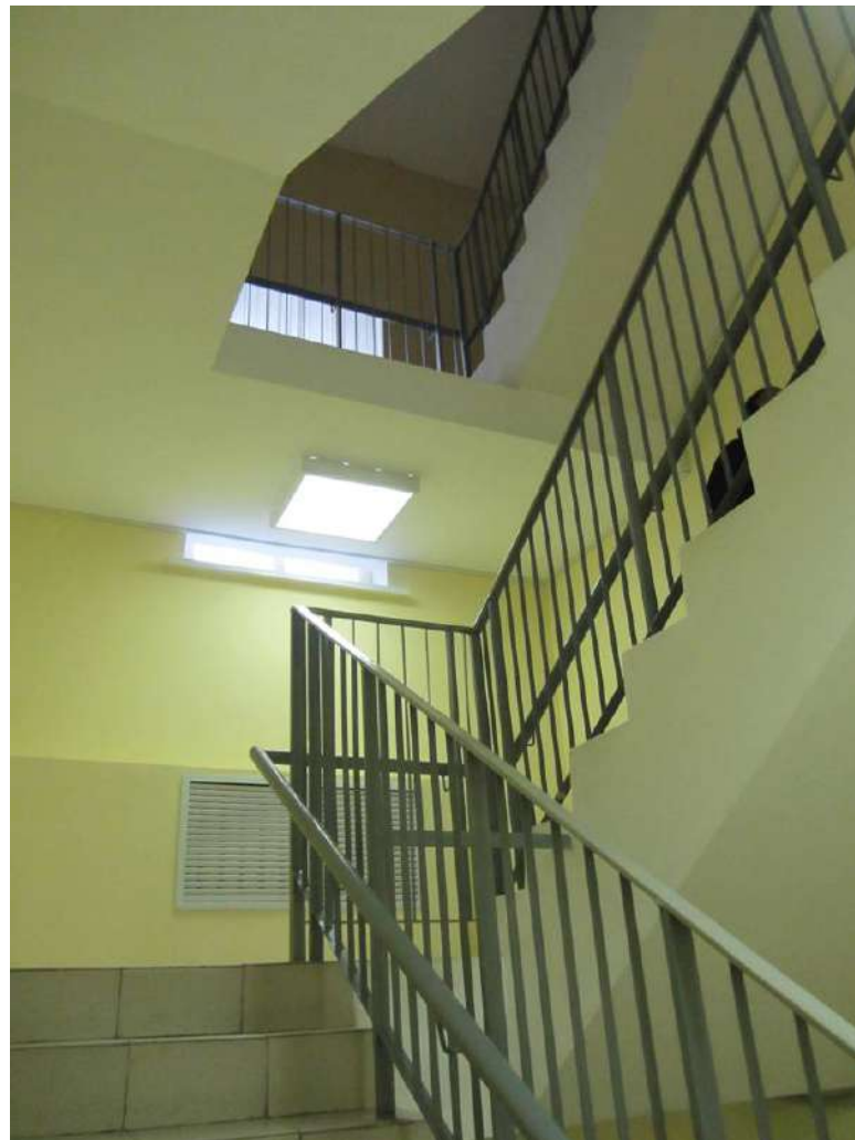
6. Казарма Офицерской стрелковой школы по адресу: г. Ломоносов, Александровская ул., д. 13. Фрагмент интерьера. Общий вид лестницы. Фото 25.01.2023.
