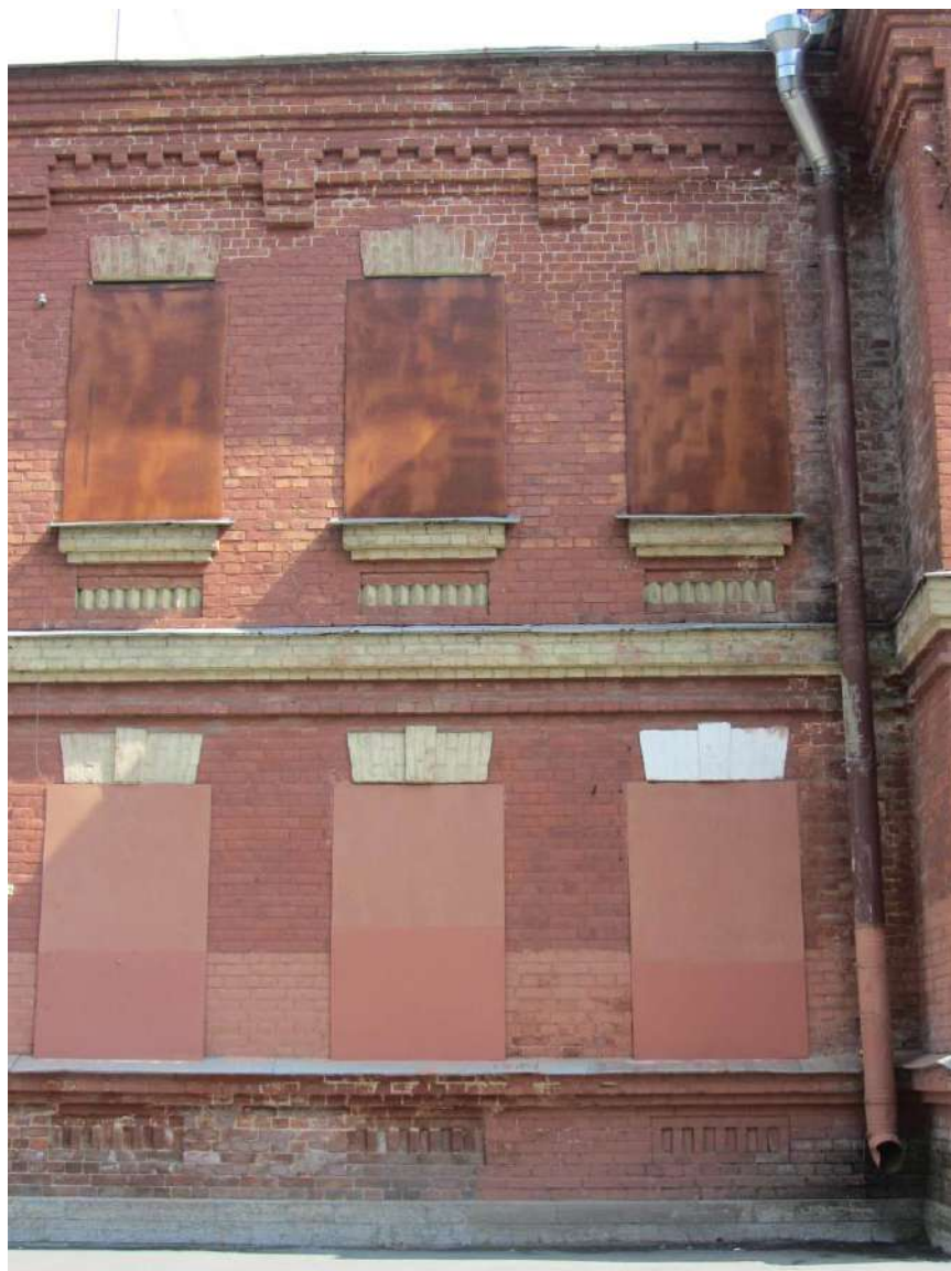
6. Казарма Офицерской стрелковой школы по адресу: г. Ломоносов, Владимирская ул., 12. Фрагмент лицевого фасада. Фото 01.06.2022.
