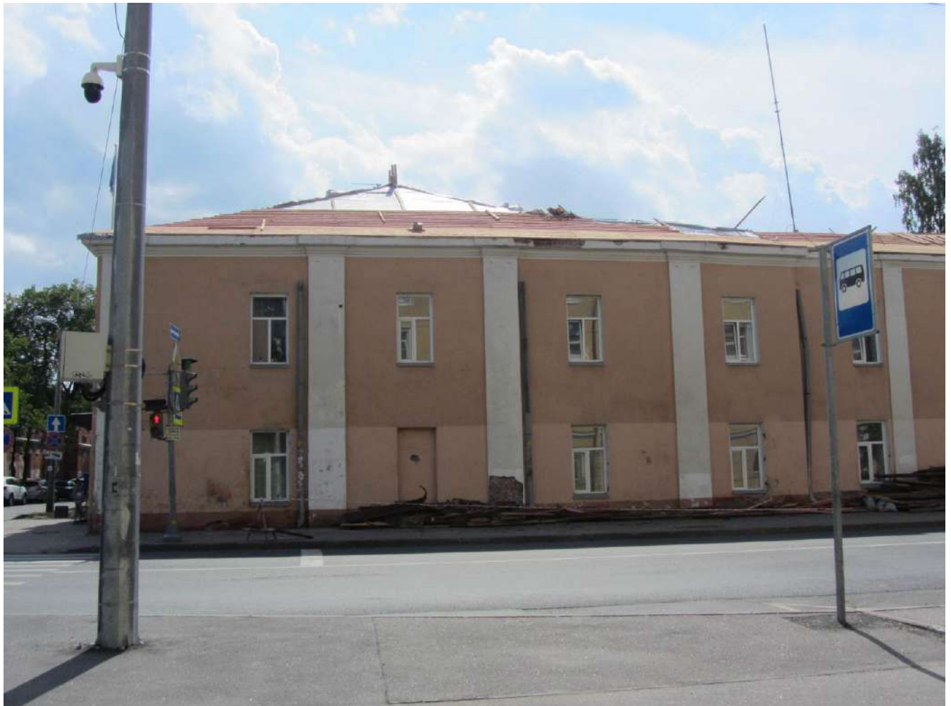
1. Казарма Офицерской стрелковой школы по адресу: г. Ломоносов, Владимирская ул., 19. Лицевой северный фасад по Александровской улице. Вид с перекрестка. Фото 01.06.2022.
