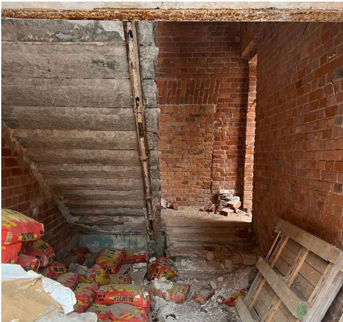
8. Казарма Офицерской стрелковой школы по адресу: г. Ломоносов, Владимирская ул., д. 16. Фрагмент интерьера. Лестница. Фото 25.01.2023.
