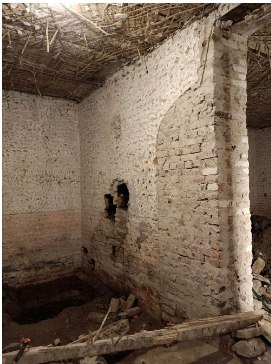
18. Казарма Офицерской стрелковой школы по адресу: г. Ломоносов, Владимирская ул., 15 Фрагменты торцевого фасада здания Фрагмент интерьера 1-го этажа. Состояние кладки стены. Фото 01.06.2022.
