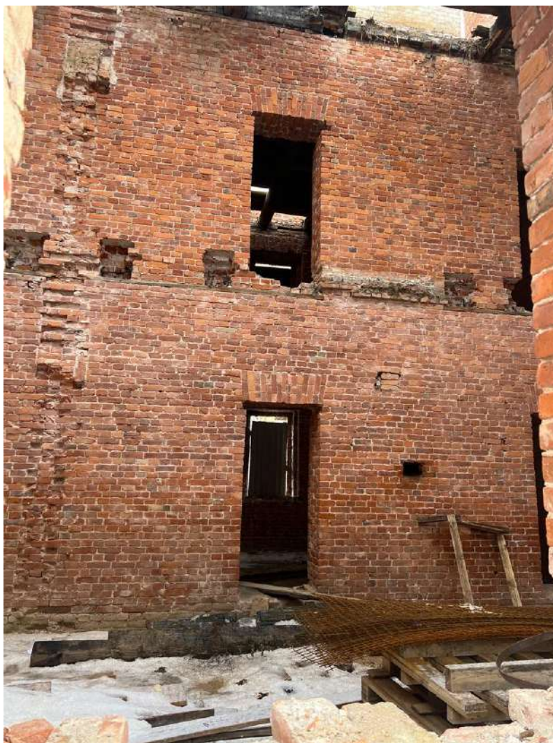
11. Казарма Офицерской стрелковой школы по адресу: г. Ломоносов, Владимирская ул., д. 16. Фрагмент интерьера. Фото 25.01.2023.
