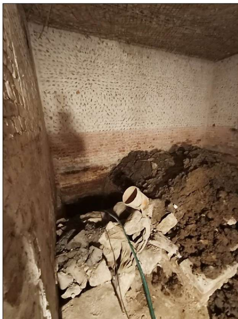
13. Казарма Офицерской стрелковой школы по адресу: г. Ломоносов, Владимирская ул., 15 Фрагмент интерьера 1-го этажа. Место устройства шурфа. Фото 01.06.2022.
