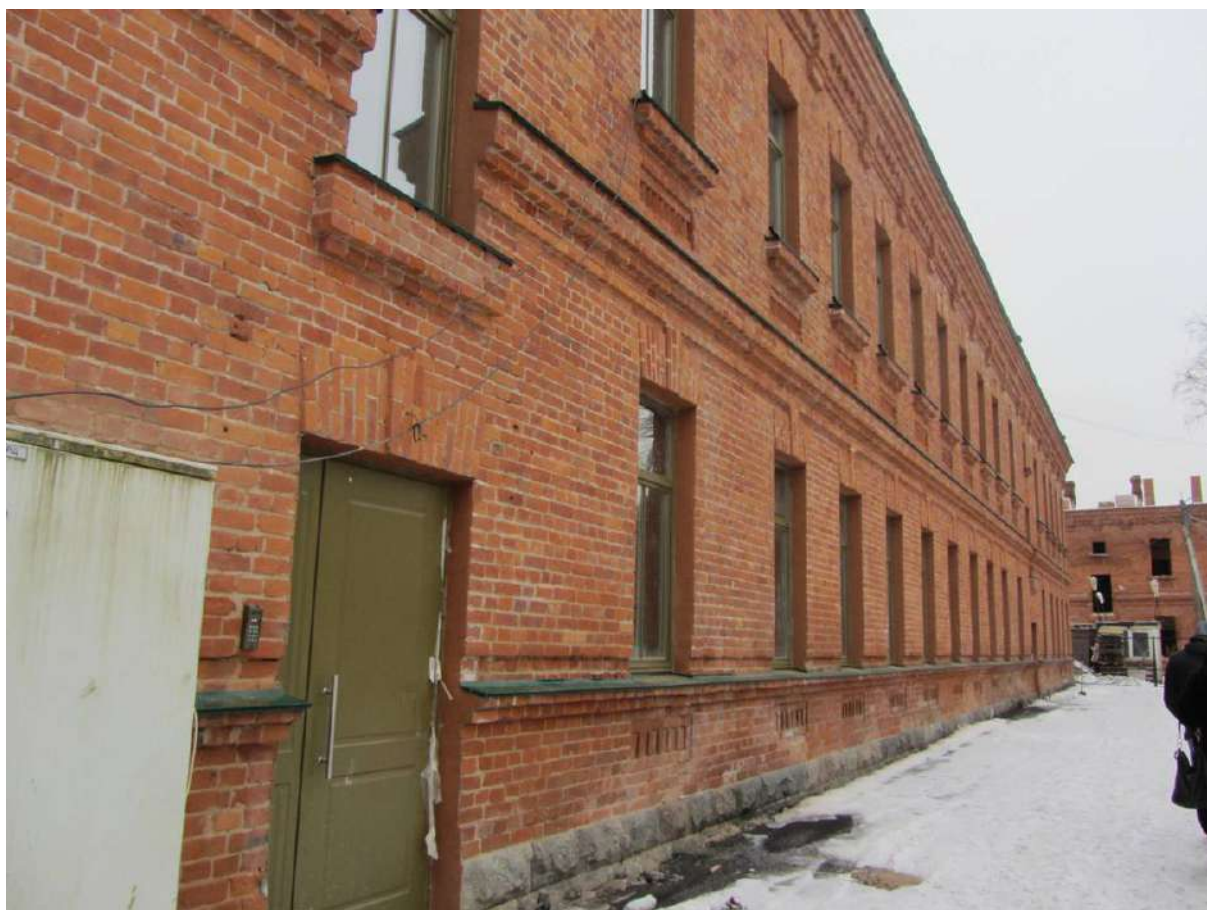
5. Казарма Офицерской стрелковой школы по адресу: г. Ломоносов, Владимирская ул., 16а. Общий вид северного фасада. Фото 25.01.2023.
