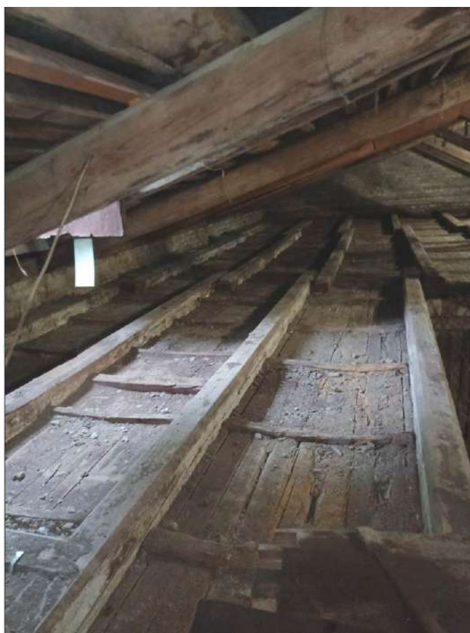
28. Казарма Офицерской стрелковой школы по адресу: г. Ломоносов, Владимирская ул., 15 Фрагменты интерьера чердака. Фото 01.06.2022.
