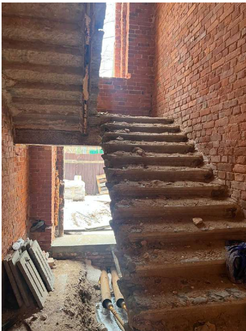
7. Казарма Офицерской стрелковой школы по адресу: г. Ломоносов, Владимирская ул., д. 16. Фрагмент интерьера. Лестница. Фото 25.01.2023.
