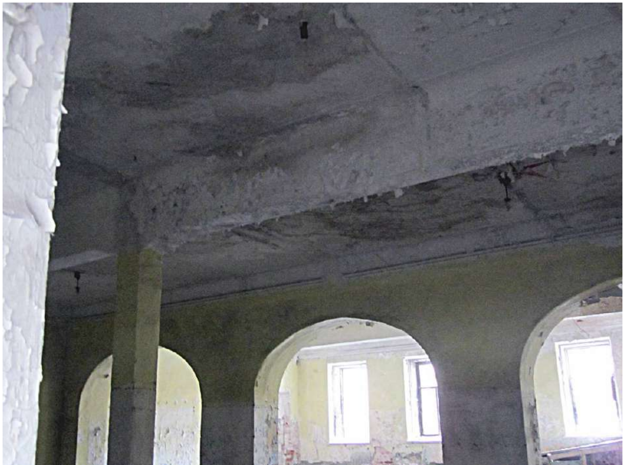
12, 13. Казарма Офицерской стрелковой школы по адресу: г. Ломоносов, Владимирская ул., 10. Несущие конструкции 1-го этажа. Фото 01.06.2022.
