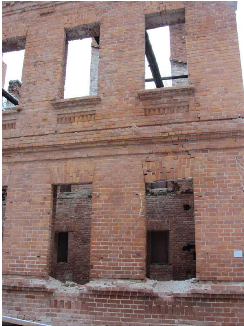
6. Казарма Офицерской стрелковой школы по адресу: г. Ломоносов, Владимирская ул., д. 16. Фрагмент дворового фасада. Фото 25.01.2023.
