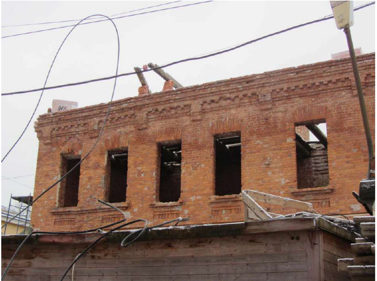
5. Казарма Офицерской стрелковой школы по адресу: г. Ломоносов, Владимирская ул., д. 16. Фрагмент дворового фасада. Фото 25.01.2023.
