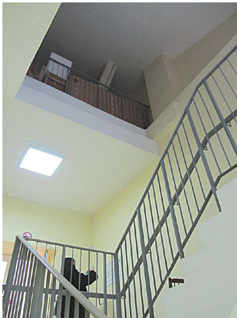
7. Казарма Офицерской стрелковой школы по адресу: г. Ломоносов, Александровская ул., д. 13. Фрагмент интерьера. Общий вид лестницы. Вход на 2-й этаж. Фото 25.01.2023.
