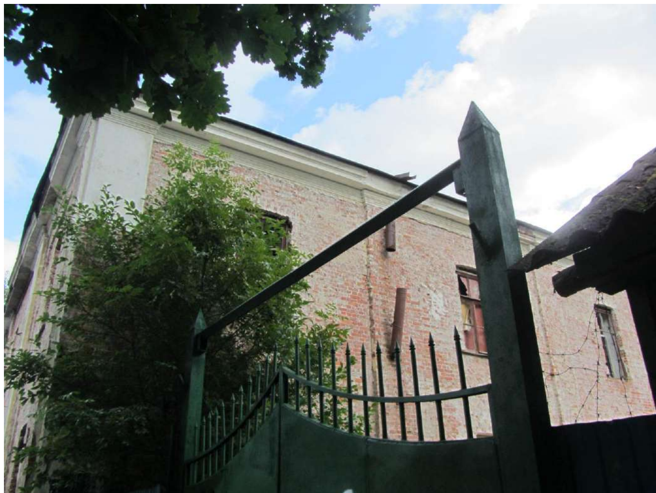
5. Казарма Офицерской стрелковой школы по адресу: г. Ломоносов, Владимирская ул., 10. Видимая с Владимирской улицы часть южного фасада здания. Фото 01.06.2022.
