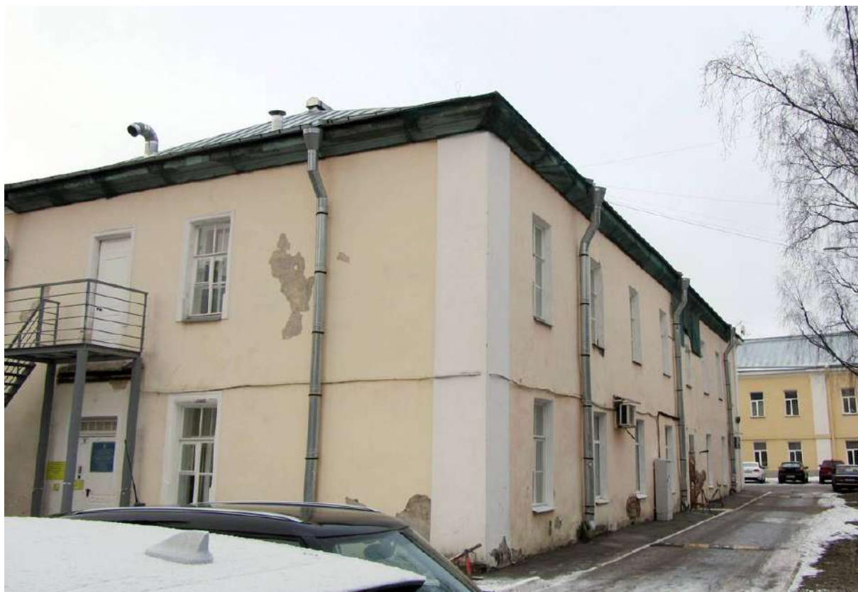
2. Казарма Офицерской стрелковой школы по адресу: г. Ломоносов, Александровская ул., д. 13. Вид на дворовый и торцевой фасады. Фото 25.01.2023.
