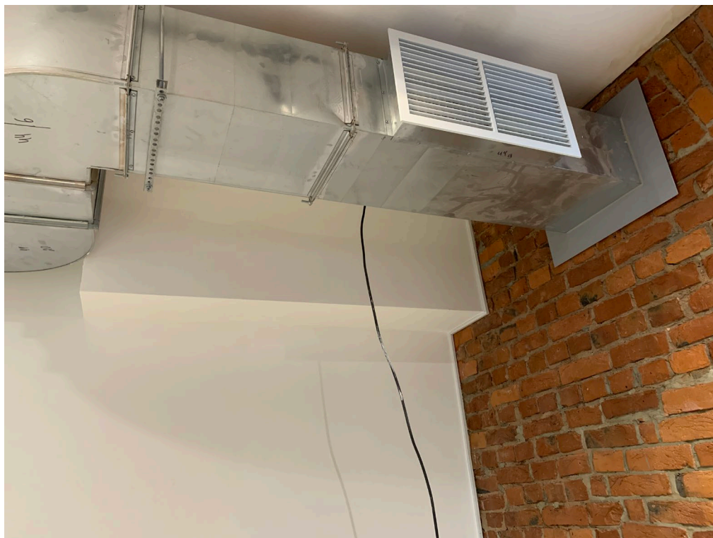
Фото 5. Торговый зал. Вид на вентиляцию.
