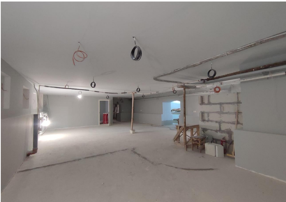
17. Объект культурного наследия федерального значения «Дом, где жили в 1912-1936 гг. – путешественник Грум-Гржимайло Г.Е., в 1914-1922 гг. – певец Шаляпин Ф.И.», по адресу: г. Санкт-Петербург, улица Графтио, дом 2б, литера А. Общий вид пом. 1-Н (31) в уровне подвала.
