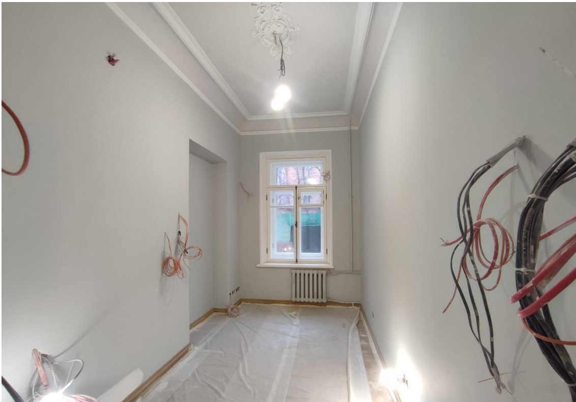
20. Объект культурного наследия федерального значения «Дом, где жили в 1912-1936 гг. – путешественник Грум-Гржимайло Г.Е., в 1914-1922 гг. – певец Шаляпин Ф.И.», по адресу: г. Санкт-Петербург, улица Графтио, дом 2б, литера А. Общий вид пом. 1-Н (9) в уровне 1-го этажа.
