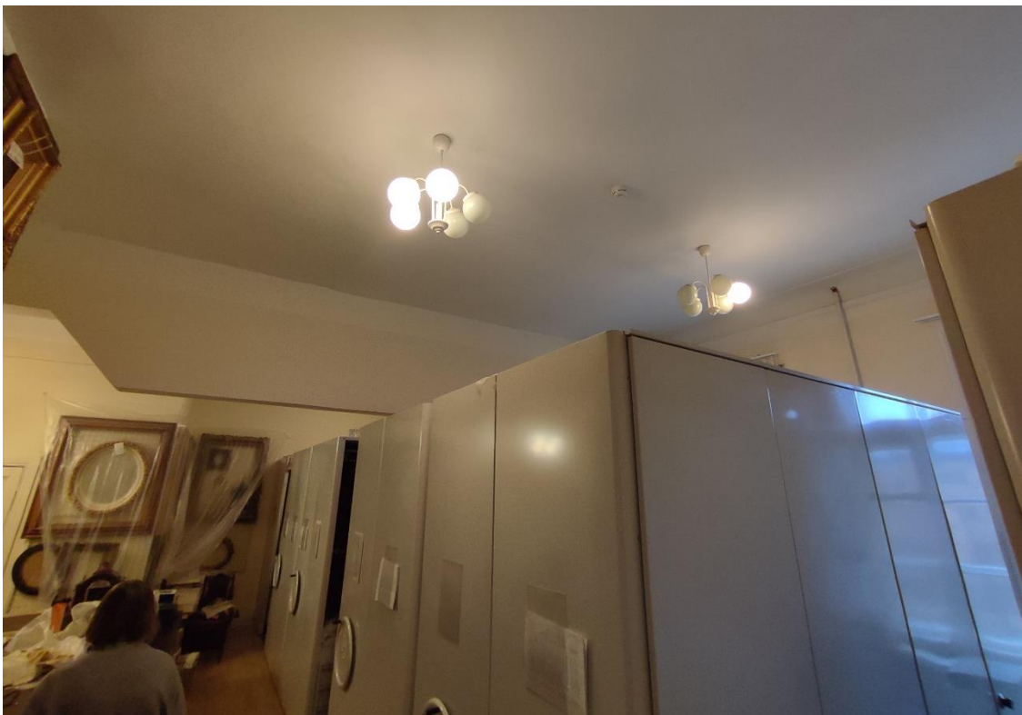
64. Объект культурного наследия федерального значения «Дом, где жили в 1912-1936 гг. – путешественник Грум-Гржимайло Г.Е., в 1914-1922 гг. – певец Шаляпин Ф.И.», по адресу: г. Санкт-Петербург, улица Графтио, дом 26, литера А. Фрагмент пом. 1-Н (91) в уровне 4-го этажа.
