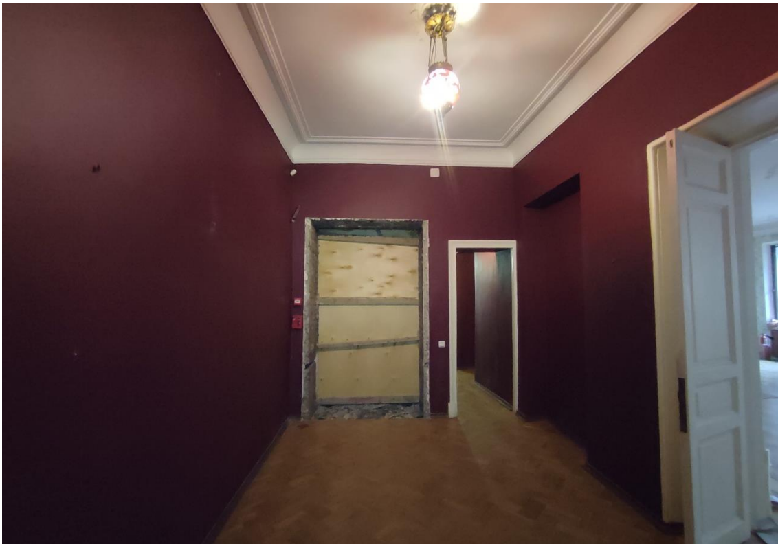
39. Объект культурного наследия федерального значения «Дом, где жили в 1912-1936 гг. – путешественник Грум-Гржимайло Г.Е., в 1914-1922 гг. – певец Шаляпин Ф.И.», по адресу: г. Санкт-Петербург, улица Графтио, дом 2б, литера А. Общий вид пом. 1-Н (48) в уровне 2-го этажа.
