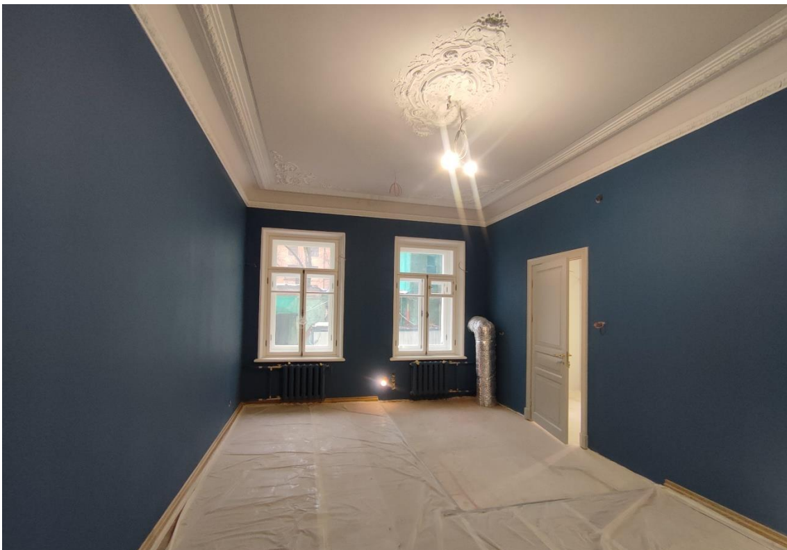
21. Объект культурного наследия федерального значения «Дом, где жили в 1912-1936 гг. – путешественник Грум-Гржимайло Г.Е., в 1914-1922 гг. – певец Шаляпин Ф.И.», по адресу: г. Санкт-Петербург, улица Графтио, дом 2б, литера А. Общий вид пом. 1-Н (11) в уровне 1-го этажа.
