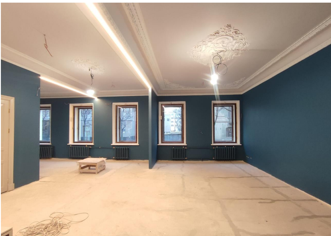
23. Объект культурного наследия федерального значения «Дом, где жили в 1912-1936 гг. – путешественник Грум-Гржимайло Г.Е., в 1914-1922 гг. – певец Шаляпин Ф.И.», по адресу: г. Санкт-Петербург, улица Графтио, дом 26, литера А. Общий вид пом. 1-Н (22-24) в уровне 1-го этажа.
