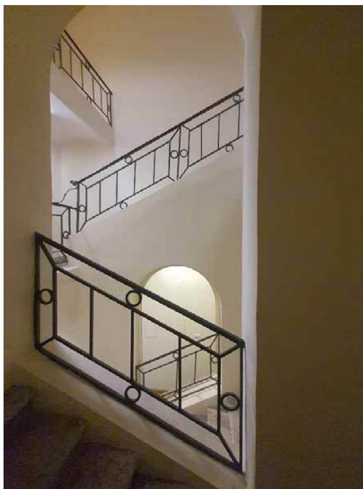
18. Лестница 1143 в уровне антресоли объекта культурного наследия федерального значения «Дворец Таврический. Дворец», расположенного по адресу: г. Санкт-Петербург, ул. Шпалерная, д. 47, лит. А. 17.10.2022
