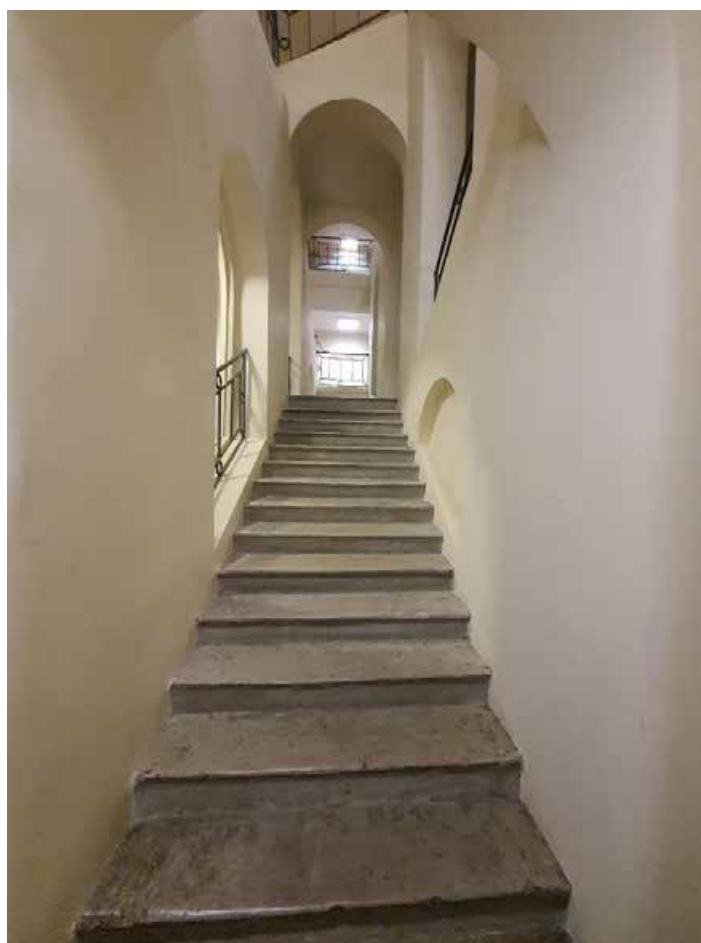
17. Лестница 1143 в уровне 1-го этажа объекта культурного наследия федерального значения «Дворец Таврический. Дворец», расположенного по адресу: г. Санкт-Петербург, ул. Шпалерная, д. 47, лит. А. 17.10.2022
