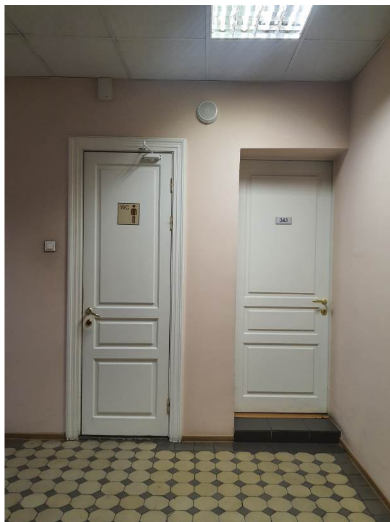
23. Дверное заполнение помещения 3160 в уровне 2-го этажа объекта культурного наследия федерального значения «Дворец Таврический. Дворец», расположенного по адресу: г. Санкт-Петербург, ул. Шпалерная, д. 47, лит. А. 17.10.2022
