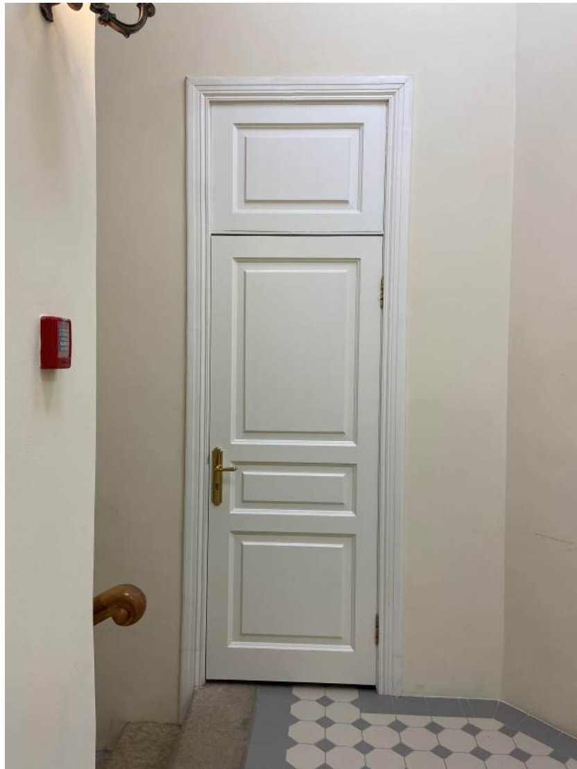
25. Дверное заполнение помещения 3162 в уровне 2-го этажа объекта культурного наследия федерального значения «Дворец Таврический. Дворец», расположенного по адресу: г. Санкт-Петербург, ул. Шпалерная, д. 47, лит. А. 17.10.2022
