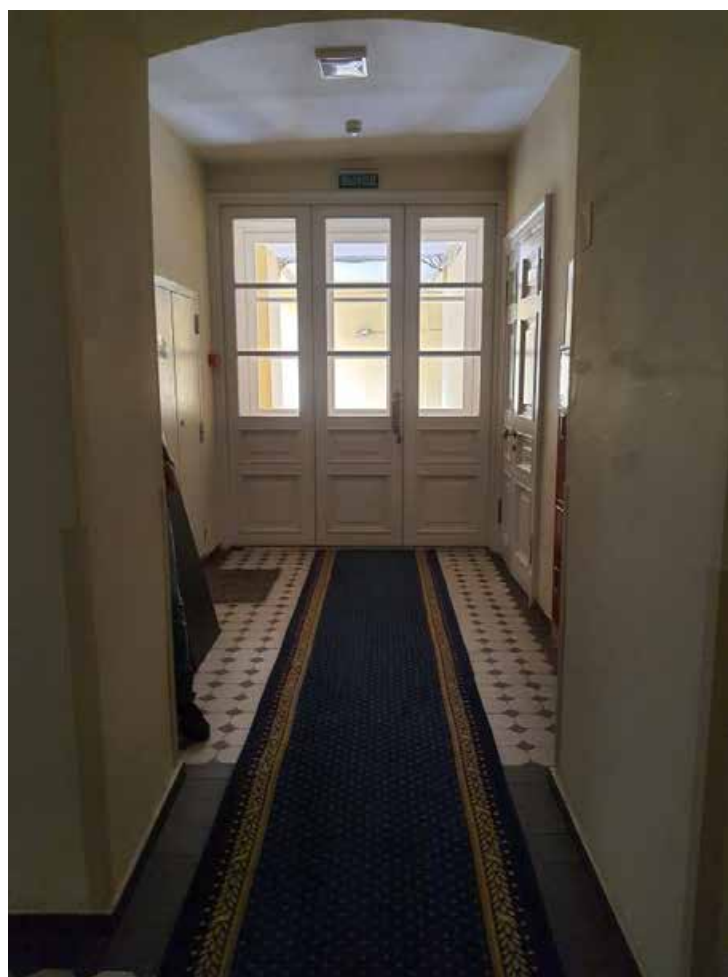
7. Дверное заполнение помещения 1198 в уровне 1-го этажа объекта культурного наследия федерального значения «Дворец Таврический. Дворец», расположенного по адресу: г. Санкт-Петербург, ул. Шпалерная, д. 47, лит. А. 17.10.2022
