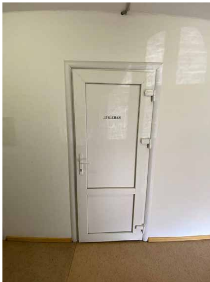
29. Дверное заполнение помещения 2041 в уровне антресоли объекта культурного наследия федерального значения «Дворец Таврический. Дворец», расположенного по адресу: г. Санкт-Петербург, ул. Шпалерная, д. 47, лит. А. 17.10.2022
