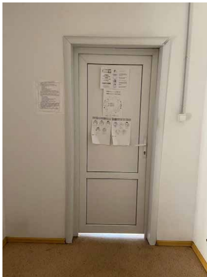
30. Дверное заполнение помещения 2040 в уровне антресоли объекта культурного наследия федерального значения «Дворец Таврический. Дворец», расположенного по адресу: г. Санкт-Петербург, ул. Шпалерная, д. 47, лит. А. 17.10.2022
