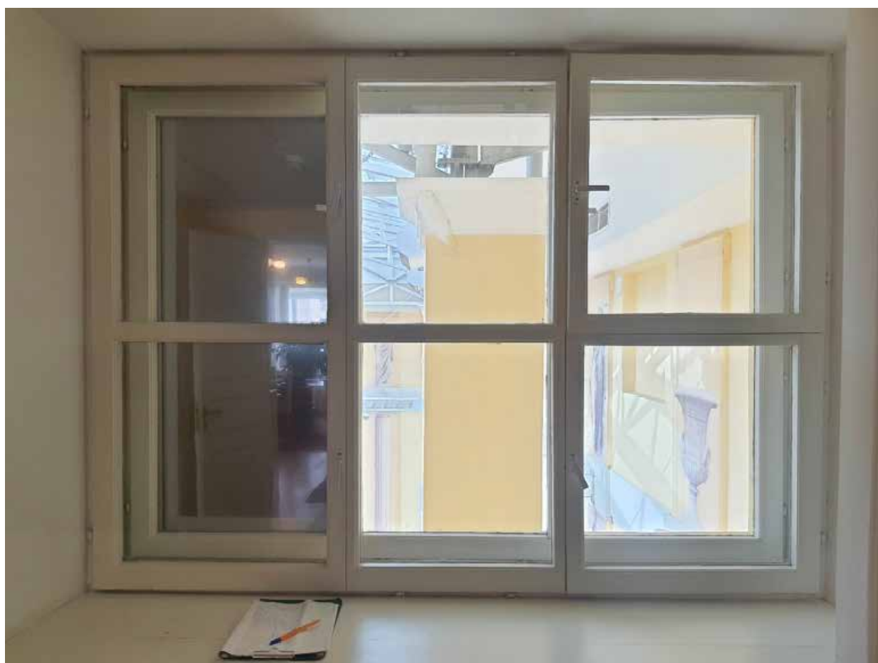
36. Оконное заполнение в уровне 2-го этажа объекта культурного наследия федерального значения «Дворец Таврический. Дворец», расположенного по адресу: г. Санкт-Петербург, ул. Шпалерная, д. 47, лит. А. 17.10.2022
