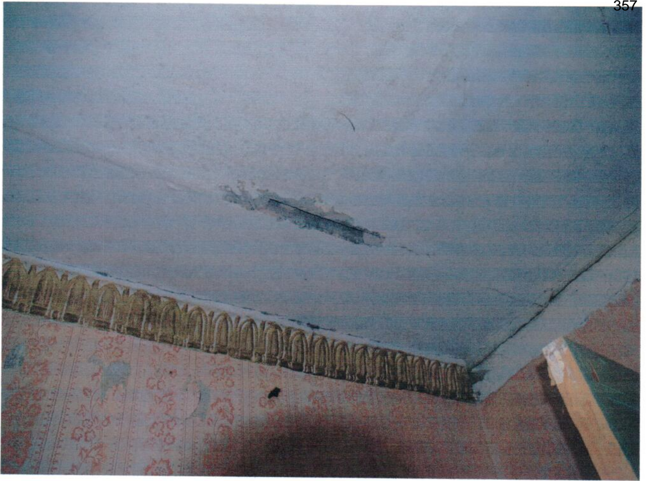
Трещина перекрытия между 1 и 2 этажами
