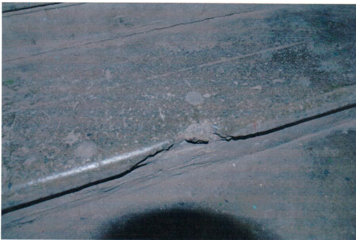
Деформация ступеней (фрагмент)
