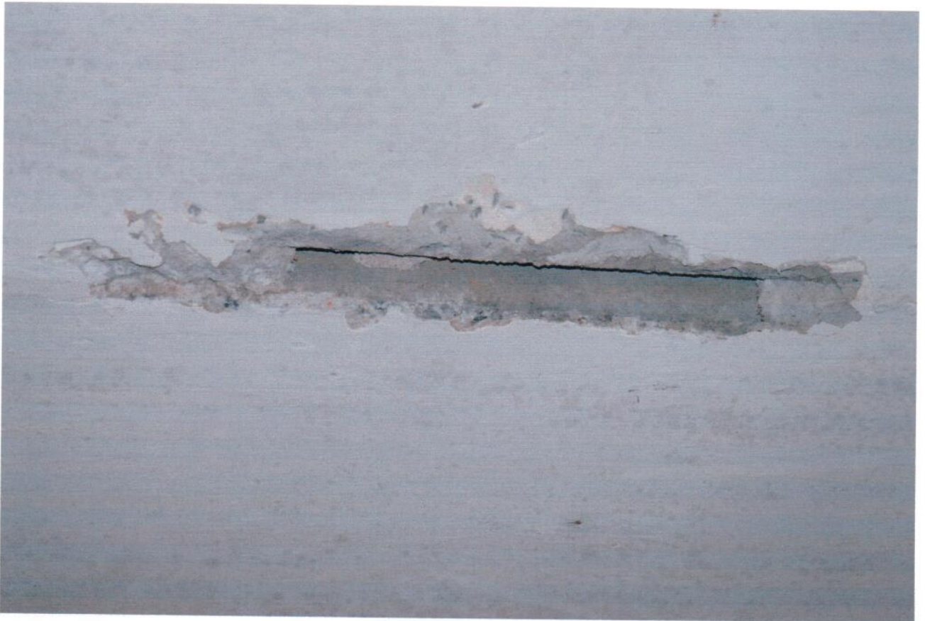
Трещина перекрытия между 1 и 2 этажами (увеличено)
