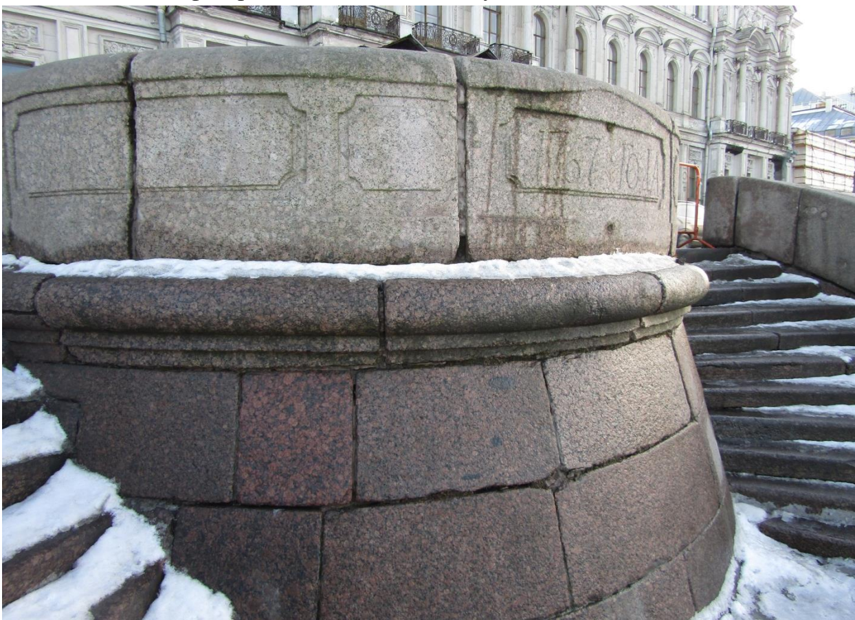
Фото 10. Вид на подпорную стенку спуска № 4 объекта культурного наследия федерального значения «Спуски лестничные»
