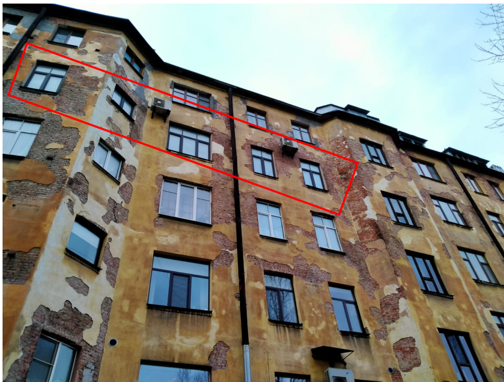
11. Здание по адресу: Санкт-Петербург, ул. Рубинштейна, д. 15-17, Лит. А. Фрагмент дворового фасада здания. На фото выделены красным цветом пять оконных проемов из семи в квартире №558 со стороны двора
