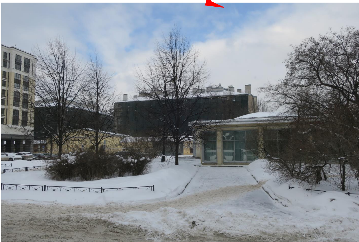
4. Вид на южный фасад объекта культурного наследия федерального значения «Скотопригонный двор. Флигели (два). Флигель», расположенного по адресу: г. Санкт-Петербург, Московский пр., д. 65, литера Ц, и объект реконструкции - зону производства работ. 07.03.2023
