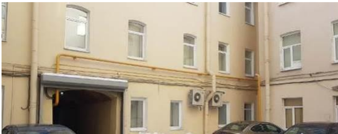
32. Дом жилой с дворовыми флигелями. Дом Пашковой Е.П. (посольство Франции). Набережная Кутузова, дом 10, литера А. Дворовые фасады. Фото мест установки оборудования и кабельных трасс. Штиглиц М.С. 10.01.2022.
