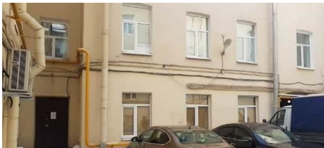
34. Дом жилой с дворовыми флигелями. Дом Пашковой Е.П. (посольство Франции). Набережная Кутузова, дом 10, литера А. Дворовые фасады. Фото мест установки оборудования и кабельных трасс. Штиглиц М.С. 10.01.2022.
