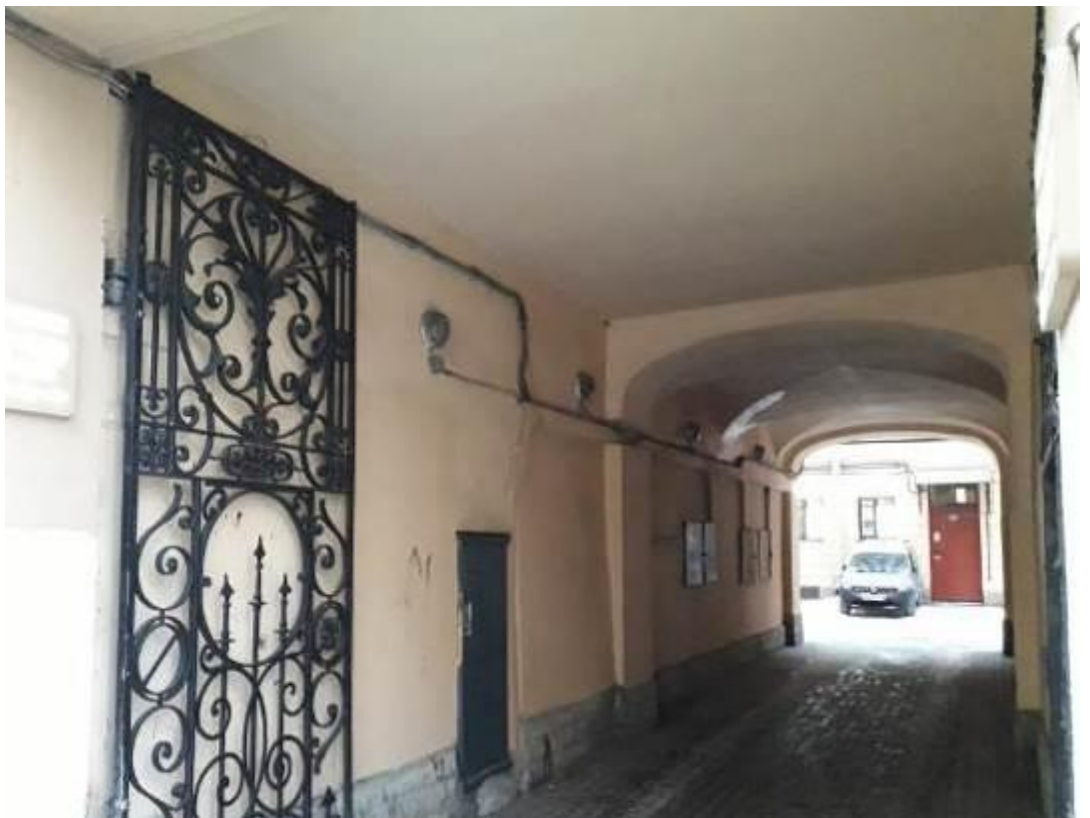
5. Дом Д.И. Тырлова. Невский пр., д. 119, литера А. Арочный проезд. Фото мест установки оборудования и кабельных трасс. Штиглиц М.С. 10.01.2022.
