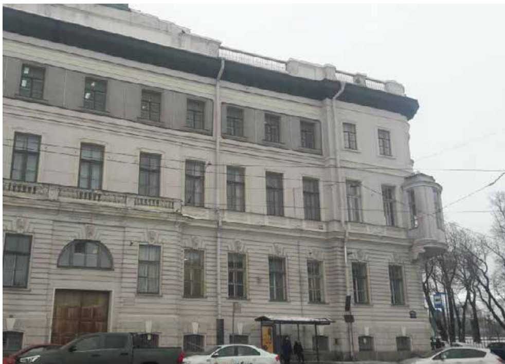
24. Дом Бецкого И.И. (принца Ольденбургского П.Г.). Миллионная улица, дом 1, литера А. Лицевой фасад. Фото мест установки оборудования и кабельных трасс. Штиглиц М.С. 10.01.2022.
