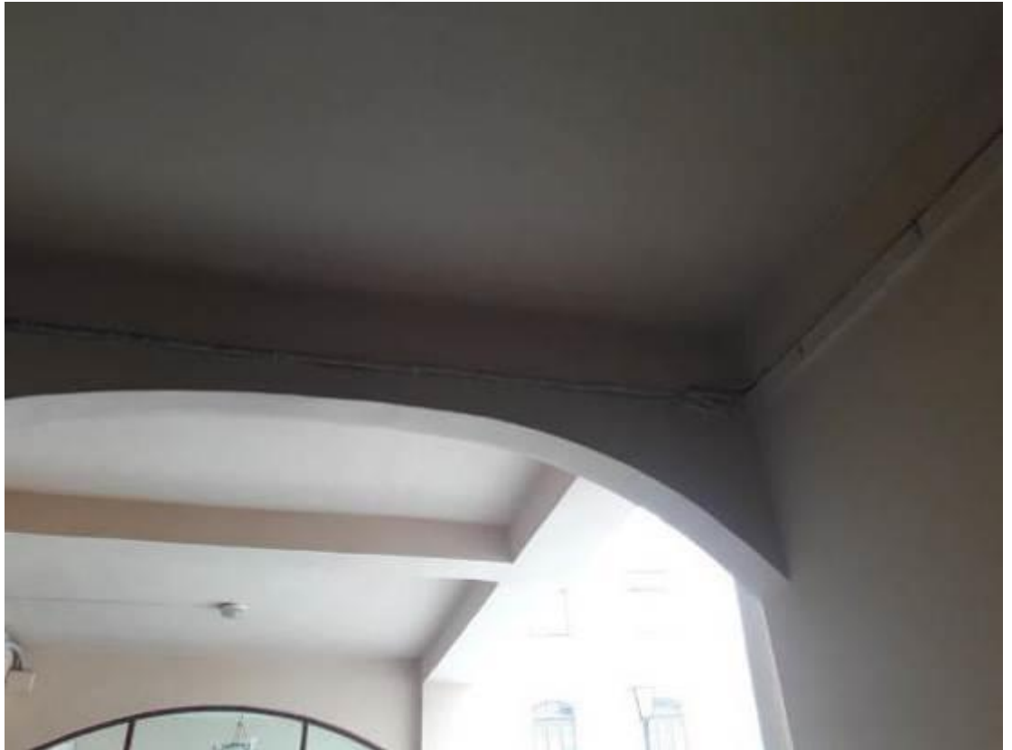
41. Главное здание (концертный зал с учебными флигелями). Капелла Придворная певческая. Набережная реки Мойки, дом 20, литера А. Фото мест установки оборудования и кабельных трасс. Штиглиц М.С. 10.01.2022.
