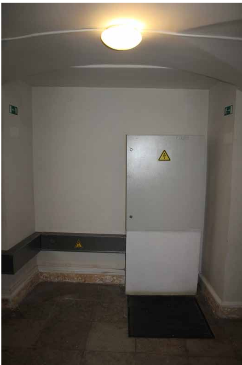
Фото №10. Общій вид на тупик в концe коридора и щиток
