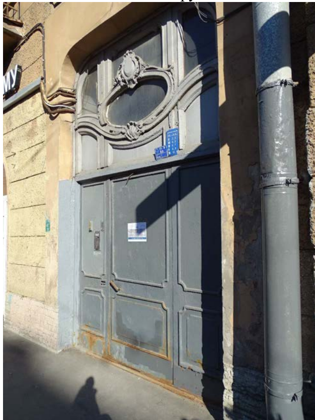
Фото 32. Здание по адресу: г. Санкт-Петербург, Большая Пушкарская ул., дом 1/8, литера А. Вид с Большой Пушкарской ул. Дверное заполнение. Съемка 19.04.2021 г. Трушковский В.Э.
