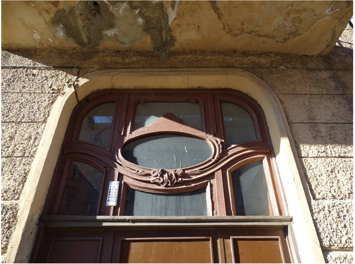
Фото 17. Здание по адресу: г. Санкт-Петербург, Большая Пушкарская ул., дом 1/8, литера А. Вид со Съезжинской ул. Фрагмент. Съемка 19.04.2021 г. Трушковский В.Э.
