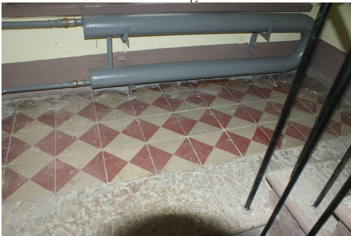
Фото 17. Лестница № 1. Площадка между 2-м и 3-м этажом. Покрытие пола. Съемка 19.04.2021 г. Трушковский В.Э.
