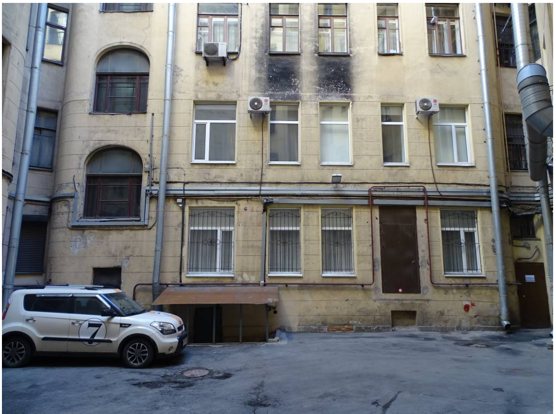
Фото 43. Здание по адресу: г. Санкт-Петербург, Большая Пушкарская ул., дом 1/8, литера А. Вид на Южный фасад. Фрагмент. Съемка 19.04.2021 г. Трушковский В.Э.
