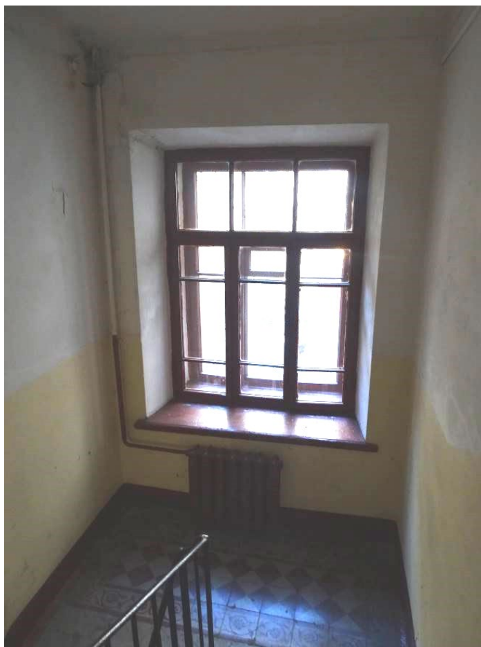
Фото 171. Лестница № 5. Вид на площадку между 1-м и 2-м этажом. Съемка 19.04.2021 г. Трушковский В.Э.
