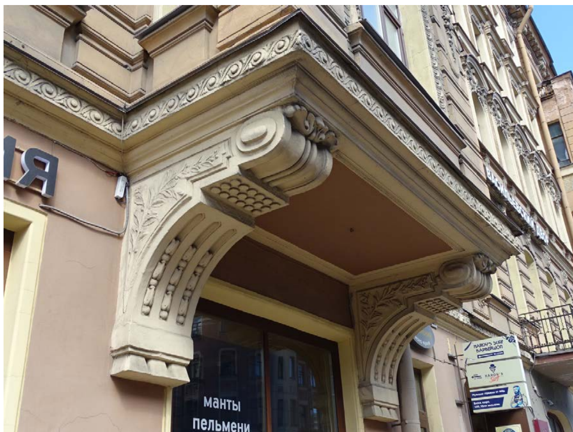
Фото 12. Здание по адресу: г. Санкт-Петербург, Средний пр. В. О., д. 11, литер А. Фрагмент лицевого фасада. Кронштейны эркера. Съемка 19.04.2021 г. Трушковский В.Э.
