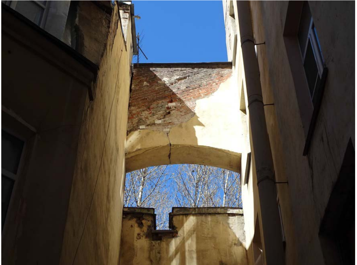
Фото 47. Здание по адресу: г. Санкт-Петербург, Средний пр. В. О., д. 11, литер А. Северо-западный двор. Съемка 19.04.2021 г. Трушковский В.Э.
