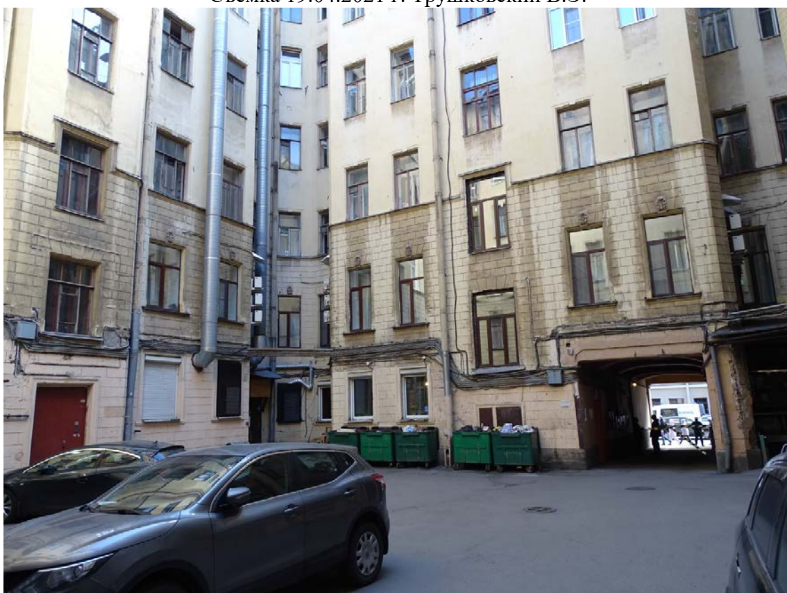
Фото 32. Здание по адресу: г. Санкт-Петербург, Средний пр. В. О., д. 11, литер А. Юго-восточный внутренний двор. Фрагмент лицевого фасада. Съемка 19.04.2021 г. Трушковский В.Э.
