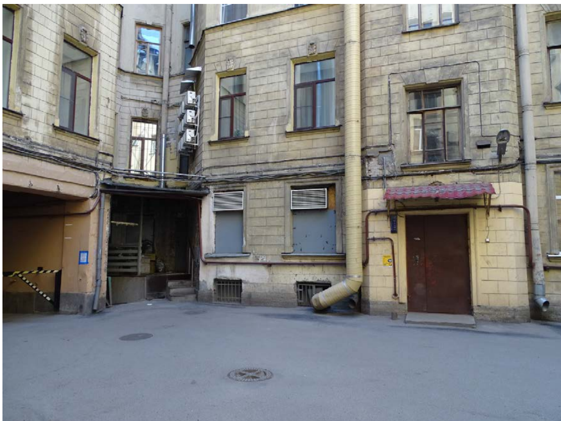
Фото 31. Здание по адресу: г. Санкт-Петербург, Средний пр. В. О., д. 11, литер А. Юго-восточный внутренний двор. Фрагмент фасада. 6-й этаж. Съемка 19.04.2021 г. Трушковский В.Э.
