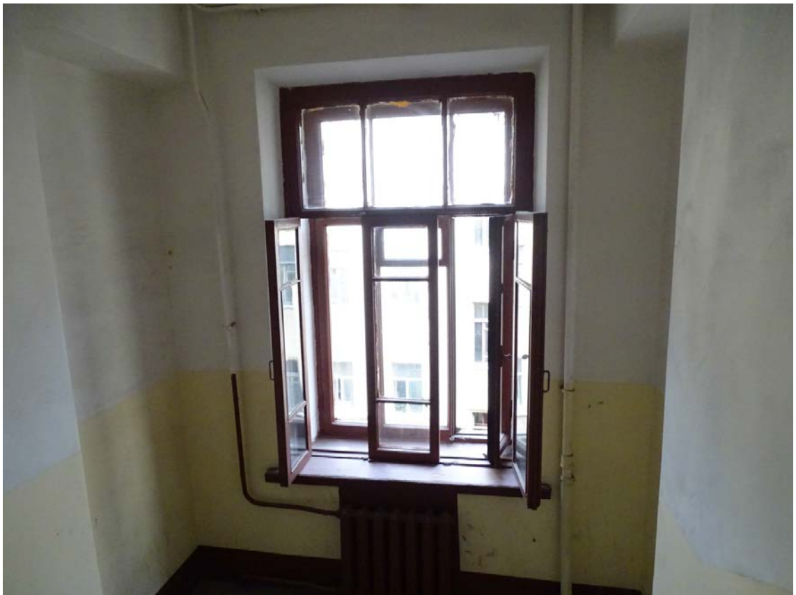
Фото 213. Лестница № 6. Вид на площадку между 4-м и 5-м этажом. Оконное заполнение. Съемка 19.04.2021 г. Трушковский В.Э.
