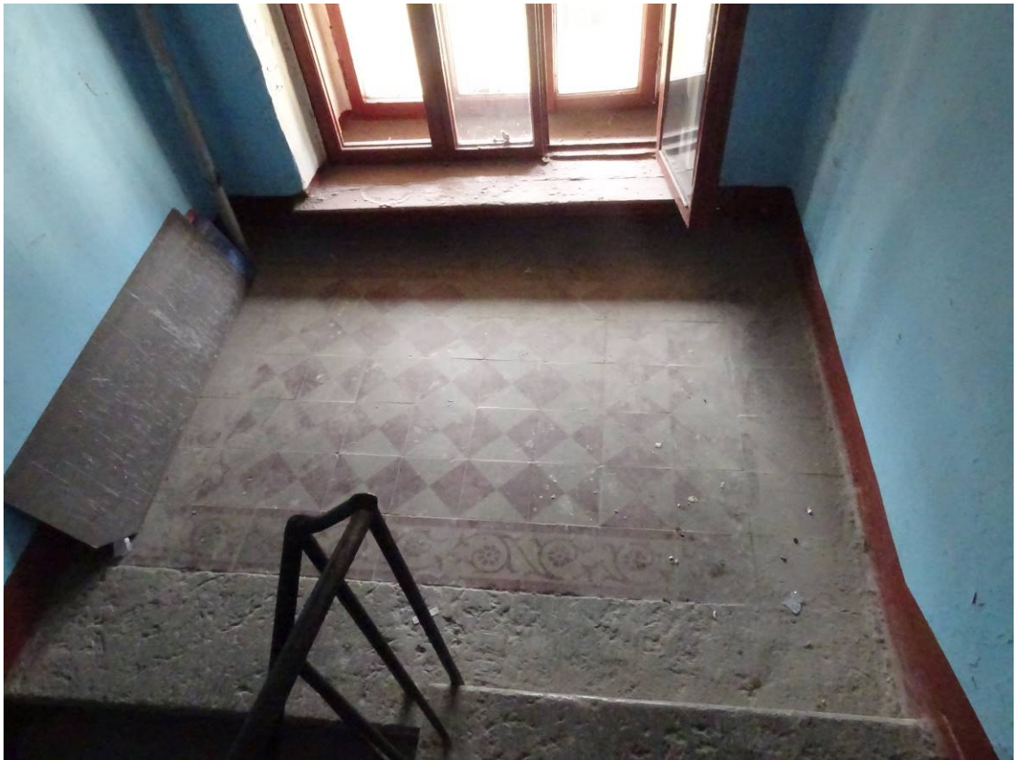
Фото 160. Лестница № 4. Площадка между 6-м и чердачным этажом. Покрытие пола. Съемка 19.04.2021 г. Трушковский В.Э.
