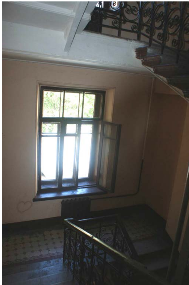
Фото 105. Лестница № 3. Вид на площадку между 4-м и 5-м этажом. Съемка 19.04.2021 г. Трушковский В.Э.
