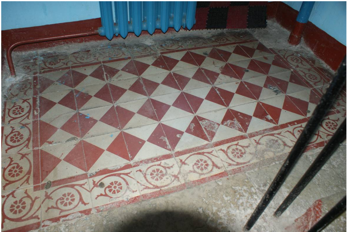
Фото 134. Лестница № 4. Площадка между 1-м и 2-м этажом. Покрытие пола. Съемка 19.04.2021 г. Трушковский В.Э.
