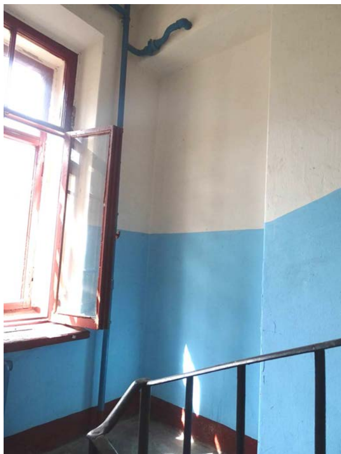
Фото 152. Лестница № 4. Площадка между 4-м и 5-м этажом. Съемка 19.04.2021 г. Трушковский В.Э.
