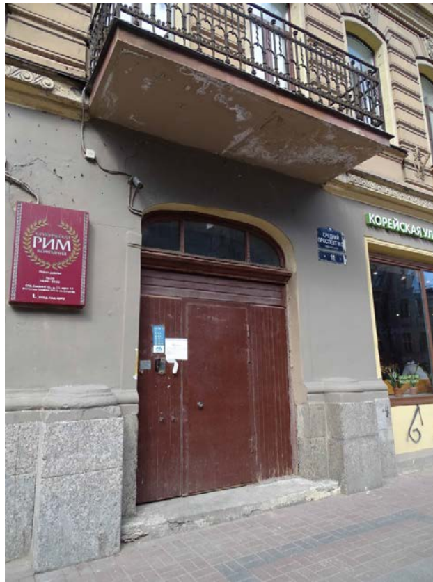
Фото 13. Здание по адресу: г. Санкт-Петербург, Средний пр. В. О., д. 11, литер А. Фрагмент лицевого фасада. Дверь в парадную. Съемка 19.04.2021 г. Трушковский В.Э.
