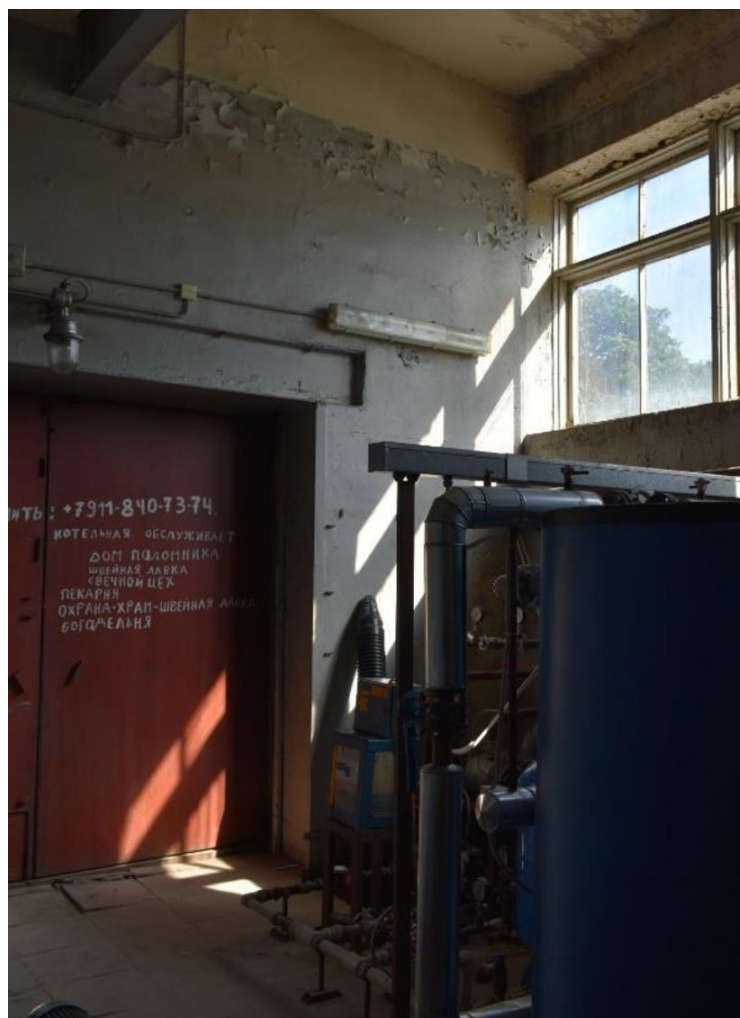
16. Объект культурного наследия федерального значения «Монастырь Воскресенский Новодевичий». «Хозяйственная постройка» - часть объекта культурного наследия федерального значения "Хозяйственная постройка (три)", 1868-1869 гг. по адресу: Санкт-Петербург, Московский просп., д. 100, лит. О». Техническое помещение. Общий вид.
