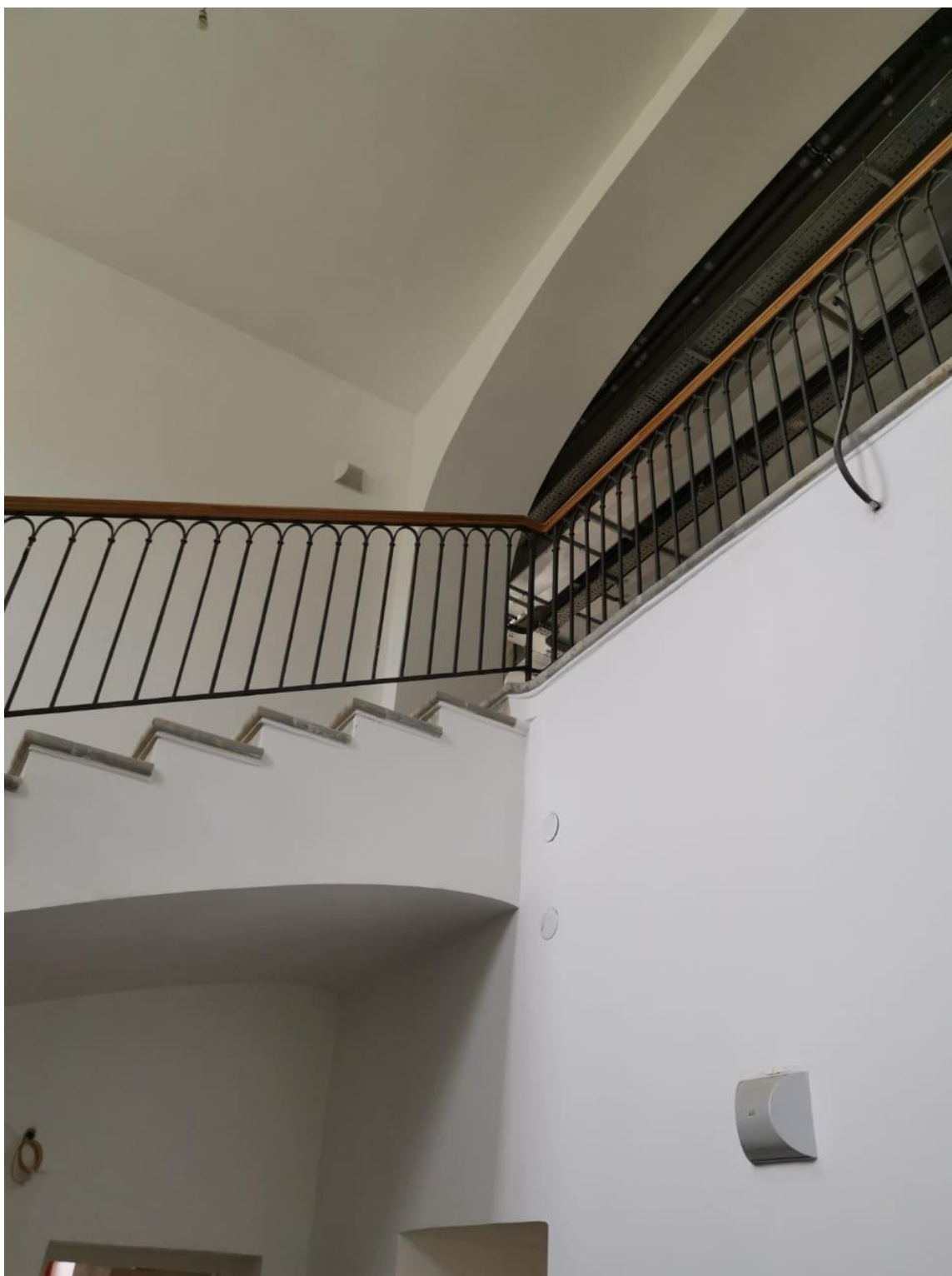
Фото 10. Орлово-Новосильцевская богадельня, пр. Энгельса, д.1, стр.2. Лестничная клетка в осях 7-8/Г-Е. Верхний марш и проем 2-го этажа (7-8/Г). 19.05.2021г.
