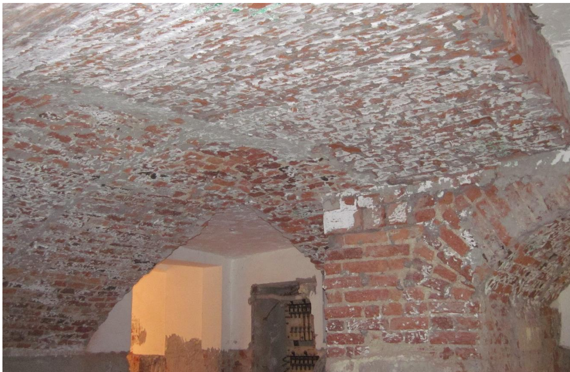
Фото 18. Орлово-Новосильцевская богадельня, пр. Энгельса, д.1, стр.2. Подвал в осях 7-8/Г-Е. Пересечение главной арки в осях Г÷Е и полуарки в осях 7-8. 19.05.2021г.
