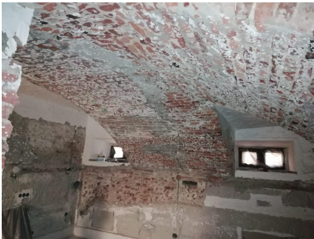
Фото 15. Орлово-Новосильцевская богадельня, пр. Энгельса, д.1, стр.2. Общий вид перекрытия подвала в осях 7-8/Г-Е. Главная арка опирается на стены в осях Е и Г, часть полуарки опирается на стену по оси 8 и на главную стену. 19.05.2021г.
