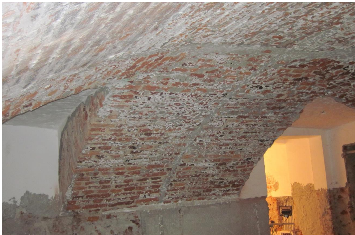
Фото 19. Орлово-Новосильцевская богадельня, пр. Энгельса, д.1, стр.2. Подвал в осях 7-8/Г-Е. Вид на стену по оси «8». 19.05.2021г.
