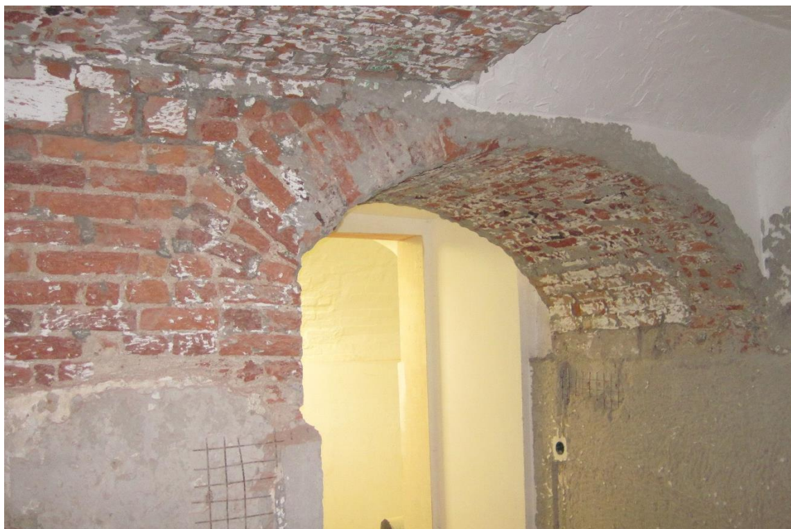
Фото 17. Орлово-Новосильцевская богадельня, пр. Энгельса, д.1, стр.2. Подвал в осях 7-8/Г-Е. Вид на арку. 19.05.2021г.
