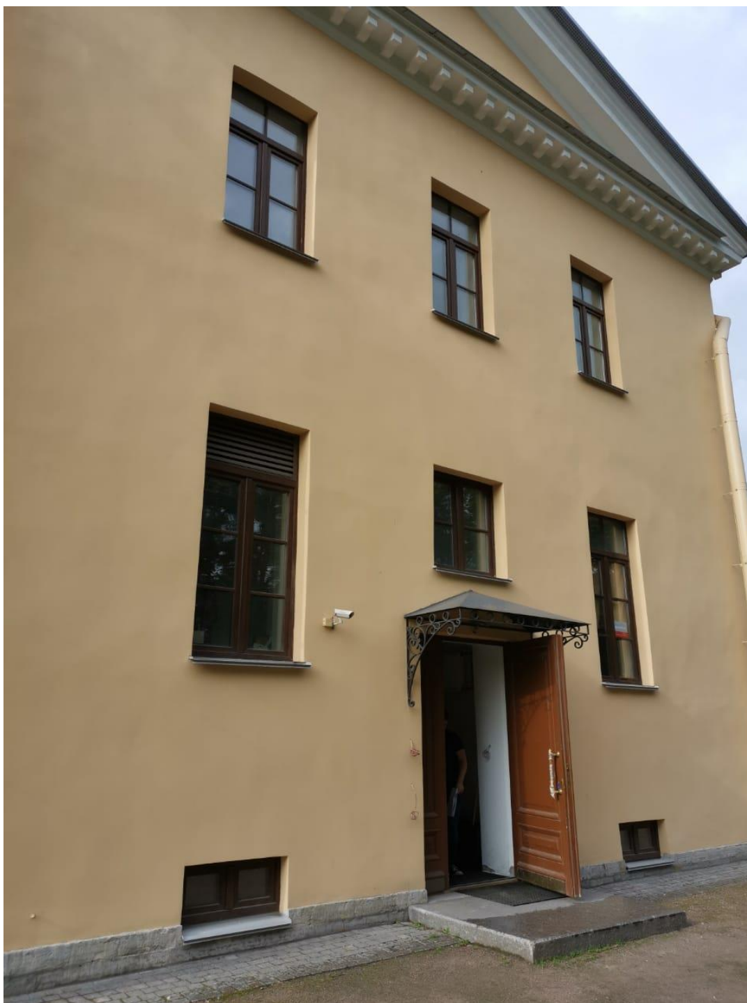
Фото 5. Орлово-Новосильцевская богадельня, пр. Энгельса, д.1, стр.2. Фрагмент торцевого фасада. Вид с юга. 19.05.2021г.
