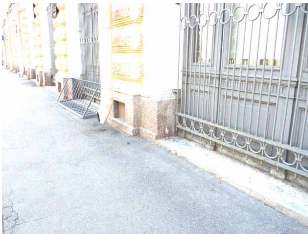
Фото 3. Биржевая линия, дом №14, фото вдоль главного фасада. Металлические декоративные решетки дверных проемов, гранитный цоколь, асфальтобетонная отмостка (тротуар).
