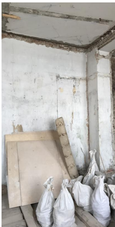
Фото 14. Интерьер квартиры №1, расположенной в объекте культурного наследия регионального значения «Дом № 48», входящем в состав объекта культурного наследия регионального значения «Дома П.К. Ферзена (А.Я. Прозорова)», 2 эт.
