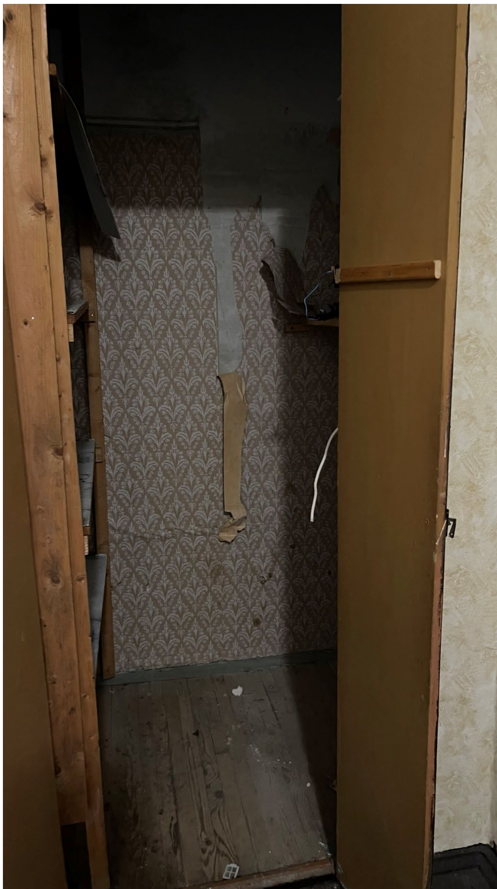
18. Вид на шкаф (помещение №6/1.6);
