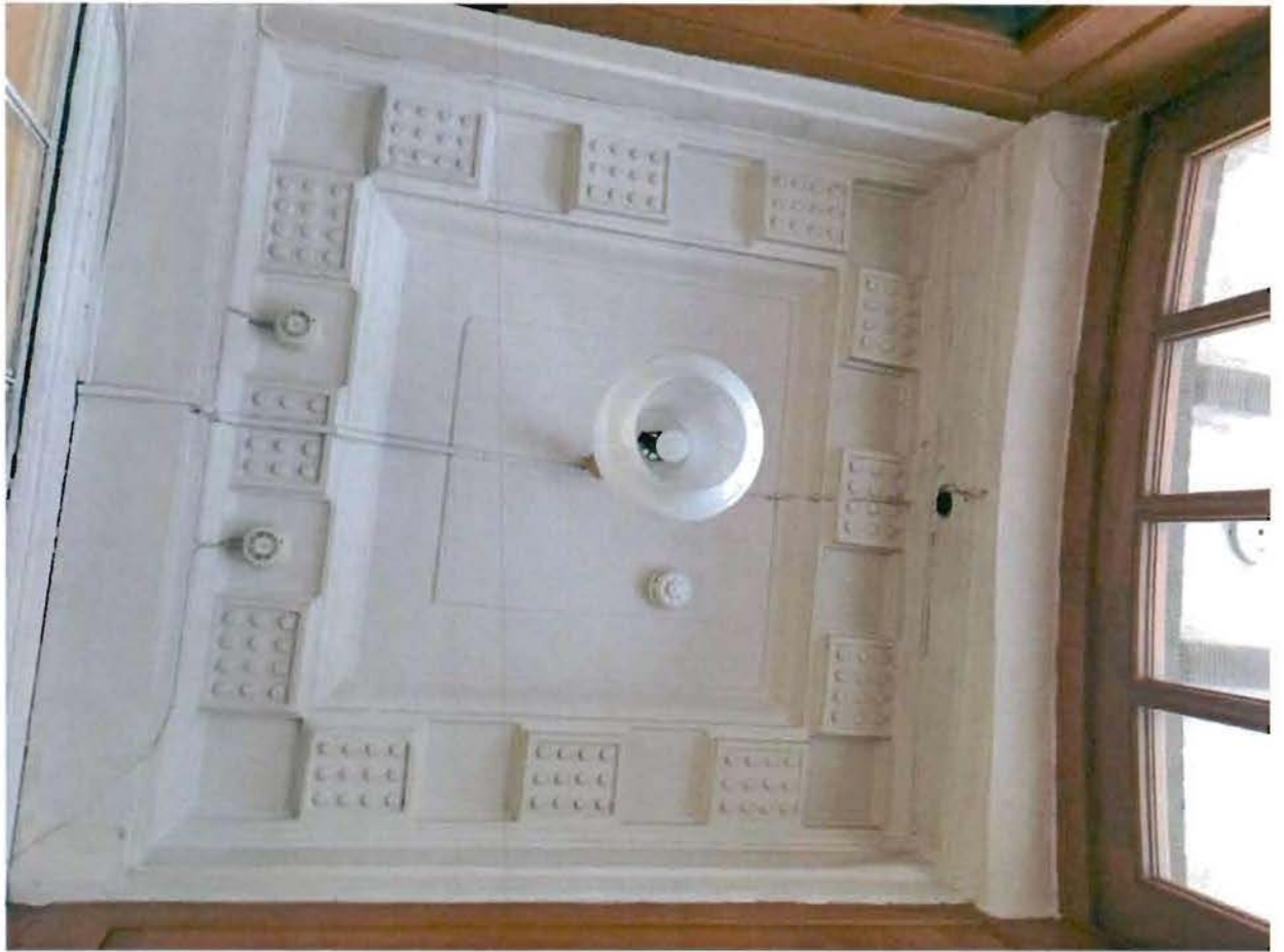
Фото 21. Потолок входного тамбура.
