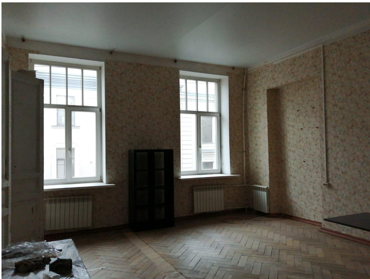
Фото 23. Объект культурного наследия регионального значения «Здание второй гимназии императора Александра I с жилым домом», Санкт-Петербург, Казанская улица, дом 27, литера А. Квартира 3, помещение 16. Заполнение оконного проема.
