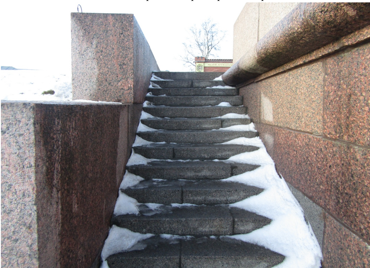
Фото 10. Вид на лестницу спуска объекта культурного наследия федерального значения «Набережные Кронверкского пролива»
