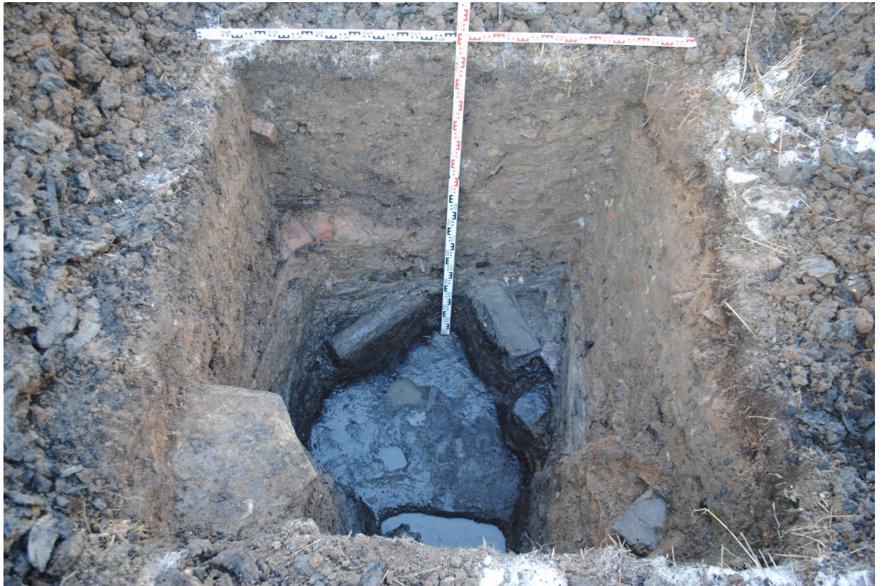
Рис. 32. Санкт-Петербург, Кубинская улица. Шурф 1. Фиксация слою серой супеси (материк). Уровень прекращения работ. Вид на север.
