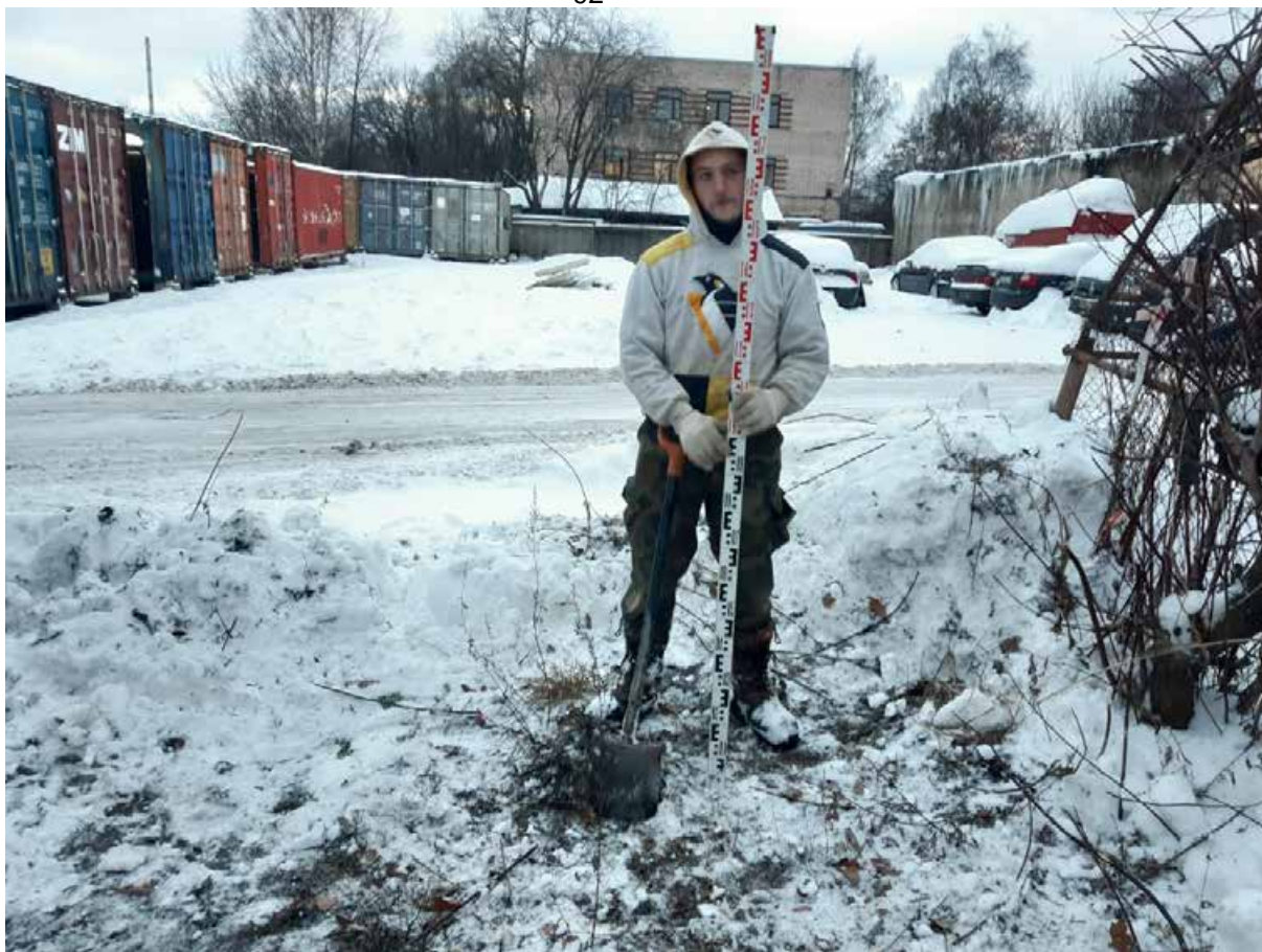
Рис. 38. Санкт-Петербург, набережная реки Волковки, земельный участок 15а (кадастровый номер: 78:13:0007322:1753). Шурф 1. Общий вид до начала работ. Вид на северо-запад.
