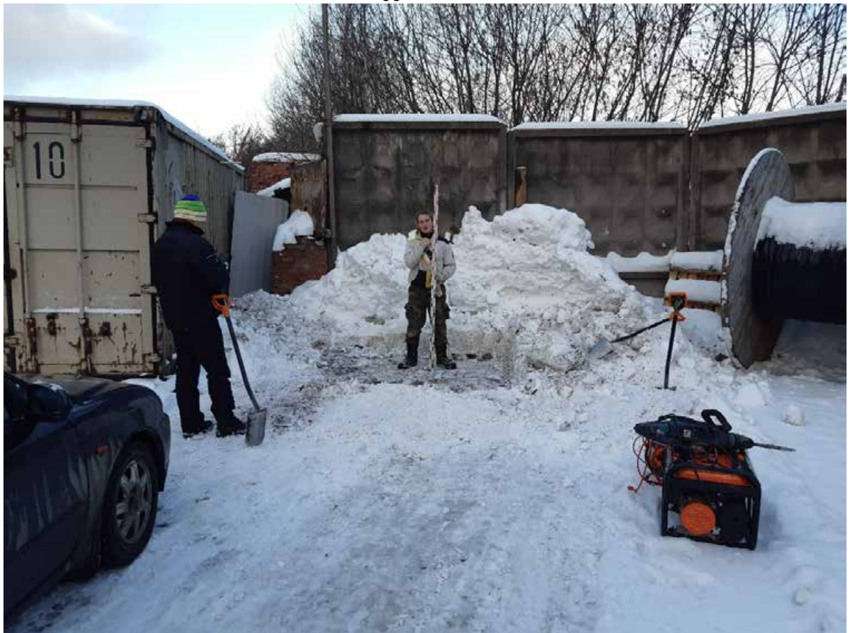
Рис. 48. Санкт-Петербург, набережная реки Волковки, земельный участок 15а (кадастровый номер: 78:13:0007322:1753). Шурф 2. Общий вид до начала работ. Вид на северо-запад.
