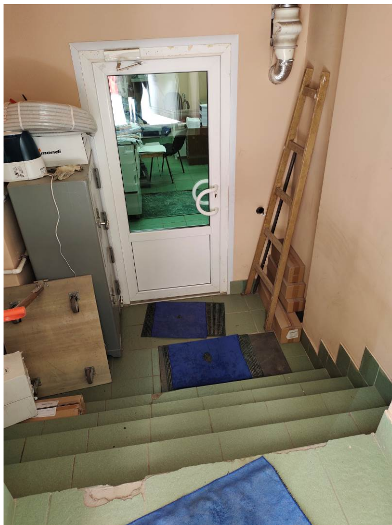
5. Выявленный ОКН «Склады торгового дома «Братья Елисеевы»» (здание ГОИ им. С.И. Вавилова). Первый этаж.
