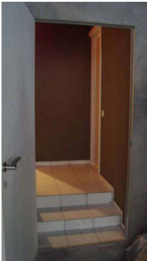
20. Первый этаж, помещение 1-Н. Зал (пом. 120). Вид на раскрытый исторический дверной проём по оси «2» в осях «Б-В».
