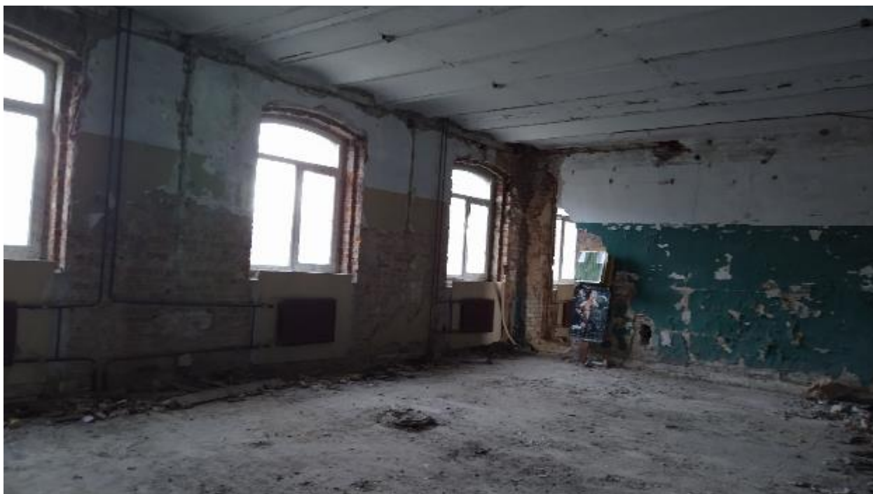
14. Помещение №5 в уровне 1-го этажа выявленного объекта культурного наследия «Комплекс Санкт-Петербургской женской исправительной тюрьмы. Служительский корпус», расположенного по адресу: г. Санкт-Петербург, Арсенальная улица, дом 9, литера Д. 24.08.2021.
