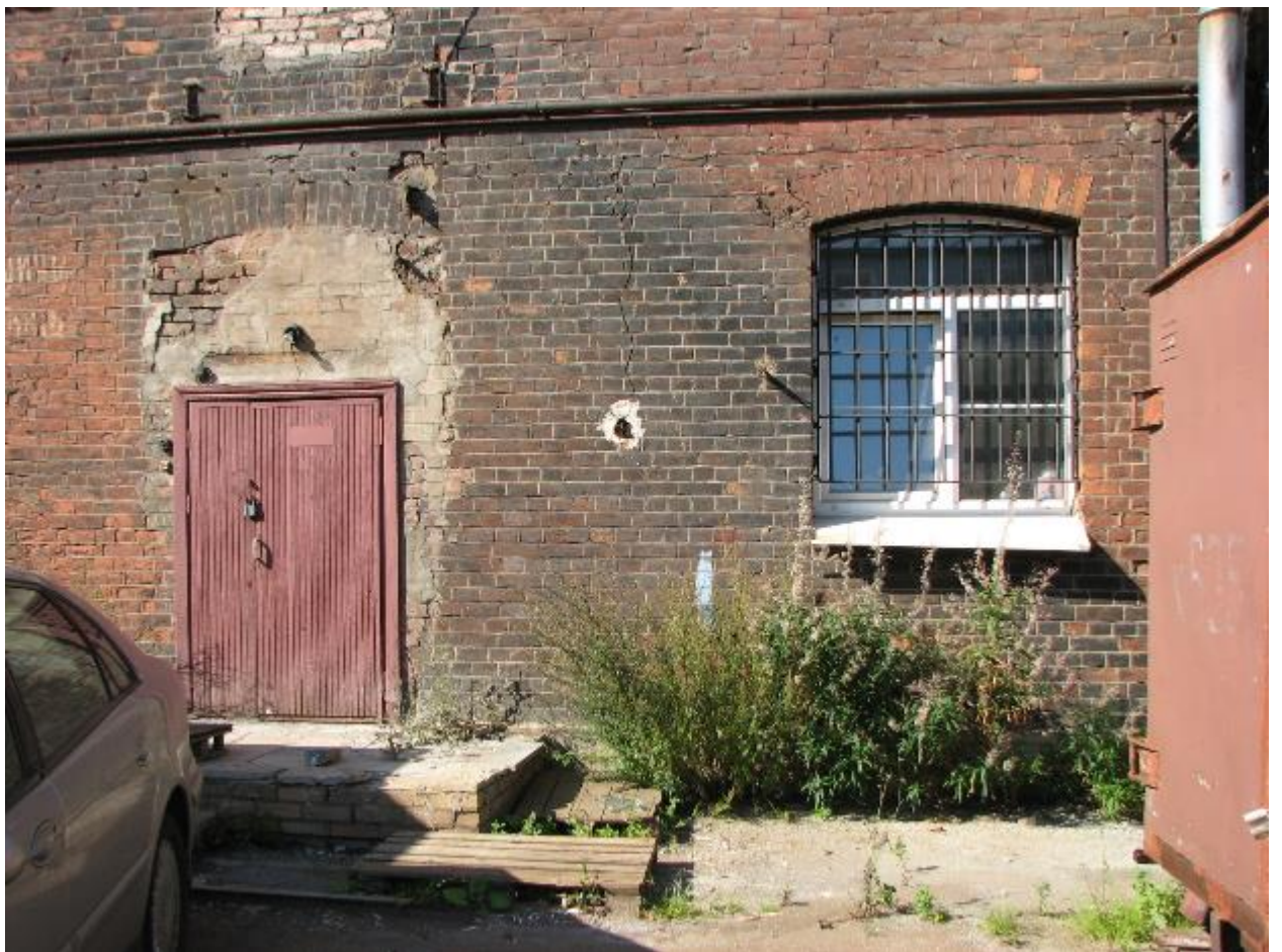
10. Перебитый дверной проем на юго-восточном фасаде выявленного объекта культурного наследия «Комплекс Санкт-Петербургской женской исправительной тюрьмы. Служительский корпус», расположенного по адресу: г. Санкт-Петербург, Арсенальная улица, дом 9, литера Д. 24.08.2021.
