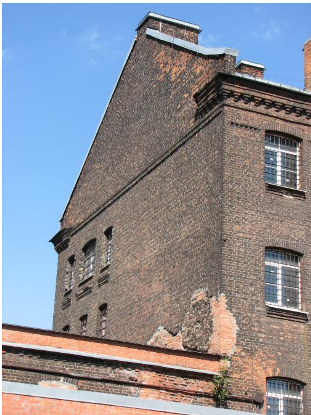
7. Юго-западный фасад выявленного объекта культурного наследия «Комплекс Санкт-Петербургской женской исправительной тюрьмы. Служительский корпус», расположенного по адресу: г. Санкт-Петербург, Арсенальная улица, дом 9, литера Д. Фрагмент. 24.08.2021.
