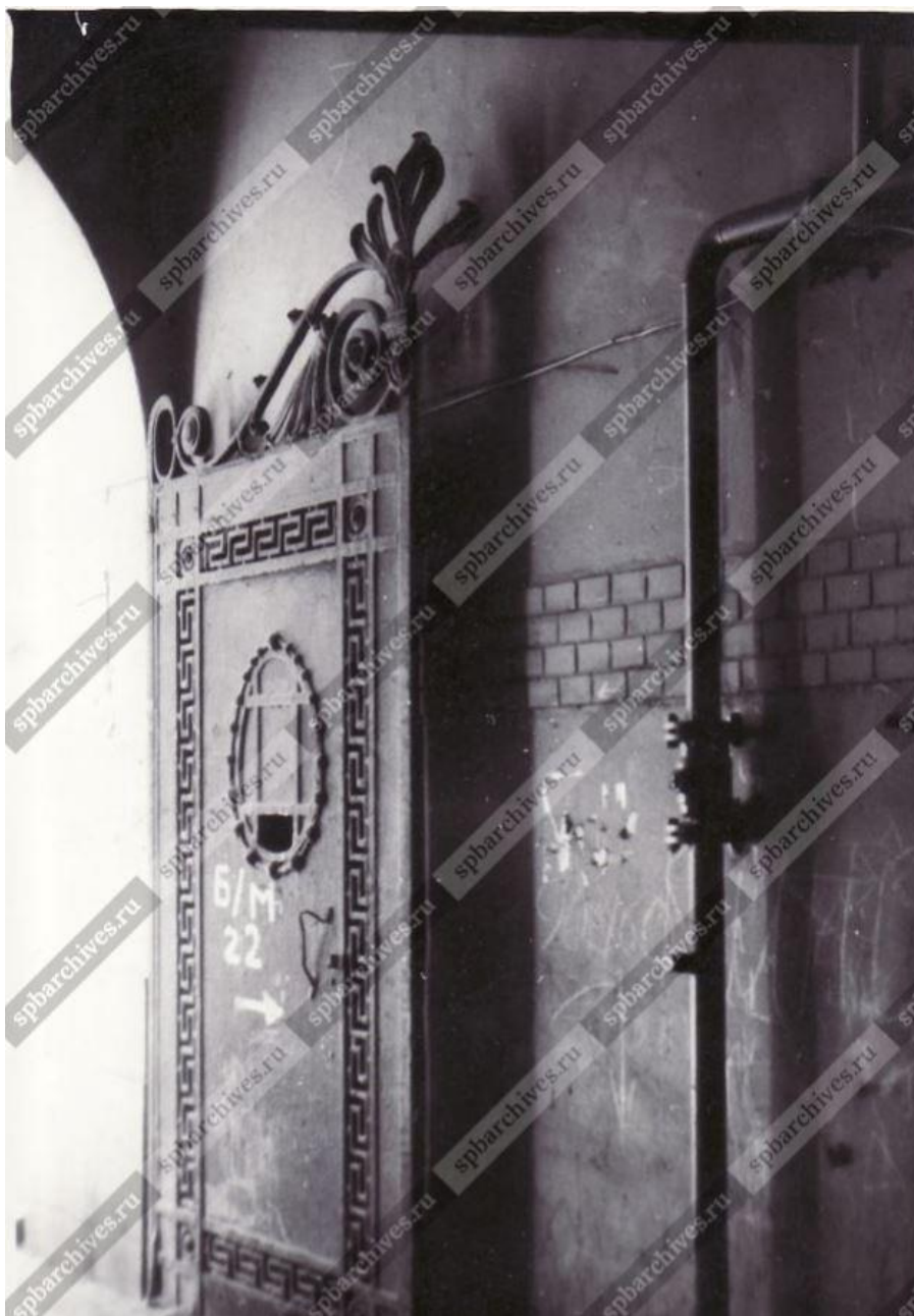
38. Вид створки ворот арки, выходящей на Большую Монетную улицу дома №22 (архитектор А.И.Балинский, 1908 год). Дата съёмки: 07 апреля 2004 г. Архивный шифр: ЦГАКФФД СПб Ар 215747
