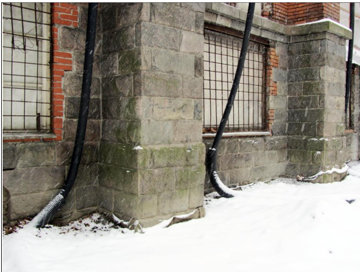
19. Объект культурного наследия федерального значения «Храм римско-католический Святого Сердца Господа Иисуса». Фрагменты цокольного этажа западного фасада.
