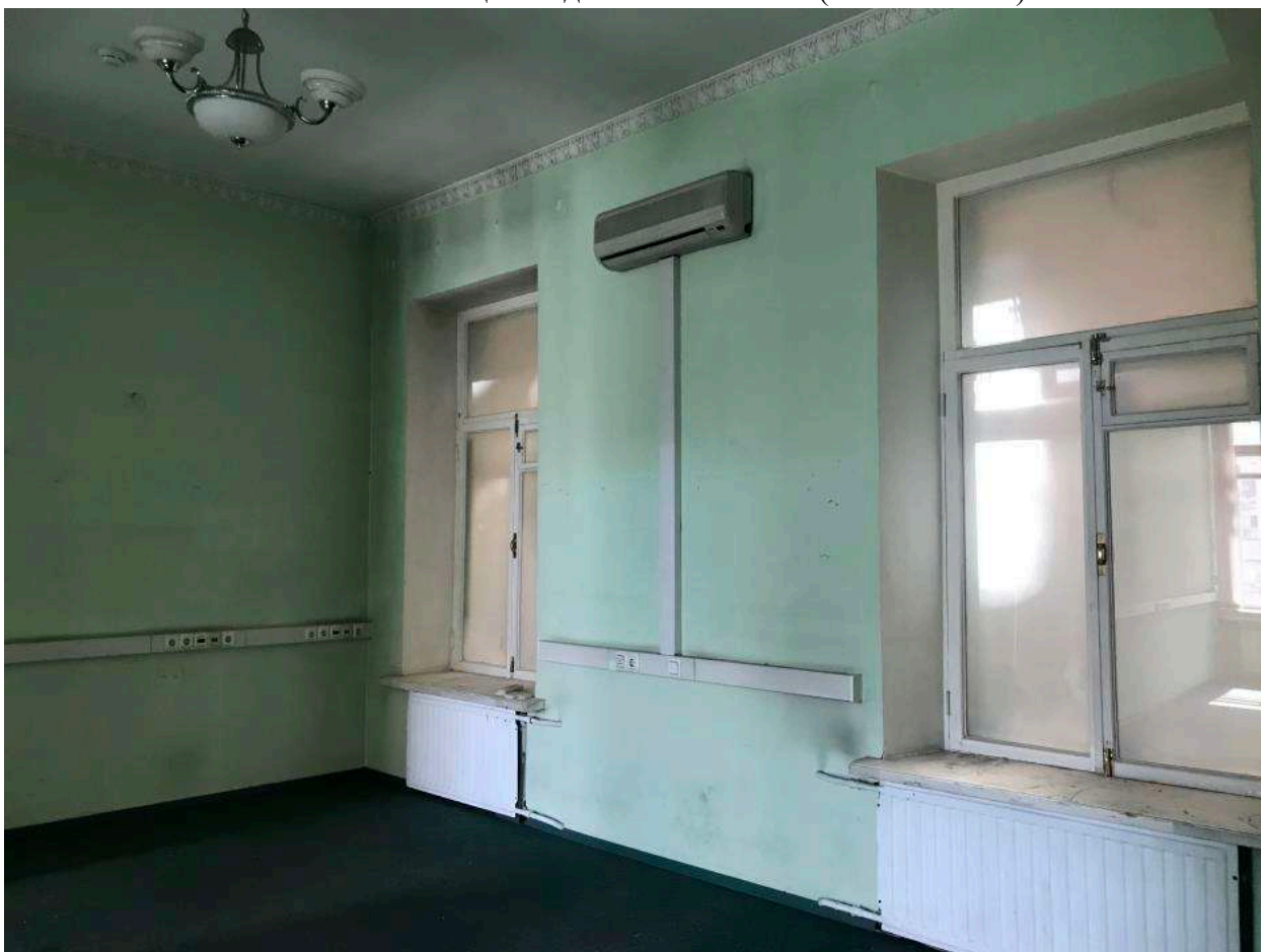
Фото 59. Общий вид части пом. 26-Н (№ 52 по ПИБ). Лепная орнаментированная розетка на потолке, орнаментированная тяга в верхней части стен.
