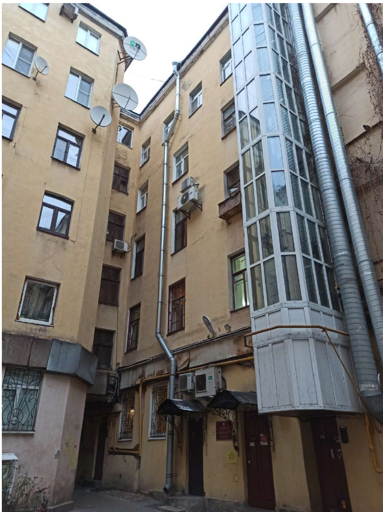
Фото 10. Вид на часть дворового фасада, наблюдается установка дополнительного оборудования, замена оконных заполнений.
