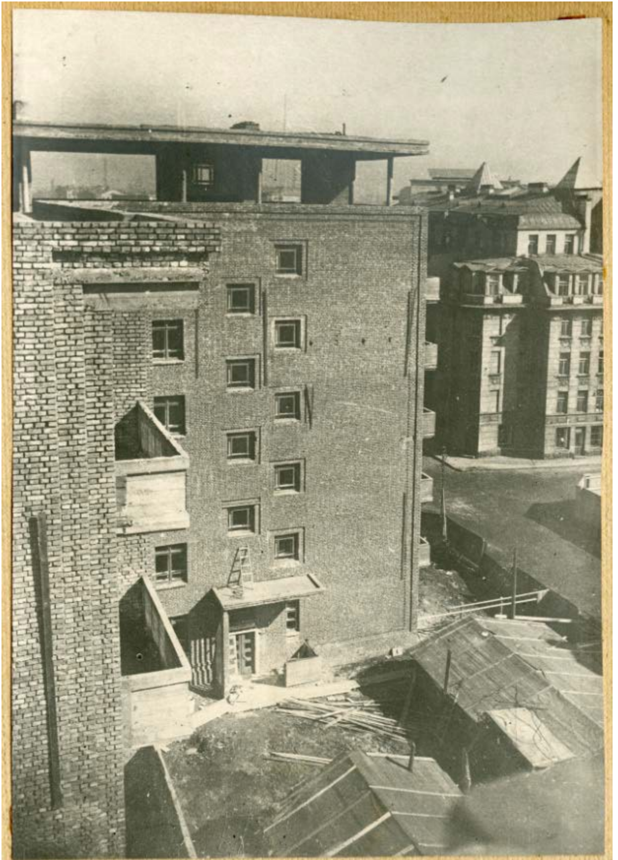
Илл. 26. Общий вид с крыши дома № 84-86 (жилой дом работников "Свирьстроя") в процессе строительства. Архитектор И. Явейн, 1936 г.
