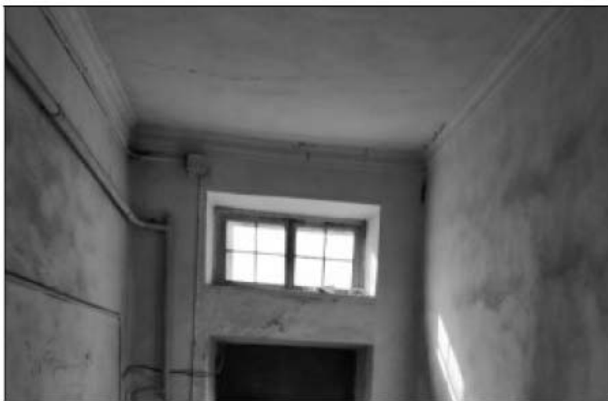
54. Объект культурного наследия федерального значения «Церковь англиканская Иисуса Христа. Церковь» (Галерная улица, дом 57, литера Б). 1-й этаж, помещение № 1 (ЛК-1). Оконный проем над входом. 13.02.2023 г.
