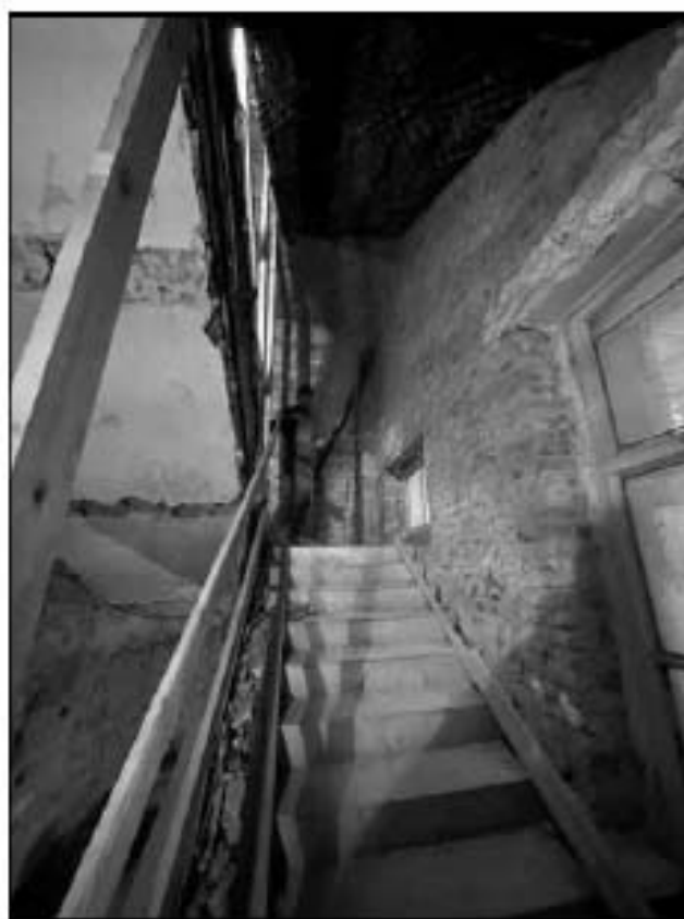
50. Объект культурного наследия федерального значения «Церковь англиканская Иисуса Христа. Церковь» (Галерная улица, дом 57, литера Б). 1-й этаж, помещение № 1-Н (24). Службная лестница. 13.02.2023 г.
