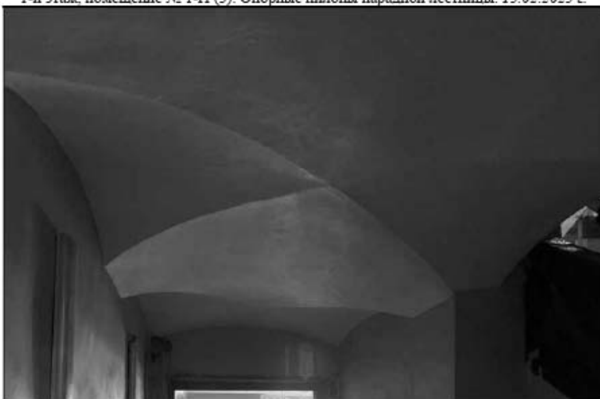
40. Объект культурного наследия федерального значения «Церковь англиканская Иисуса Христа. Церковь» (Галерная улица, дом 57, литера Б). 1-й этаж, помещение № 1-Н (3). Крестовый свод парадной лестницы. 13.02.2023 г.
