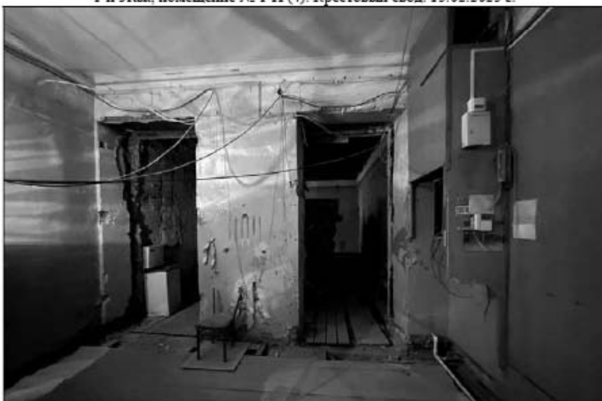
46. Объект культурного наследия федерального значения «Церковь англиканская Иисуса Христа. Церковь» (Галерная улица, дом 57, литера Б). 1-й этаж, помещения №№ 1-Н (6, 7, 8, 9, 10). Входы в помещение № 1-Н (14). 13.02.2023 г.
