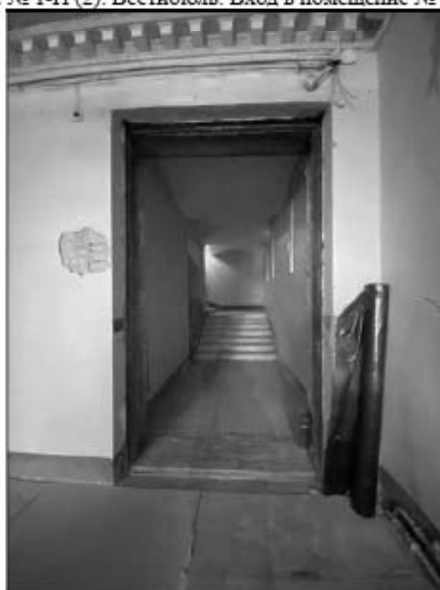
37. Объект культурного наследия федерального значения «Церковь англиканская Иисуса Христа. Церковь» (Галерная улица, дом 57, литера Б). 1-й этаж, помещение № 1-Н (2). Вход в помещения парадной лестницы № 1-Н (3, 5). 13.02.2023 г.
