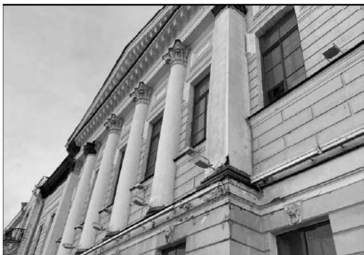
6. Объект культурного наследия федерального значения «Церковь англиканская Иисуса Христа. Церковь» (Галерная улица, дом 57, литера Б). Лицевой фасад. Портик центрального ризалита. Вид с северо-запада. 13.02.2023 г.
