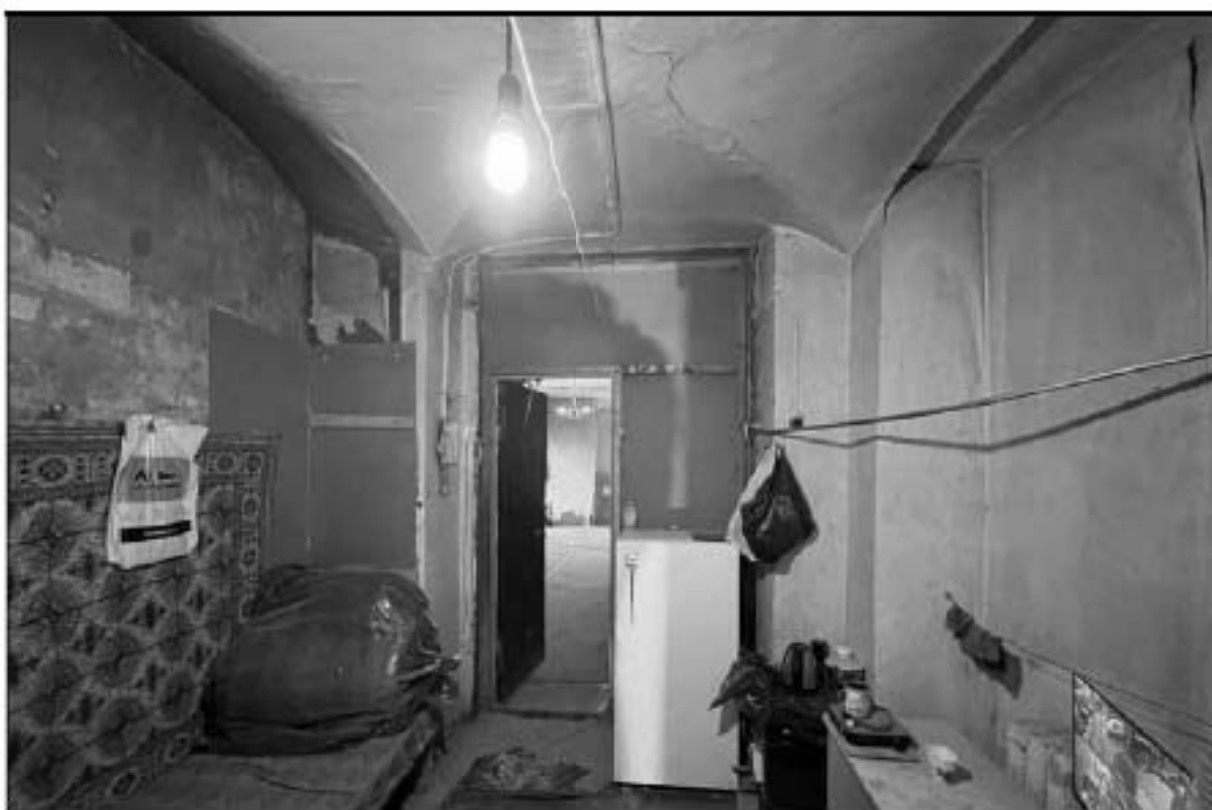
43. Объект культурного наследия федерального значения «Церковь англиканская Иисуса Христа. Церковь» (Галерная улица, дом 57, литера Б). 1-й этаж, помещение № 1-Н (4). Вход в помещение № 1-Н (2). 13.02.2023 г.
