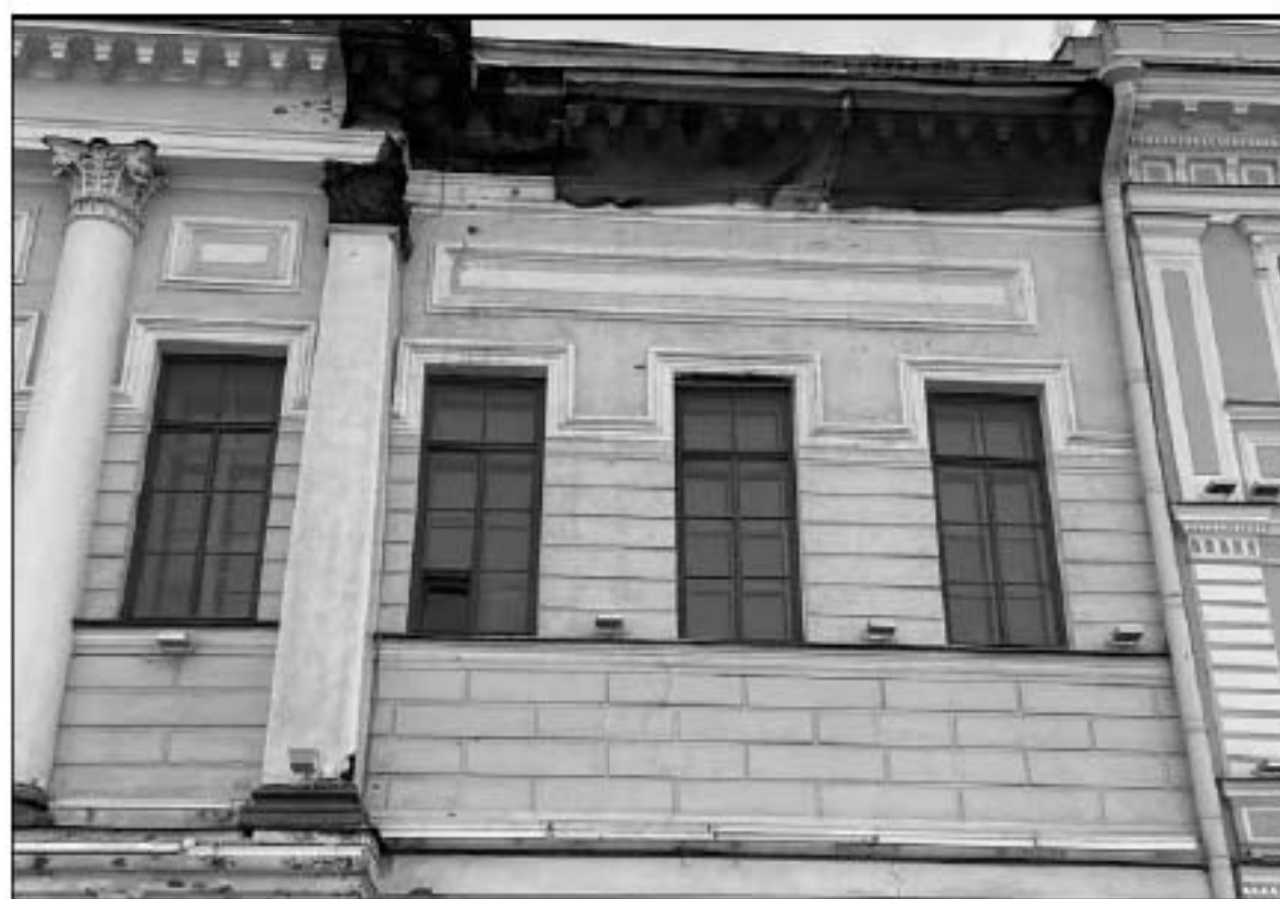
14. Объект культурного наследия федерального значения «Церковь англиканская Иисуса Христа. Церковь» (Галерная улица, дом 57, литера Б). Западная часть лицевого фасада. Оконные проемы 2-го этажа. 13.02.2023 г.
