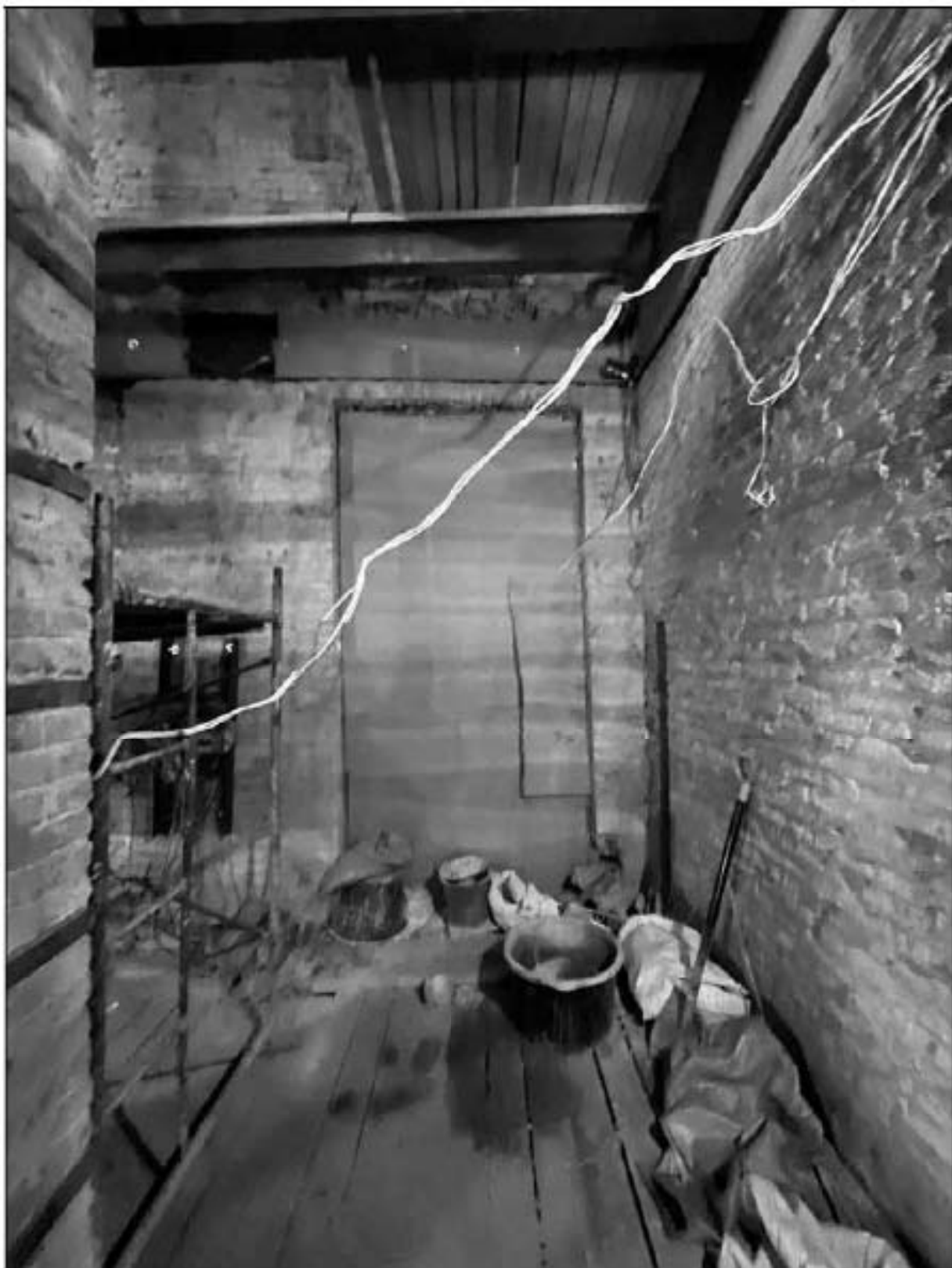
78. Объект культурного наследия федерального значения «Церковь англиканская Иисуса Христа. Церковь» (Галерная улица, дом 57, литера Б). 2-й этаж, помещение № 1-Н (32). Вход в помещение № 1-Н (34). 13.02.2023 г.
