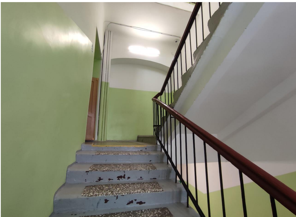
43. Выявленный объект культурного наследия «Школа нянь», по адресу: Санкт-Петербург, город Пушкин, Красносельское шоссе, дом 9, литера А. Общий вид площадки двухмаршевой лестницы поперечного дворового корпуса (пом. 2-Н (37)) в уровне 2-го этажа.
