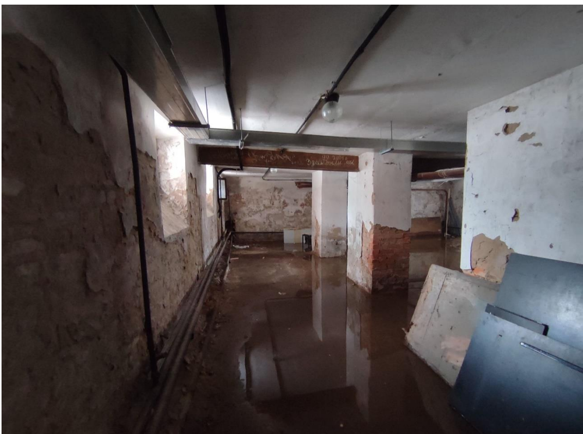
15. Выявленный объект культурного наследия «Школа нянь», по адресу: Санкт-Петербург, город Пушкин, Красносельское шоссе, дом 9, литера А. Фрагмент пом. 4-Н (9) в уровне подвала.
