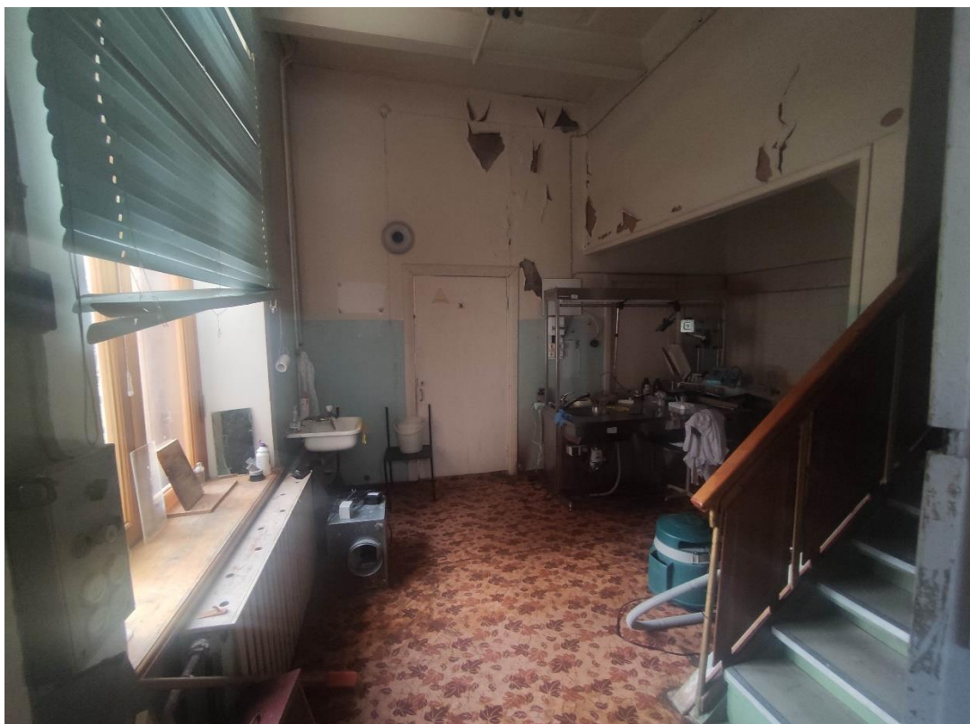
83. Объект культурного наследия федерального значения «Дворец герцога Максимилиана Лейхтенбергского с перголами и лестницами», расположенный по адресу: Санкт-Петербург, город Петергоф, Ораниенбаумское шоссе, дом 2, литера А. Общий вид пом. № 1-Н(14).
