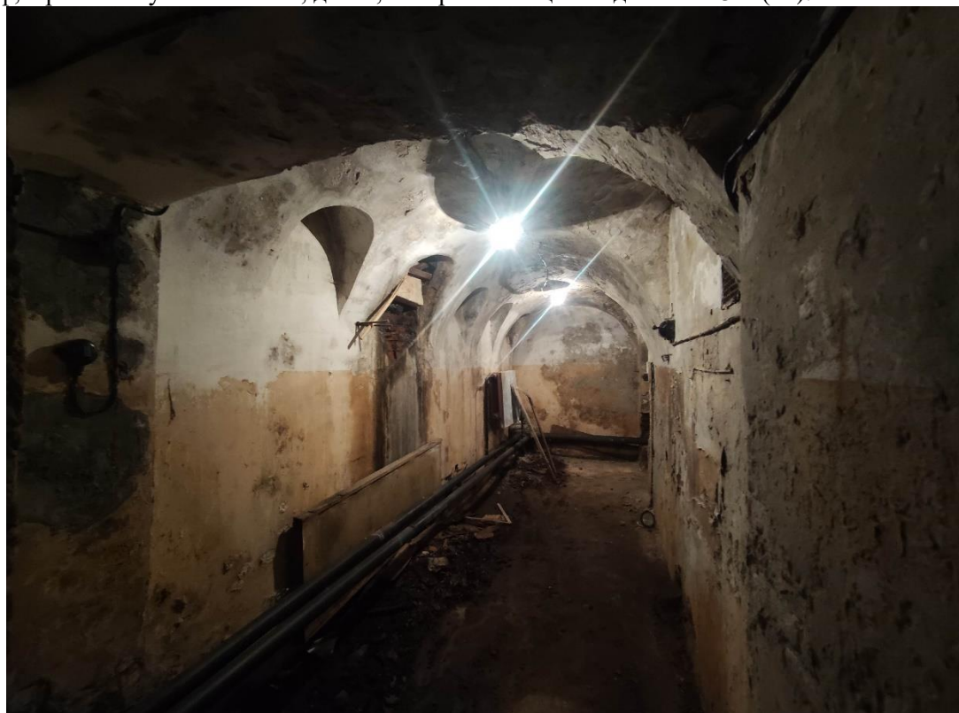
36. Объект культурного наследия федерального значения «Дворец герцога Максимилиана Лейхтенбергского с перголами и лестницами», расположенный по адресу: Санкт-Петербург, город Петергоф, Ораниенбаумское шоссе, дом 2, литера А. Общий вид пом. № 3-Н(7).
