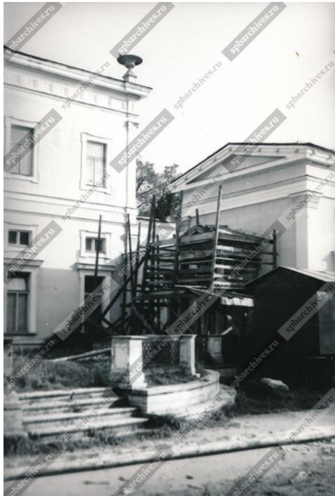
29. Вид части фасада дворца Максимилиана Лейхтенбергского во время реставрации (архитектор А.И. Штакеншнейдер, 1839- 1842 гг., архитектор -реставратор В.И. Зейдеман, 1974 -е годы). Архивный шифр: ЦГАКФФД СПб Ар 236227. Дата съёмки: 01 октября 1981 год.
