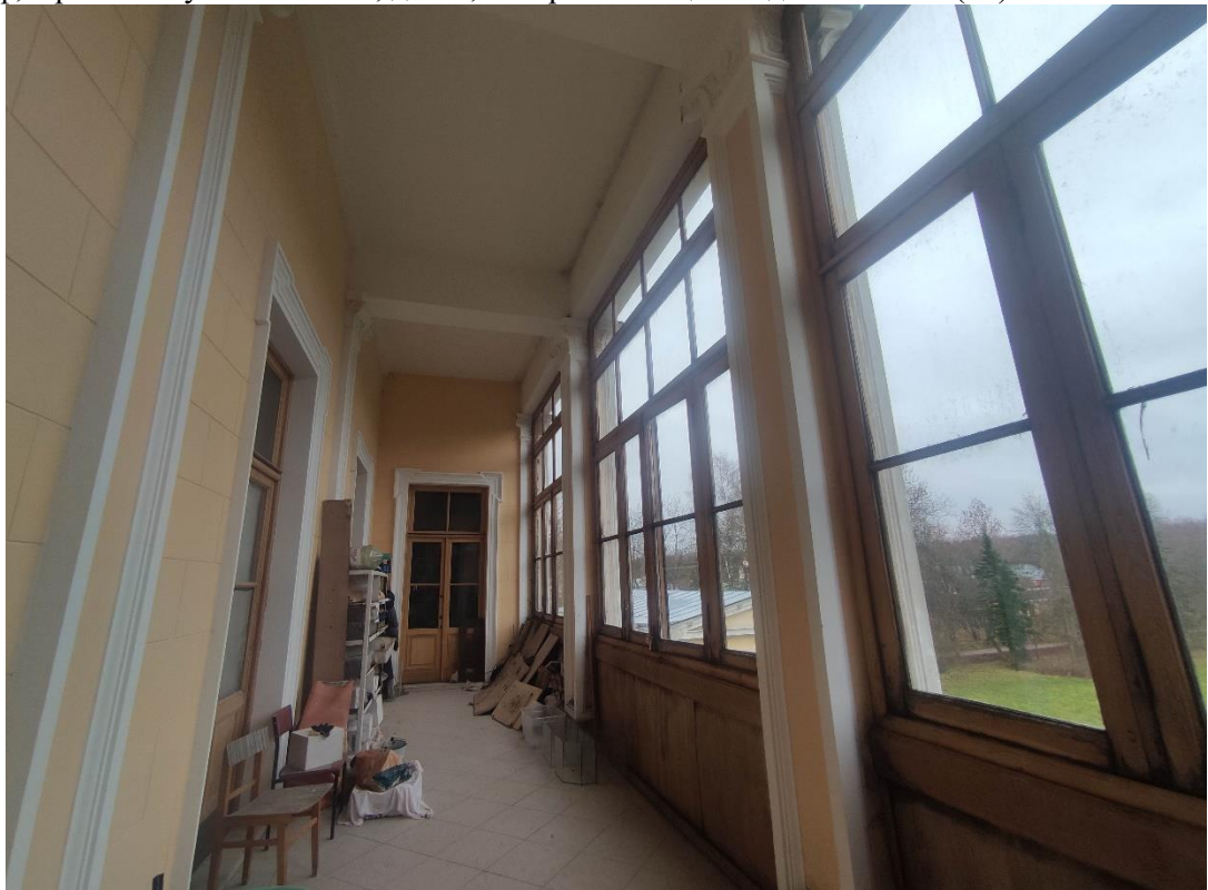
62. Объект культурного наследия федерального значения «Дворец герцога Максимилиана Лейхтенбергского с перголами и лестницами», расположенный по адресу: Санкт-Петербург, город Петергоф, Ораниенбаумское шоссе, дом 2, литера А. Общий вид пом. № б/н в отметке 3-го этажа.
