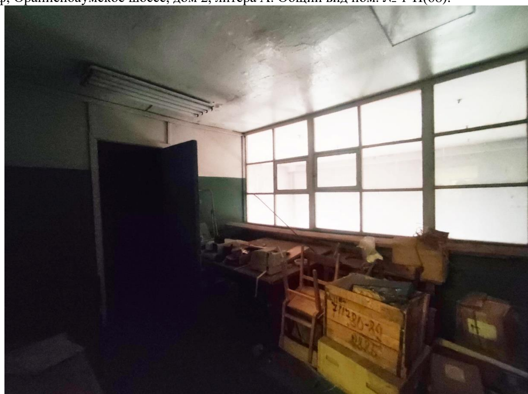
56. Объект культурного наследия федерального значения «Дворец герцога Максимилиана Лейхтенбергского с перголами и лестницами», расположенный по адресу: Санкт-Петербург, город Петергоф, Ораниенбаумское шоссе, дом 2, литера А. Общий вид пом. № 1-Н(69).
