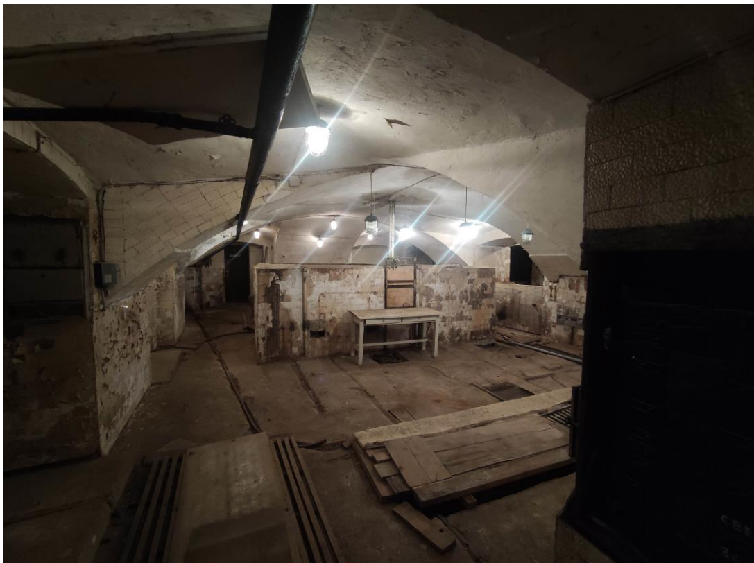
17. Объект культурного наследия федерального значения «Дворец герцога Максимилиана Лейхтенбергского с перголами и лестницами», расположенный по адресу: Санкт-Петербург, город Петергоф, Ораниенбаумское шоссе, дом 2, литера А. Общий вид пом. № 3-Н(32).
