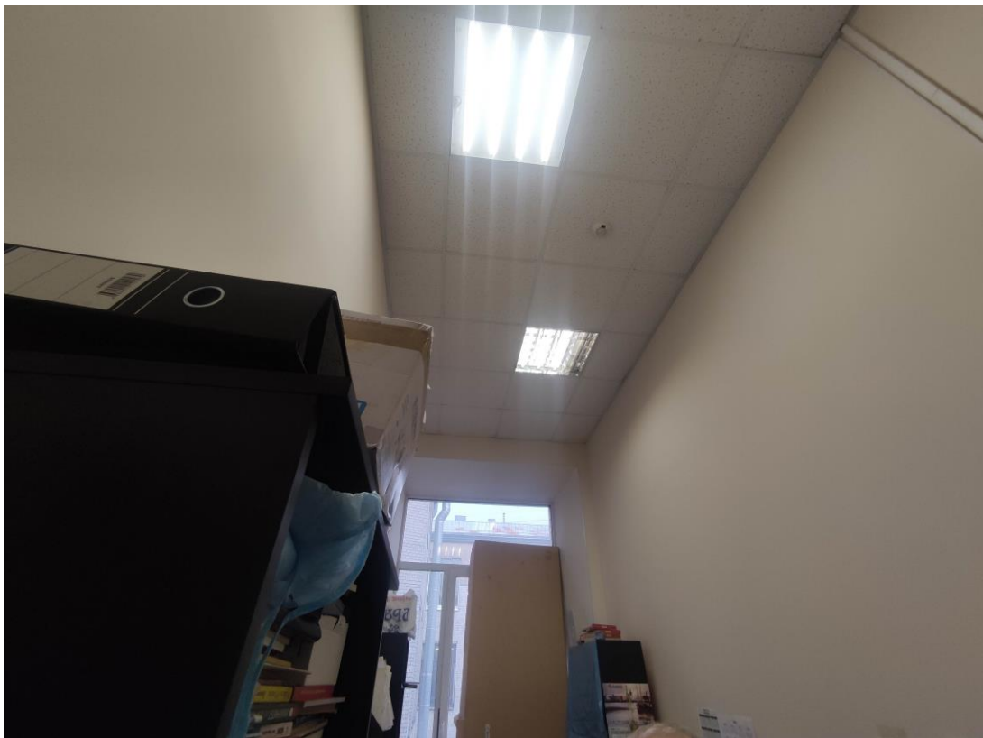
56. Объект культурного наследия регионального значения «Здание Физико-химического института Высших женских (Бестужевских) курсов», расположенный по адресу: г. Санкт-Петербург, Средний проспект В.О., дом 41, литера А. Общий вид пом. № 1-Н(299) флигеля, расположенного вдоль Среднего проспекта В.О.
