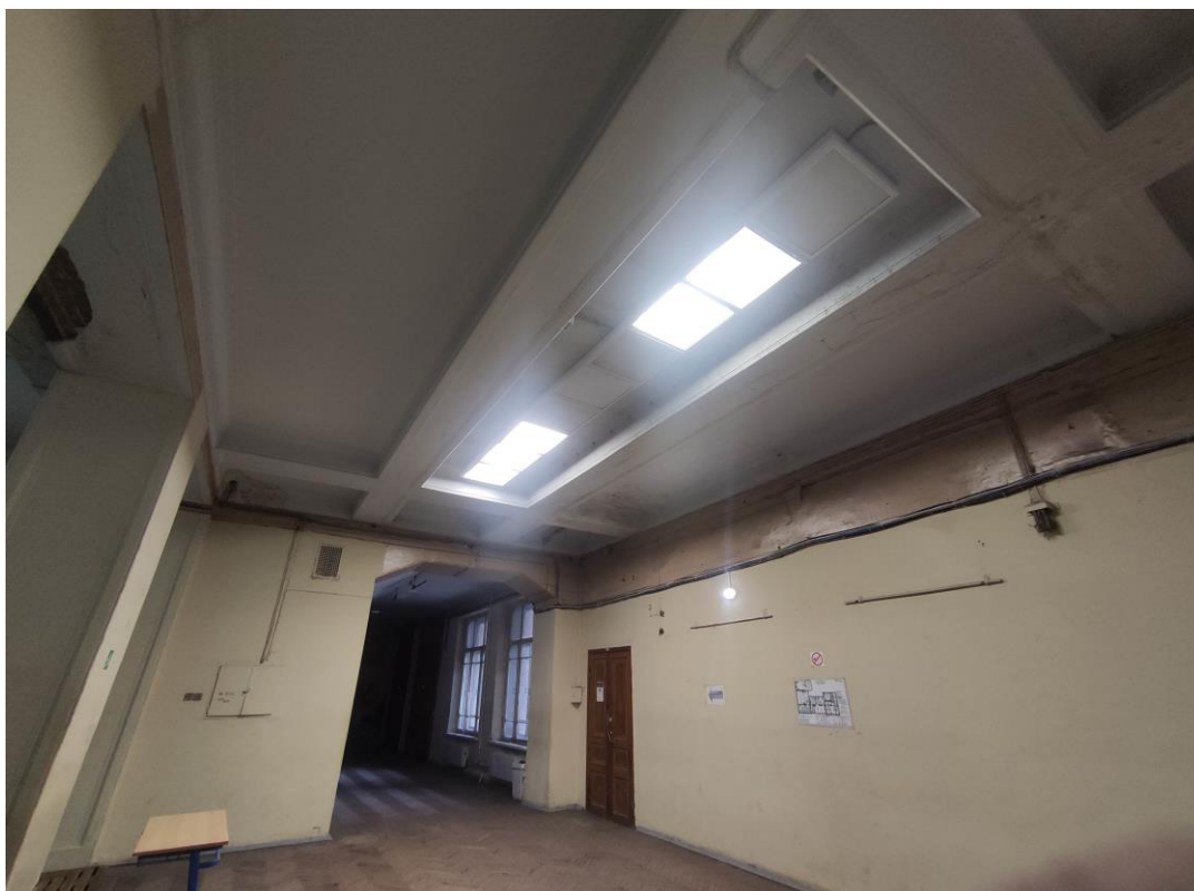
51. Объект культурного наследия регионального значения «Здание Физико-химического института Высших женских (Бестужевских) курсов», расположенный по адресу: г. Санкт-Петербург, Средний проспект В.О., дом 41, литера А. Общий вид пом. № 1-Н(321) главного корпуса.
